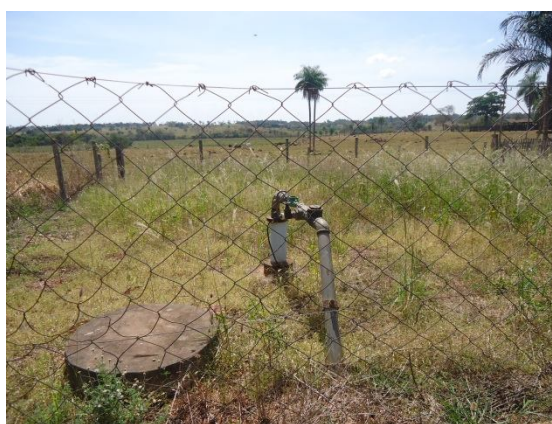
Figura 25 – Poço nº 6 Monte Castelo (desativado)
