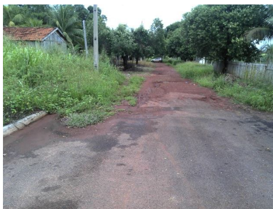
Figura 38 – Assoreamento de via após término do asfalto.
