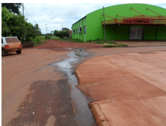
Figura 37 – Escoamento superficial com lançamento na rua não pavimentada.
