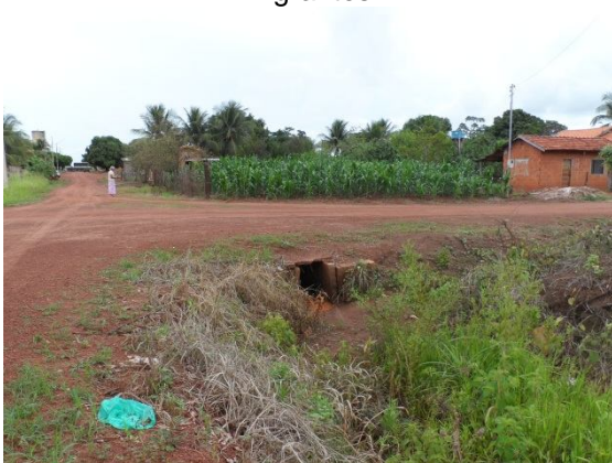
Figura 41 – Bueiro de cruzamento de águas pluviais na Rua João Cardoso
