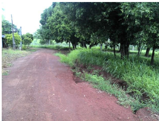
Figura 44 – Assoreamento causado pelas águas pluviais (Monte Castelo).
