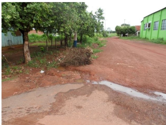
Figura 47 – Início de erosão em via não pavimentada.
