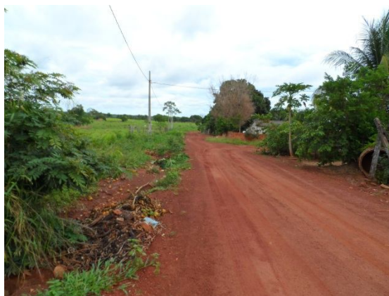
Figura 48 – Erosão em via não pavimentada causada pelo lançamento de águas pluviais sem a dissipação de energia.
