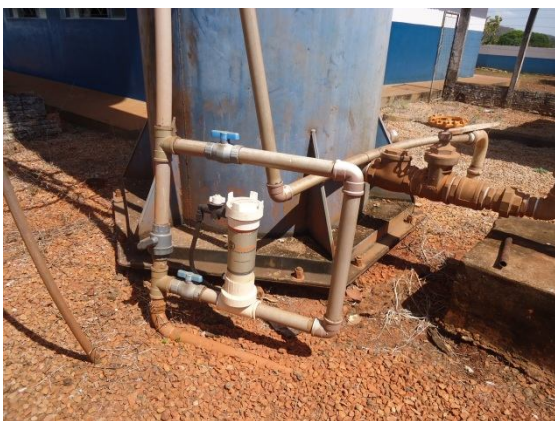
Figura 30 – Clorador - Monte Castelo
