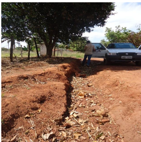
Figura 49 – Erosão causada pelo esc. superficial em Monte Castelo.
