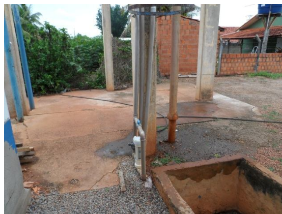
Figura 31 – Clorador - Área urbana
