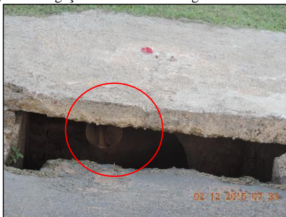
Figura 50. Ligação clandestina de esgoto na boca de lobo
