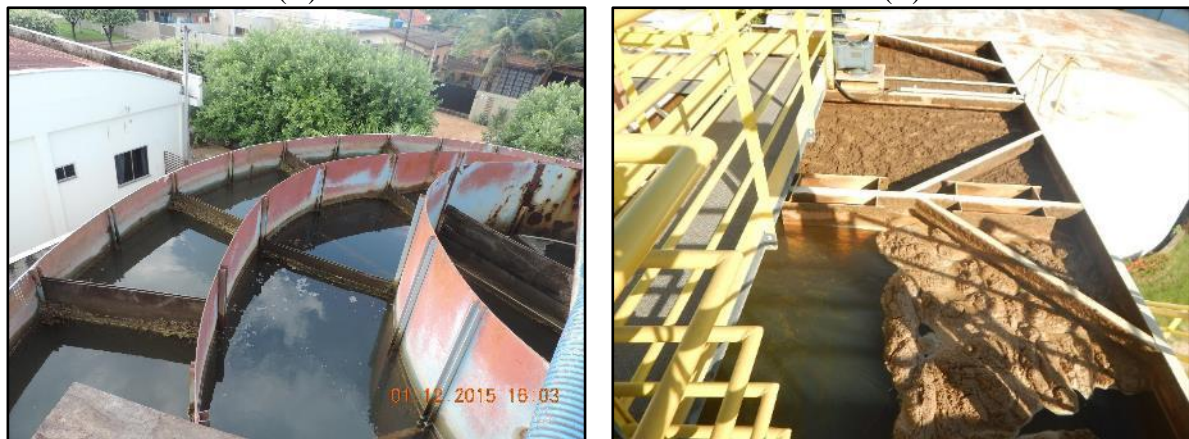
Figura 16. Câmaras de floculação: ETA 1 (A) e ETA 2 (B)
