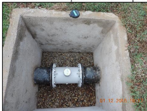
Figura 23. Macromedidor na tubulação de saída da ETA para a distribuição
