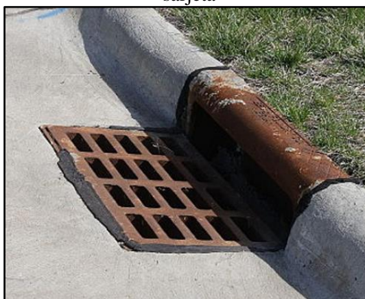
Figura 89. Boca de lobo com gradeamento na sarjeta
