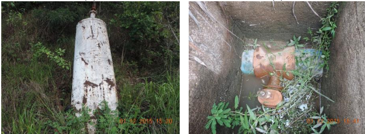
Figura 13. Ventosa (A) e registro de descarga (B) (A) (B)
