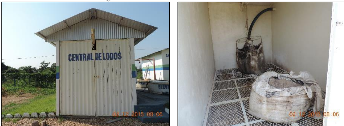
Figura 39. Central de lodos da ETE Central
