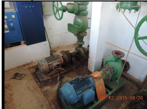
Figura 22. Conjuntos motobomba utilizados para distribuição
