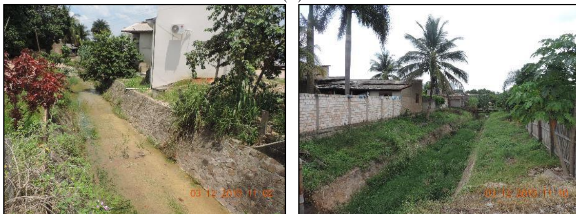
Figura 44. Trecho do canal existente no núcleo urbano de Guarantã do Norte (A)
