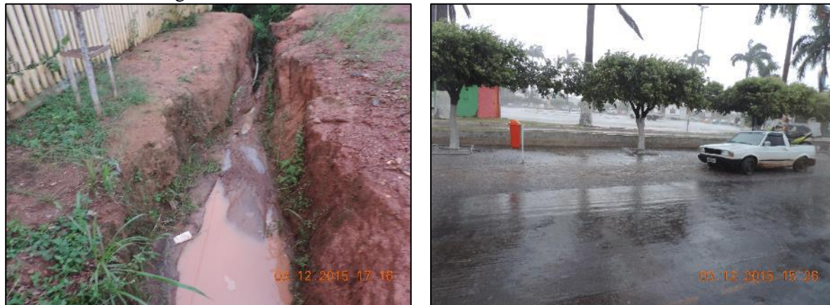
Figura 53. Problemas de erosões e enxurradas no núcleo urbano
