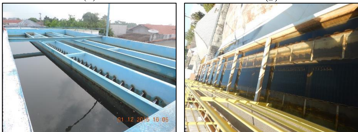
Figura 17. Decantador de alta taxa com placas inclinadas: ETA 1 (A) e ETA 2 (B)
