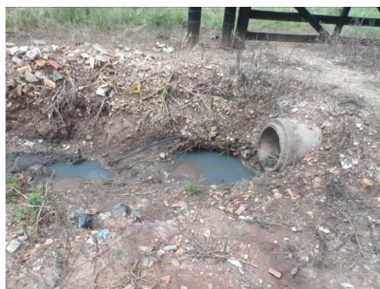
Figura 36 – esgoto a céu aberto
