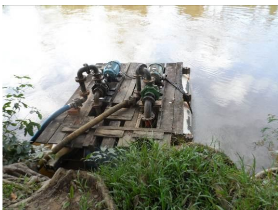
Figura 24 – Captação no Rio Jauru
