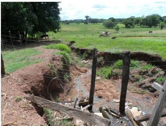
Figura 48 – Erosão em área urbana – fim de drenagem superficial
