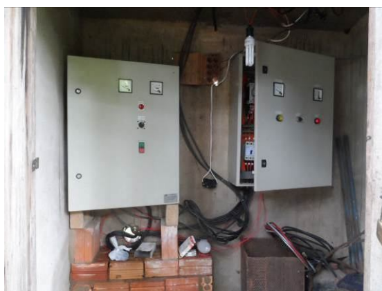
Figura 25 – Quadro de comando
