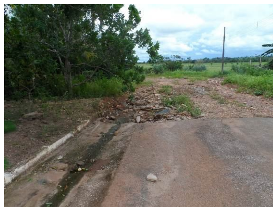
Figura 39 – Escoamento superficial no término de via pavimentada
