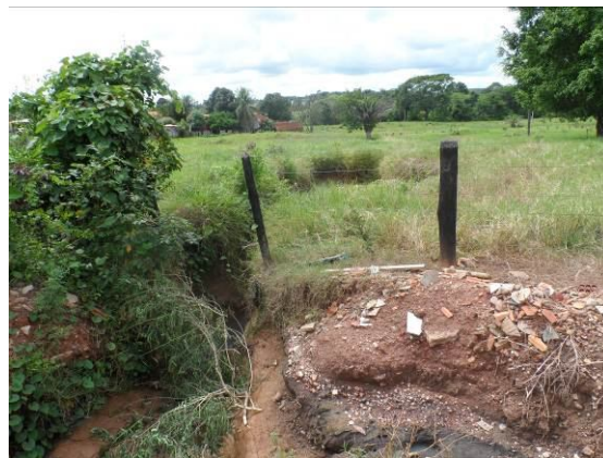
Figura 49 – lançamento de águas pluviais sem a dissipação de energia.
