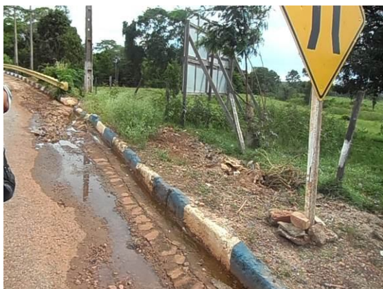
Figura 38 – Escoamento superficial direcionado para o córrego
