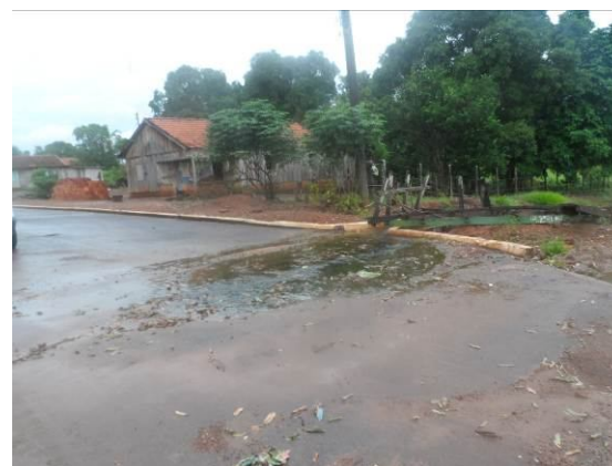
Figura 47 – escoamento de águas pluviais ligada a rede coletora de esgoto
