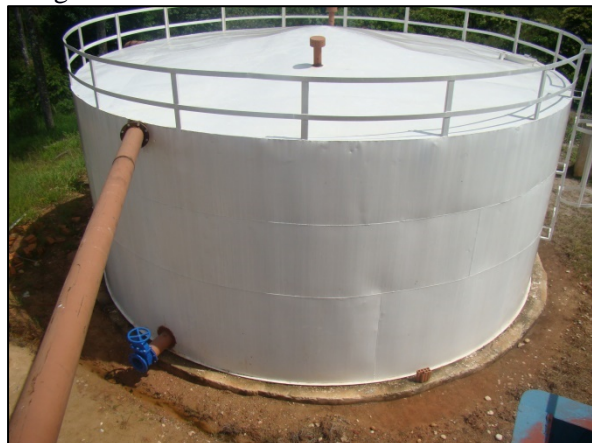
Figura 25. Reservatório fora de funcionamento
