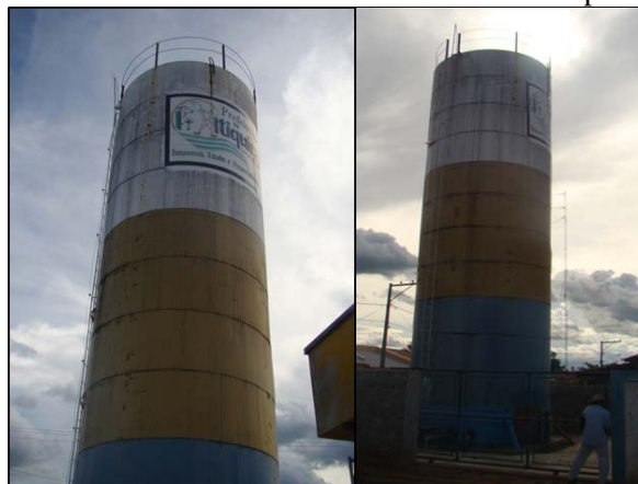
Figura 21. Reservatório elevado cilíndrico metálico com capacidade de 200 m 3
