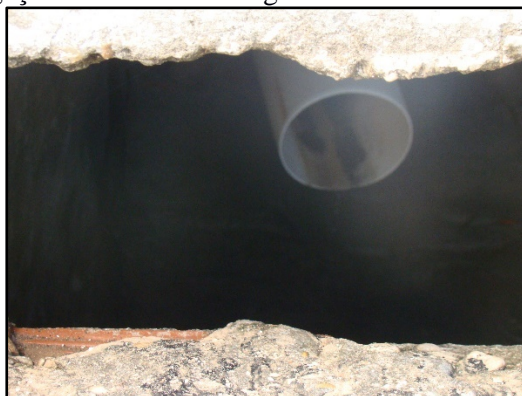
Figura 45. Ligação clandestina de esgoto doméstico em uma boca de lobo
