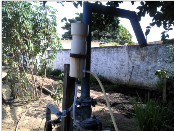
Figura 27. Dosadores de cloro instalados diretamente na saída dos poços artesianos
