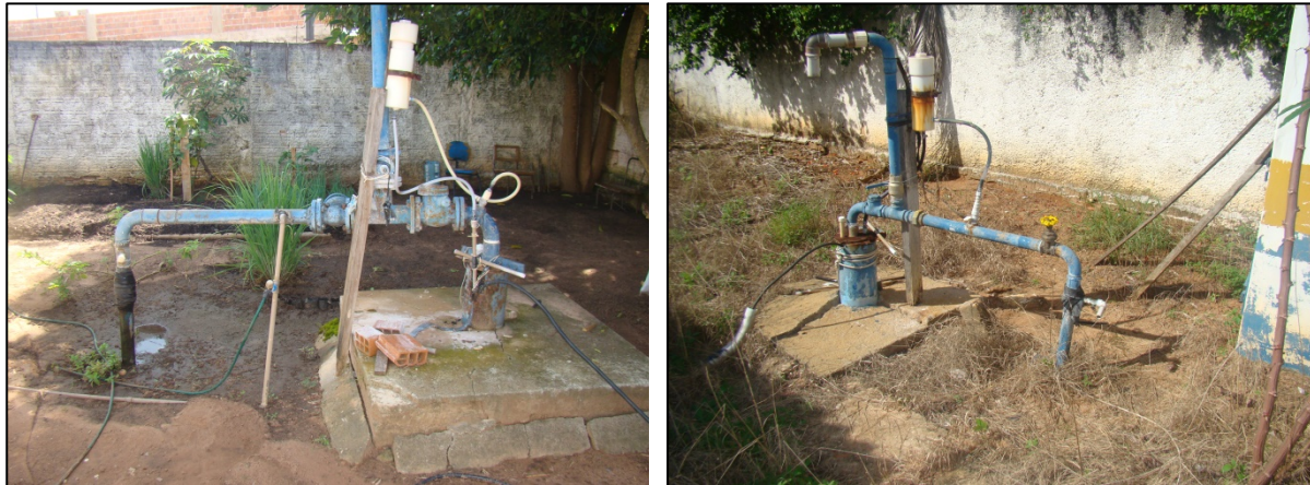
Figura 15. a) Vista Poço Tubular - PTP 01 b) Vista Poço Tubular - PTP 02
