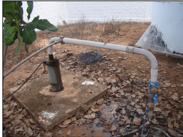
Figura 18. Vista Poço Tubular - PTP 07
