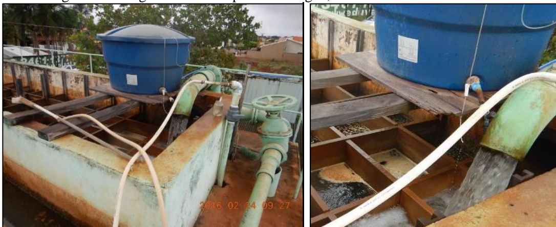
Figura 14. Coagulante sendo aplicado na água, na entrada da ETA de Jaciara
