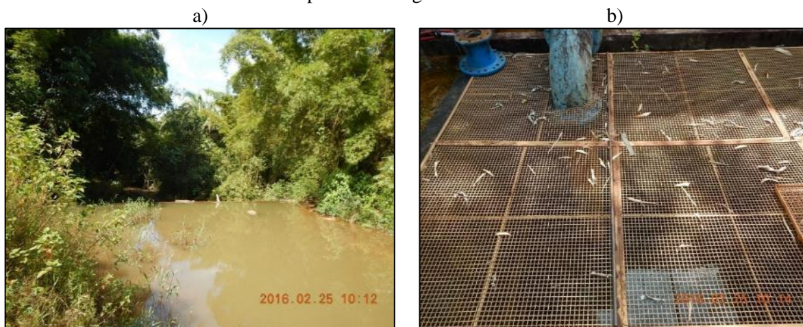
Figura 7. Barragem de nível do Córrego Cachoeirinha (a) e poço de tomada d'água (b) da captação superficial de água de Jaciara
