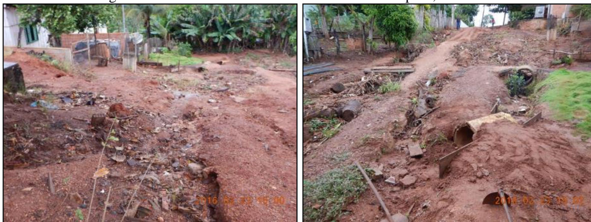
Figura 53. Processos erosivos observados na Rua Irapuru, em Jaciara
