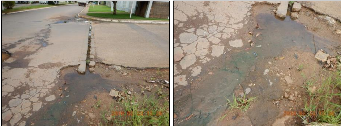
Figura 40. Escoamento de águas residuais pelas vias públicas de Jaciara
