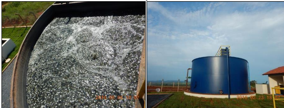
Figura 32. Biomédias agitadas pelo soprador de oxigênio do reator biológico de leito móvel da ETE do bairro Jd. Aeroporto, em Jaciara
