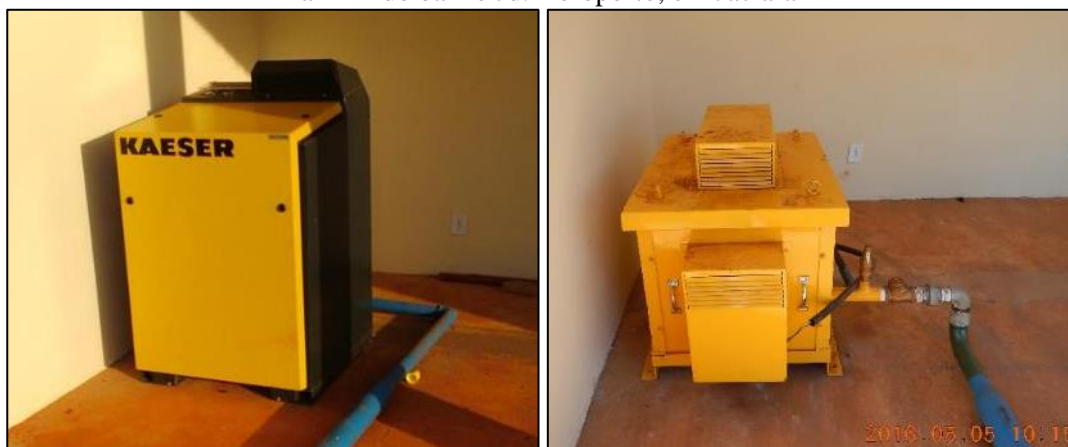
Figura 38. Insuflador de ar utilizado no início de operação e insuflador de ar em operação atualmente na ETE do bairro Jd. Aeroporto, em Jaciara
