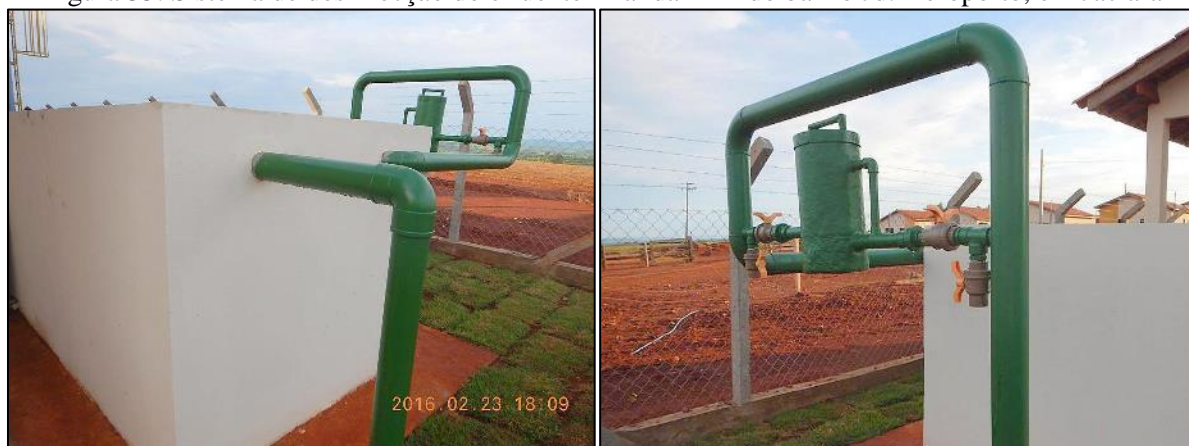
Figura 35. Sistema de desinfecção do efluente final da ETE do bairro Jd. Aeroporto, em Jaciara
