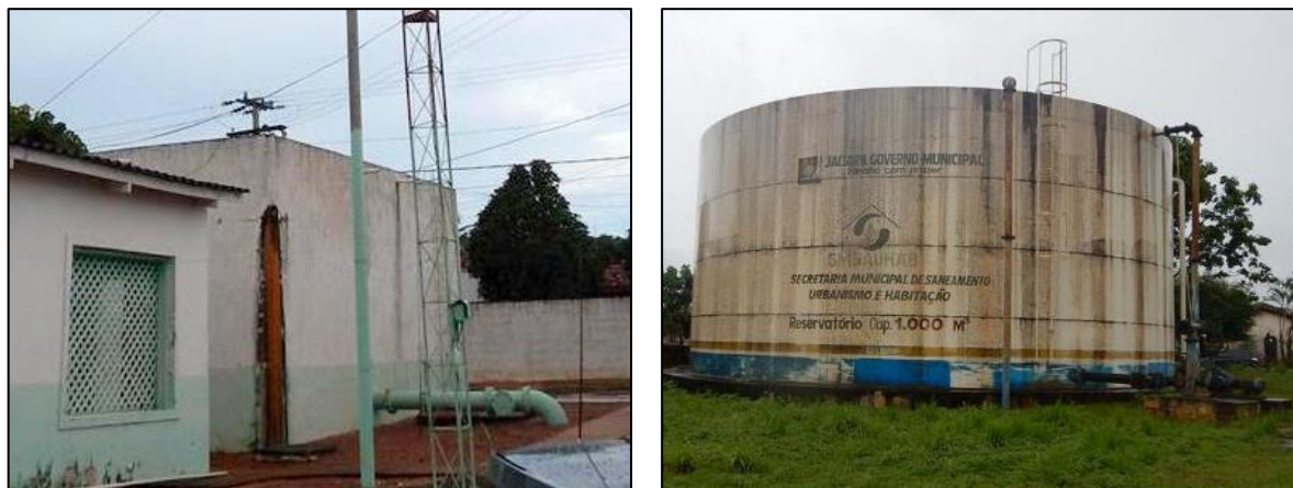
Figura 17. Reservatório de distribuição da sede do DAE (a) e do bairro Vila Planalto (b), em Jaciara
