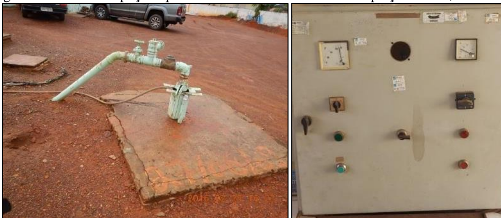
Figura 9. Cavalete do poço e quadro de comando da bomba da captação PT-01, em Jaciara
