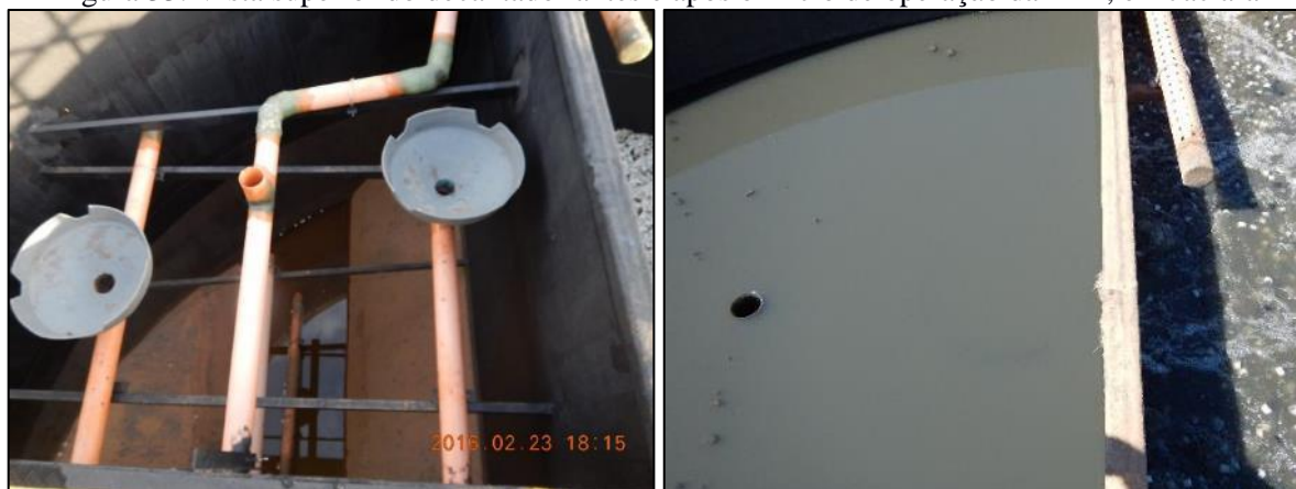
Figura 33. Vista superior do decantador antes e após o início de operação da ETE, em Jaciara
