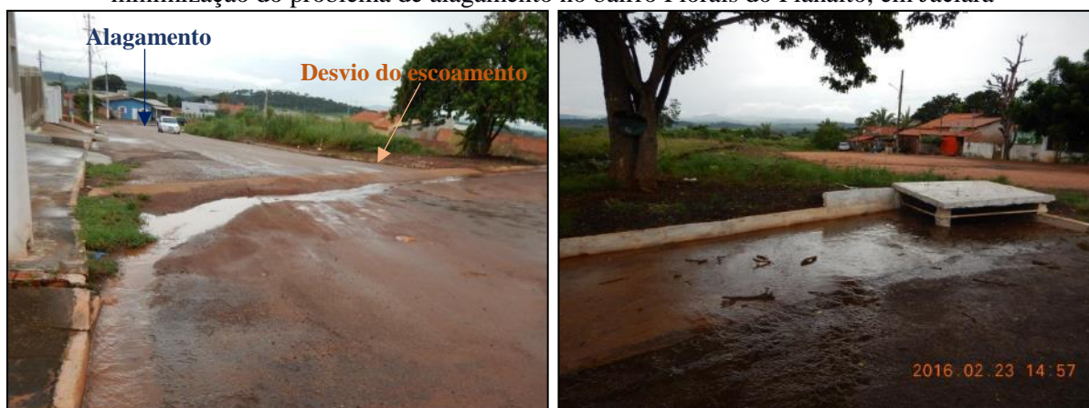
Figura 50. Dispositivos localizados na Rua Irapuru utilizados como medida paliativa para minimização do problema de alagamento no bairro Florais do Planalto, em Jaciara
