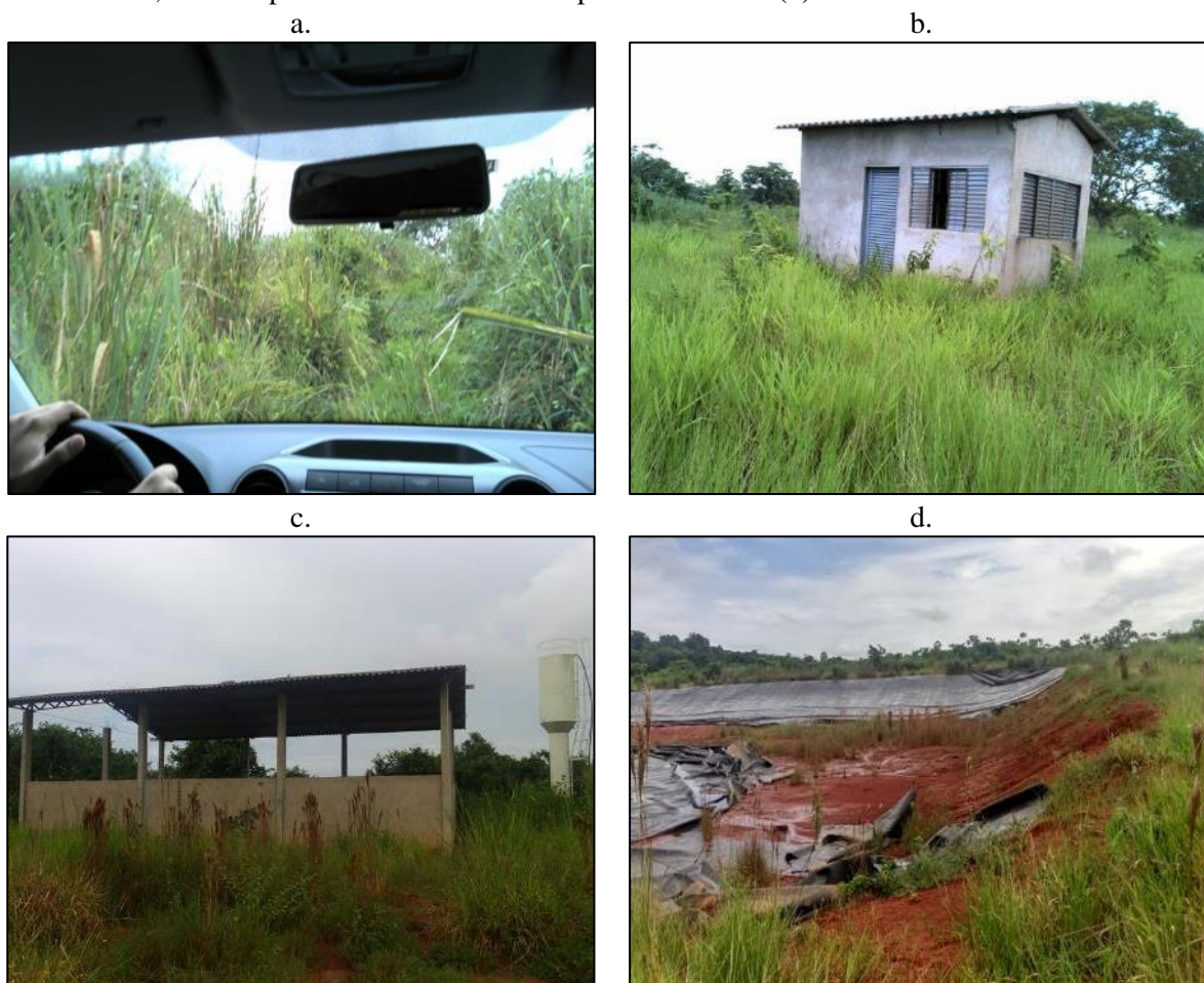
Figura 72. Estrada de acesso (a), guarita (b), unidade de triagem (c) e vala para disposição dos resíduos, com desprendimento da manta impermeabilizante (d) do aterro sanitário de Jaciara
