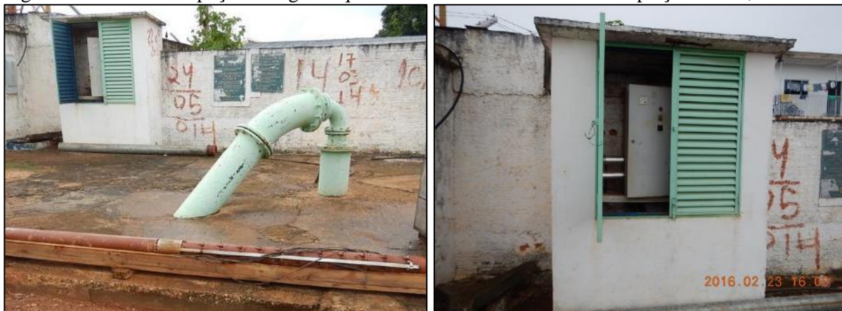
Figura 12. Cavalete do poço e abrigo do quadro de comando da bomba da captação PT-03, em Jaciara
