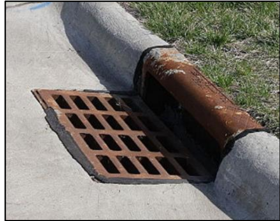
Figura 126. Boca de lobo com gradeamento na sarjeta
