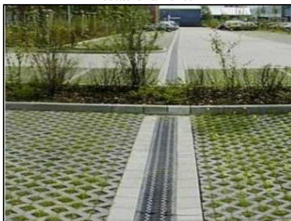
Figura 134. Trincheira de infiltração no estacionamento
