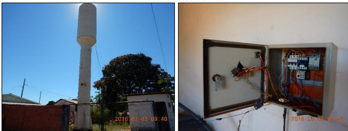
Figura 98. Reservatório de água para abastecimento e abrigo do quadro de comando elétrico, no distrito de Celma
