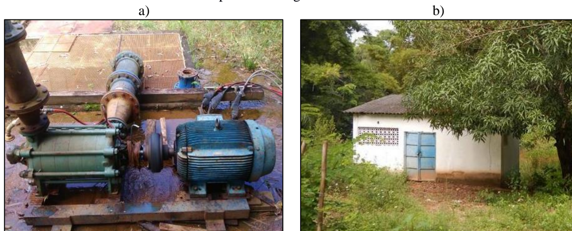
Figura 8. Conjunto motobomba (a) e abrigo do quadro de comando da bomba (b) da captação superficial de água de Jaciara
