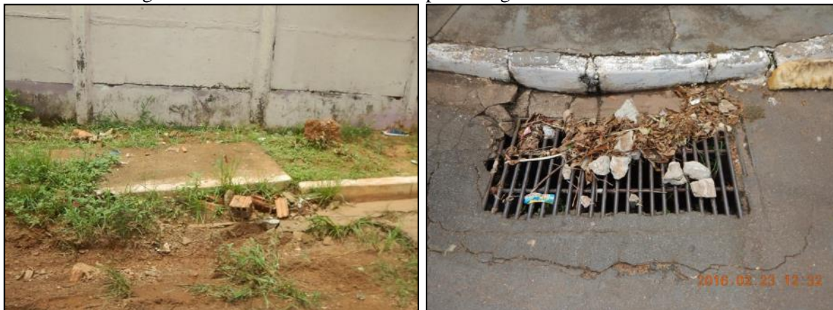
Figura 46. Bocas de lobo obstruídas por folhagens e resíduos em Jaciara
