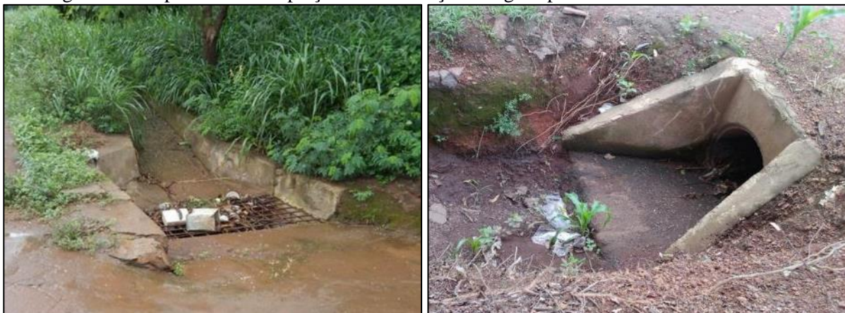
Figura 44. Dispositivos de captação e de condução de águas pluviais da BR-364 em Jaciara
