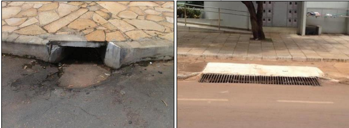
Figura 43. Componentes do sistema de microdrenagem da cidade de Jaciara
