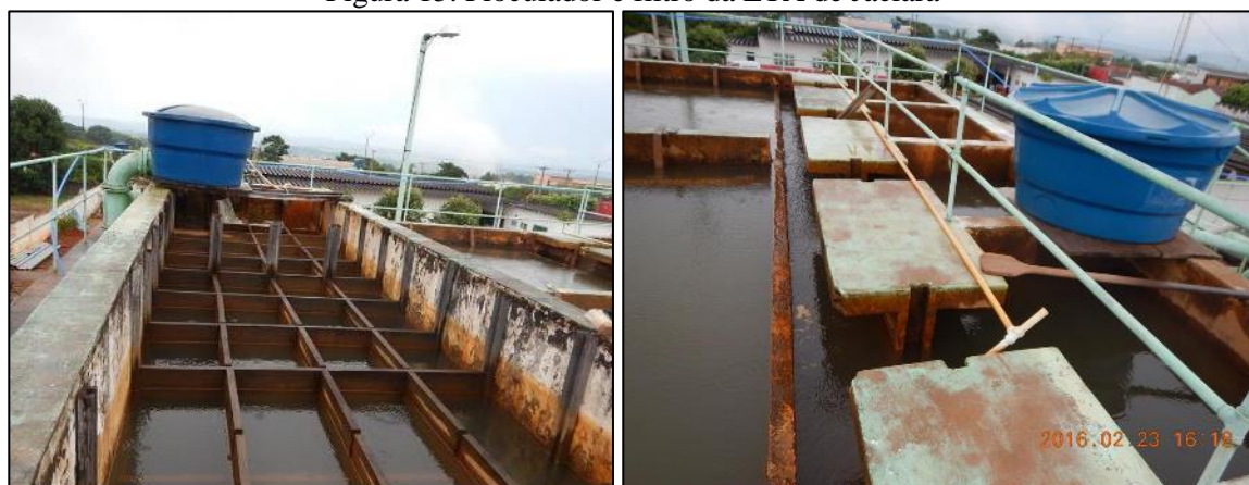
Figura 15. Floculador e filtro da ETA de Jaciara
