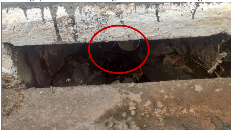
Figura 47. Ligação clandestina de esgoto no sistema de drenagem de Jaciara
