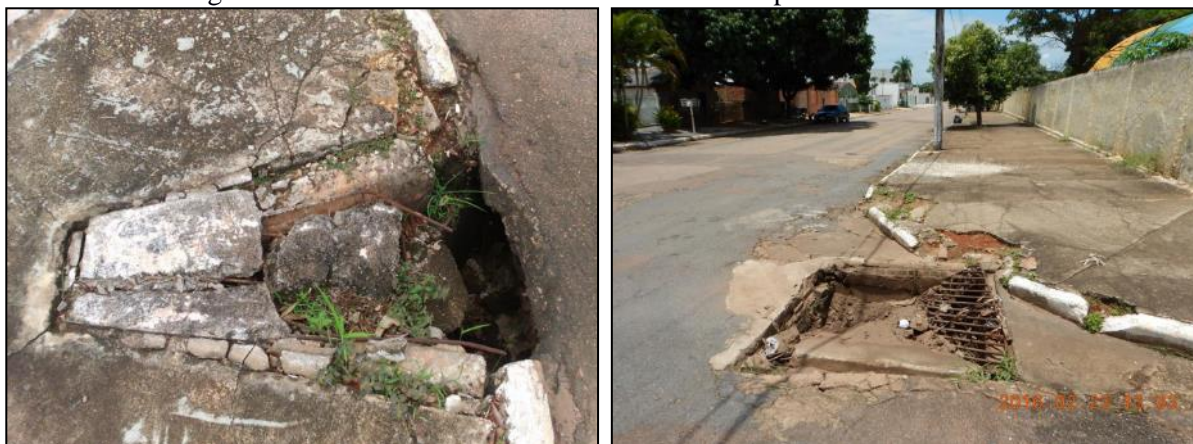
Figura 48. Bocas de lobo com estrutura física comprometida em Jaciara
