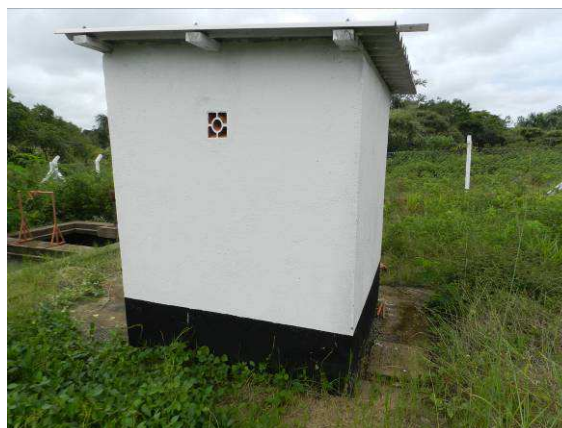
Figura 43 – Abrigo do Quadro de comando da EEE.
