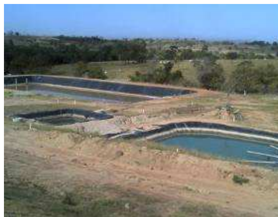
Figura 77 – Sistema de tratamento de chorume do aterro sanitário consorciado.
