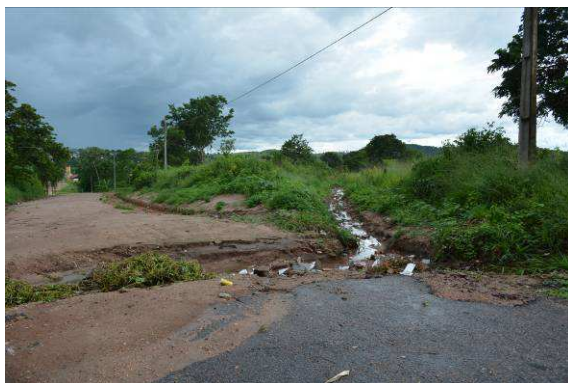
Figura 62 - Início de processo erosivo em via não pavimentada.
