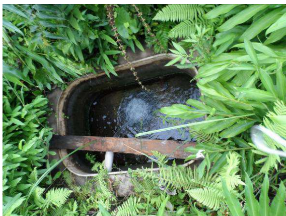
Figura 30 – Mina d'água para abastecimento.
