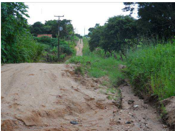
Figura 59 – Via em Altelandia com processos erosivos .
