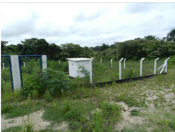
Figura 42 – Vista Geral da Estação Elevatória
