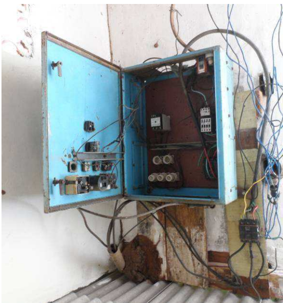
Figura 23 – Quadro de comando existente
