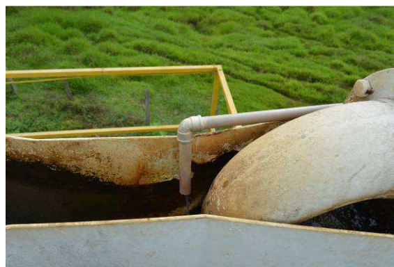
Figura 38 – Ponto de aplicação do coagulante – ressalto hidráulico (calha Parshall).
