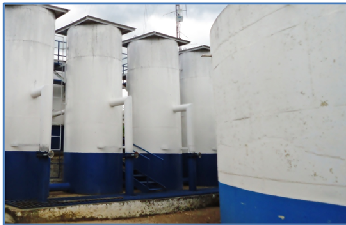
Figura 40: Filtros (fonte: águas de Jauru)
