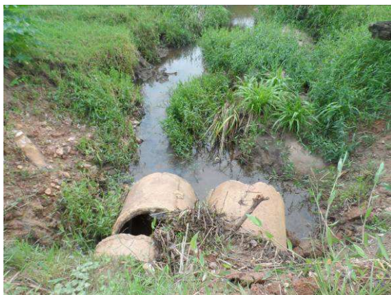
Figura 61 – bueiro danificado em Lucialva com processos erosivos .
