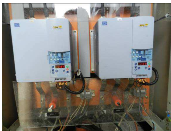
Figura 45 – Sistema “Soft Starter” do quadro de comando..
