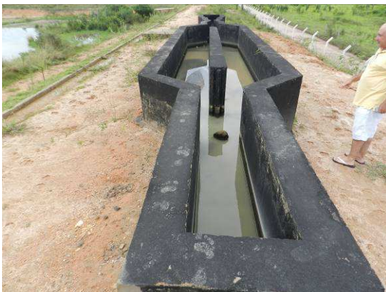
Figura 50 – Chegada do Efluente na ETE, Calha Parshall e desarenador.
