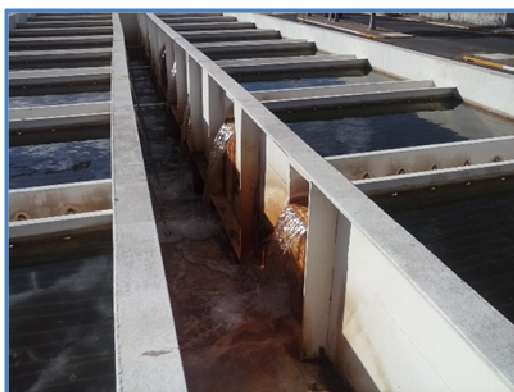
Figura 39: Decantador (FONTE: ÁGUAS DE JAURU)
