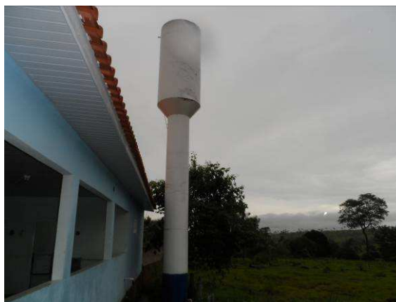
Figura 29 – reservatório tipo Taça.
