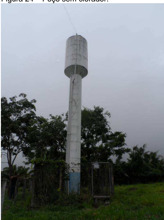
Figura 25 – Reservatório elevado tipo taça
