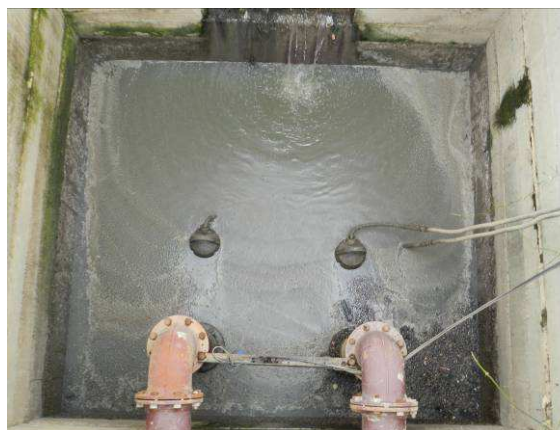
Figura 47 – Poço de Sucção da EEE.
