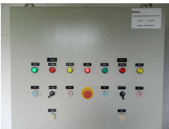
Figura 44 - painel de controle e acionamento da EEE.
