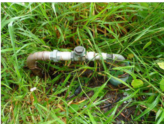
Figura 24 – Poço sem clorador.
