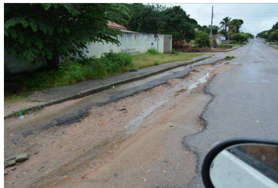
Figura 65 - Erosão em terreno causada por abertura de vala para instalação de rede de esgotamento
