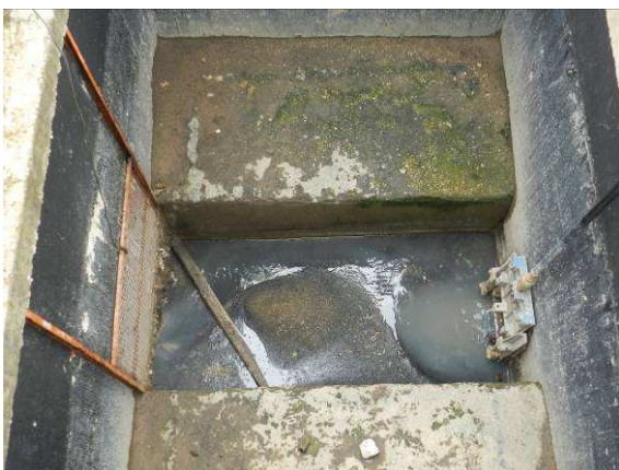
Figura 46 – entrada e gradeamento da EEE.
