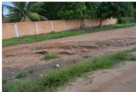
Figura 63 - Erosão em via não pavimentada causada pelo lançamento de águas pluviais sem a dissipação de energia
