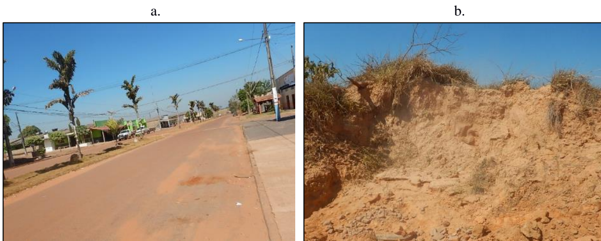
Figura 88. Via não pavimentada (a) e processo erosivos (b), Paranorte, Juara-MT
