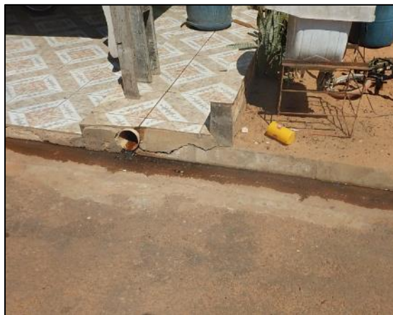
Figura 87. Disposição de efluente de pia e tanque a céu aberto, Paranorte, Juara-MT
