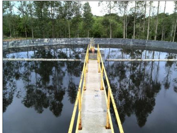
Figura 30. Vista do filtro biológico utilizado para tratamento secundário na ETE de Juara
