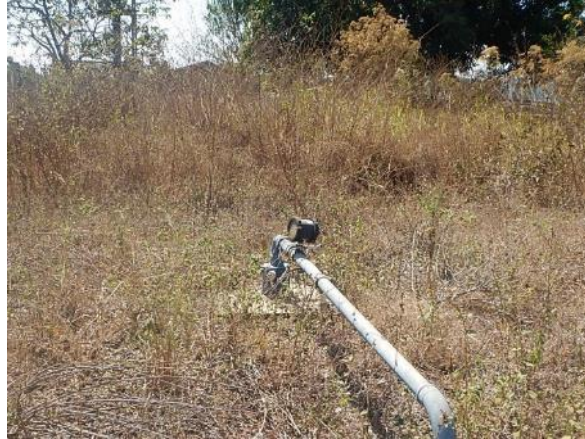
Figura 83. Vista da boca do poço tubular e cavalete P5, Paranorte, Juara-MT
