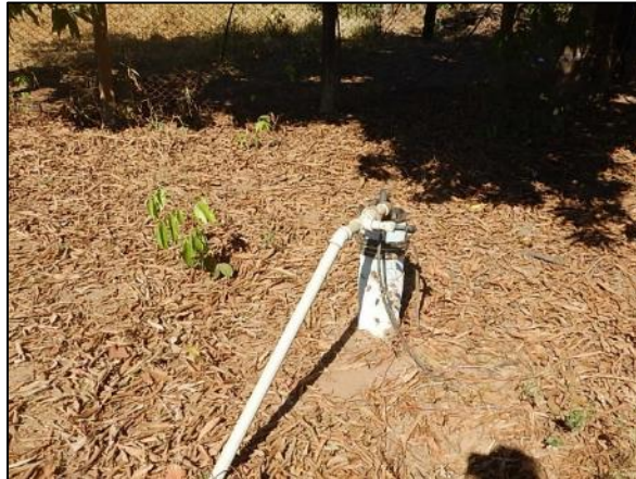
Figura 67. Vista da boca do poço tubular (P2), Águas Claras, Juara-MT
