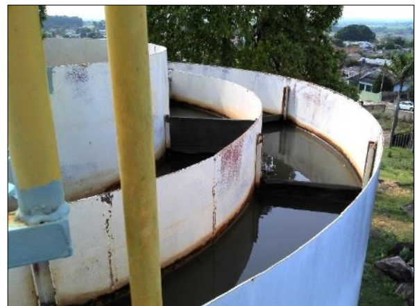
Figura 16. Vista do floculador da ETA metálica
