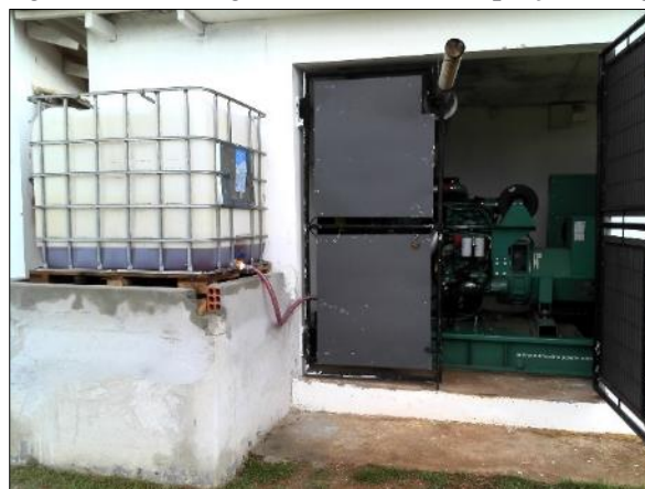
Figura 10. Grupo gerador de energia na unidade de captação de água em Juara-MT
