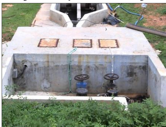
Figura 27. Estações elevatórias de esgoto
