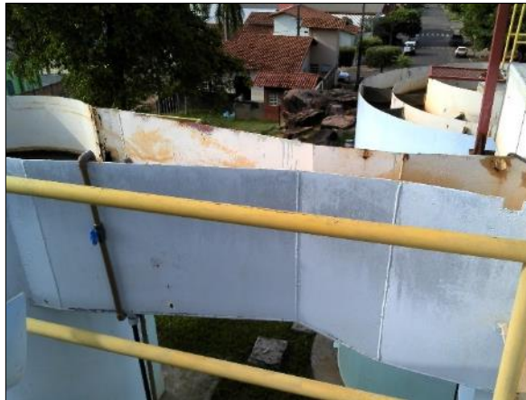
Figura 14. Vista da Calha Parshall ETA metálica
