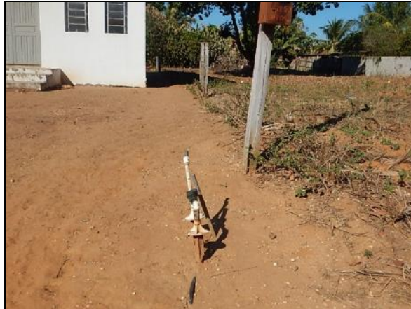
Figura 70. Cavalete com hidrômetro, Águas Claras, Juara-MT
