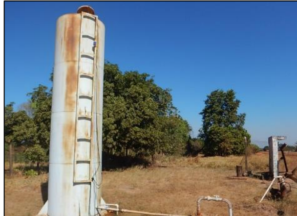
Figura 68. Reservatório (R1), Águas Claras, Juara-MT
