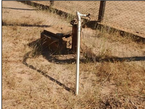
Figura 66. Vista da boca do poço tubular (P1), Águas Claras, Juara-MT
