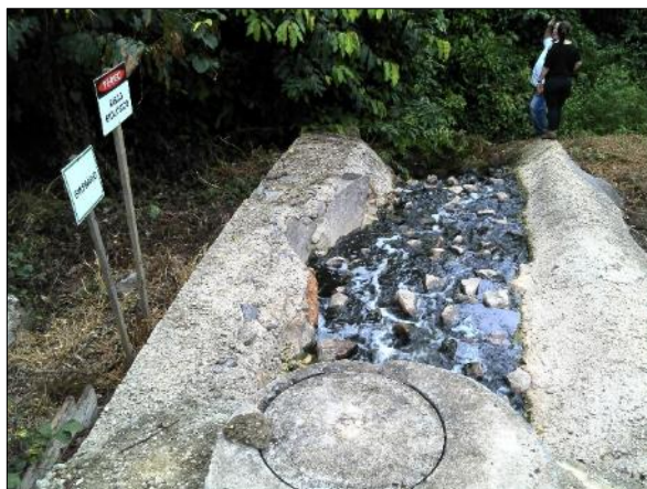
Figura 32. Vista do emissário de efluente tratado no córrego dos Saltos
