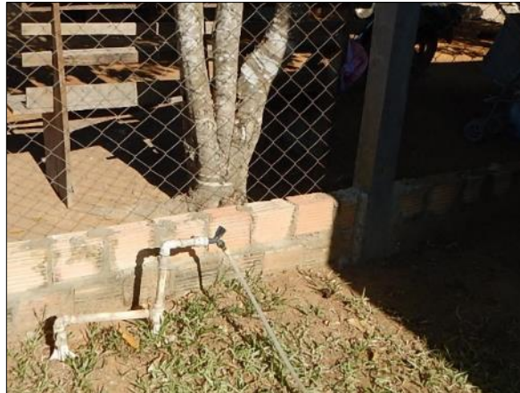
Figura 97. Cavalete sem hidrômetro, Jaú, Juara-MT
