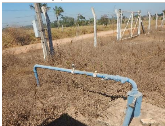
Figura 82: Vista da boca do poço tubular e cavalete P4, Paranorte, Juara-MT
