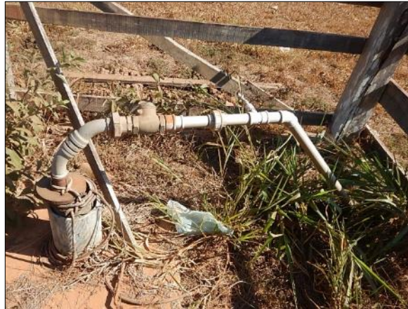
Figura 81. Vista da boca do poço tubular e cavalete P3, Paranorte, Juara-MT
