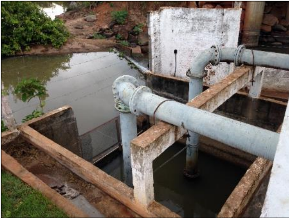
Figura 8. Captação no córrego Alcebíades
