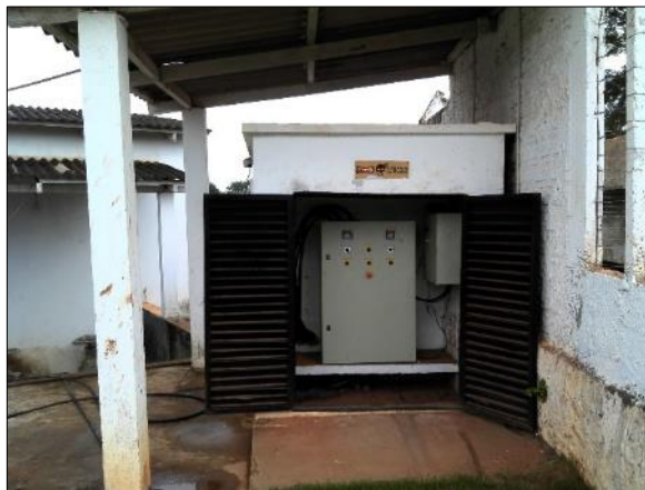
Figura 11. Quadro de comando do sistema de captação
