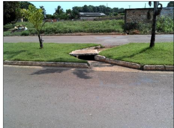
Figura 40. Boca de lobo na Av. Rio Grande do Sul apresenta bom estado de conservação
