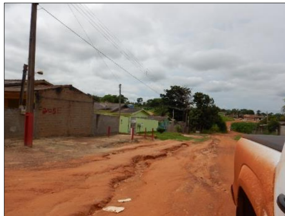
Figura 44. Processo erosivo na Rua Boa Vista
