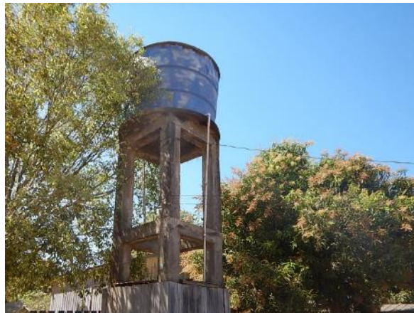
Figura 125. Reservatório elevado, Projeto Casulo, Juara-MT
