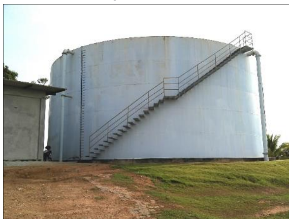
Figura 24. Vista do Reservatório RP 2 em aço galvanizado
