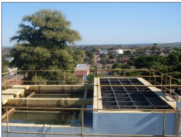
Figura 15. Vista da dos floculadores das ETAs de Concreto
