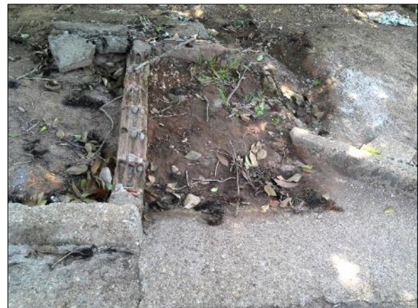
Figura 42. Boca de lobo na Rua Porto Velho totalmente obstruída com terra
