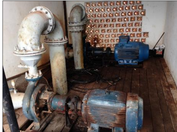
Figura 9. Bombas utilizadas na captação de água
