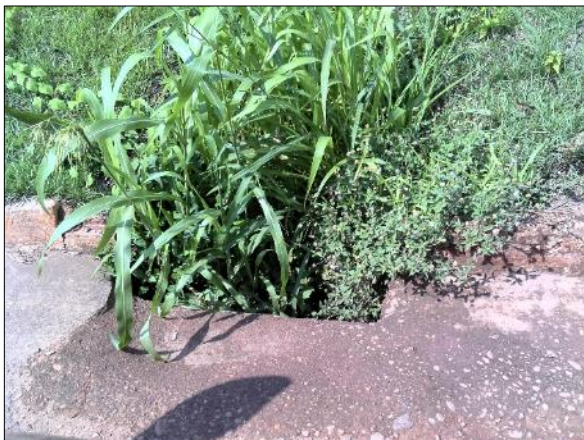
Figura 41. Boca de lobo na Av. Rio Grande do Sul danificada e sem manutenção
