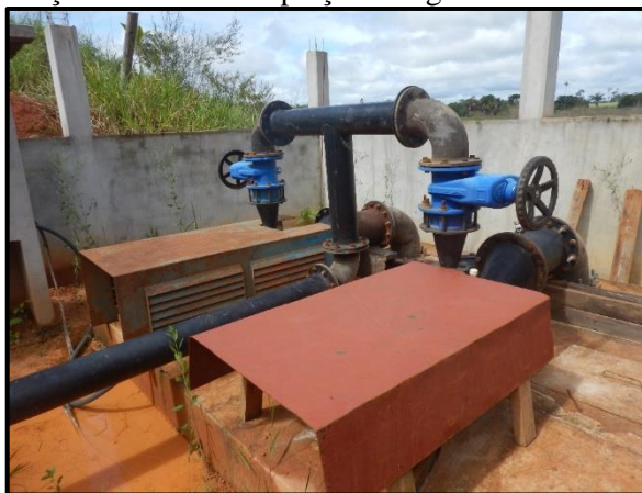
Figura 7. Instalações da área de captação de água bruta no córrego da Rocha
