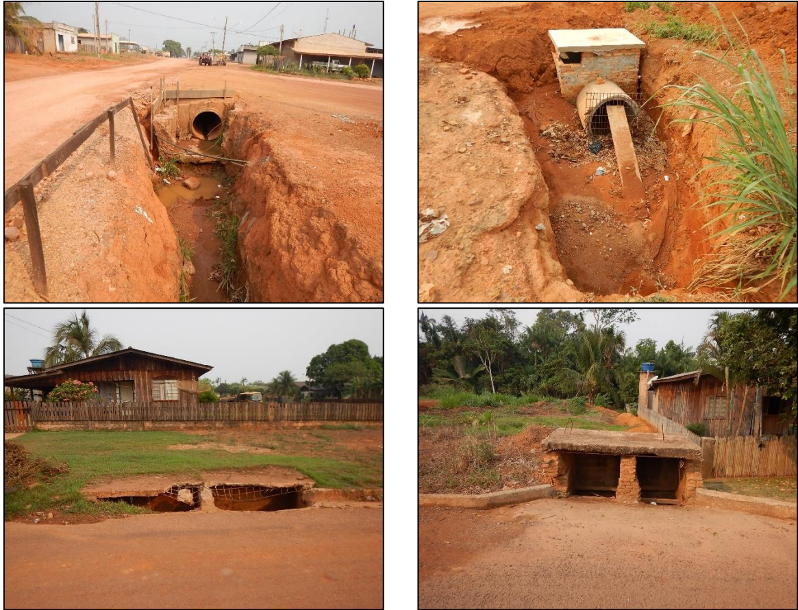
Figura 21. Problemas em componentes da rede de microdrenagem de Juruena-MT
