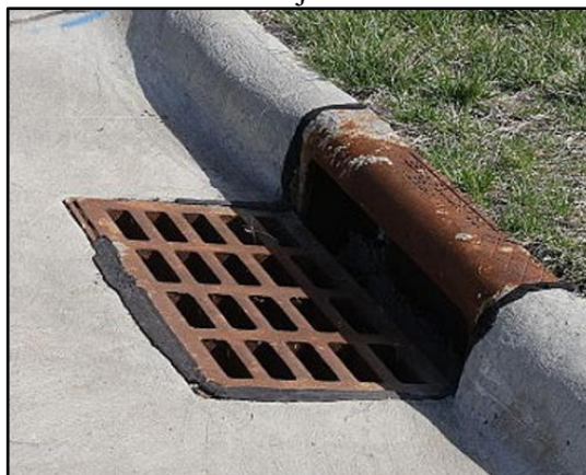
Figura 92. Boca de lobo com gradeamento na sarjeta
