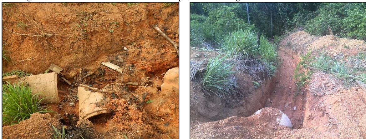
Figura 20. Erosão e local com falta de dissipadores de energia observados em Jurueña-MT
