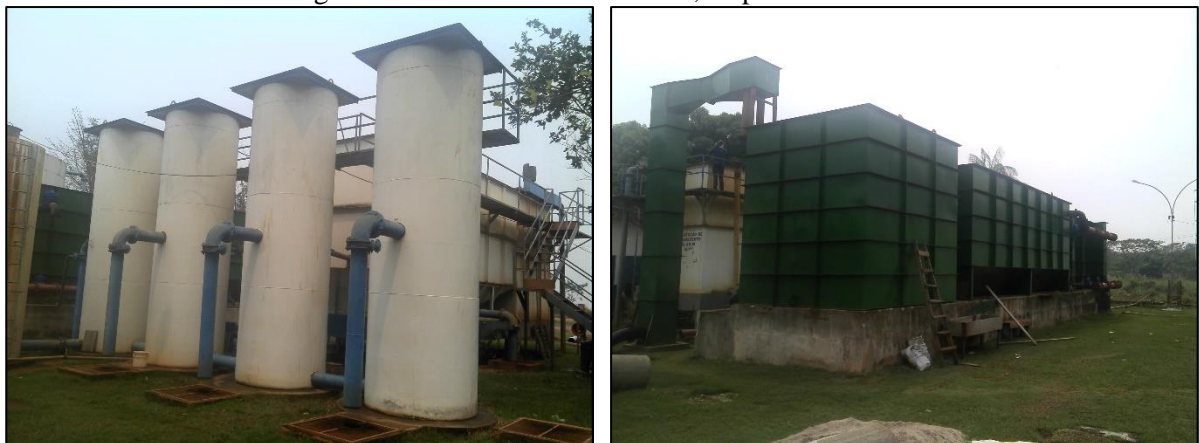
Figura 9. Vista da ETA 1 e ETA 2, respectivamente
