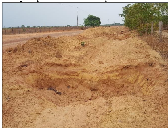
Figura 63. Bacias de detenção e infiltração de águas pluviais executadas precariamente
