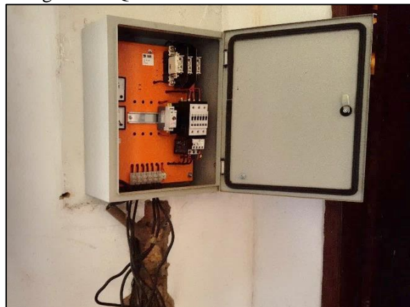
Figura 13. Quadro de comando do PT-Centro
