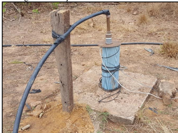
Figura 56. Poço tubular da Doze de Junho
