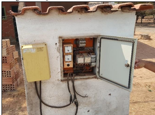
Figura 12. Quadro de comando do PT-Cohab
