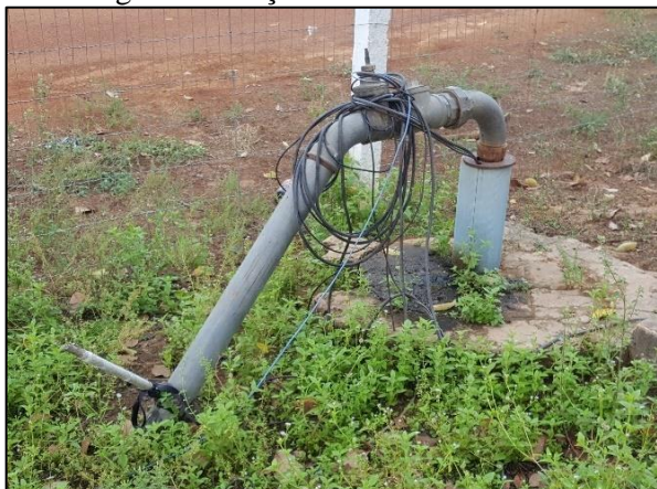
Figura 55. Poço tubular de São Bento
