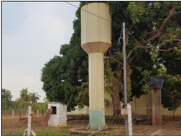
Figura 59. Reservatório de 10 m 3 da comunidade São Bento
