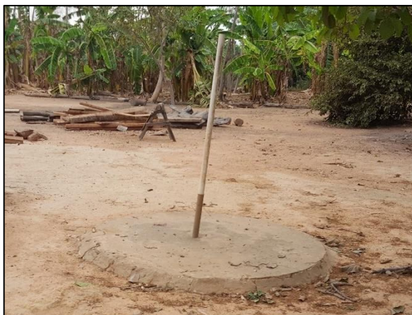
Figura 61. Fossa rudimentar na comunidade Doze de Junho
