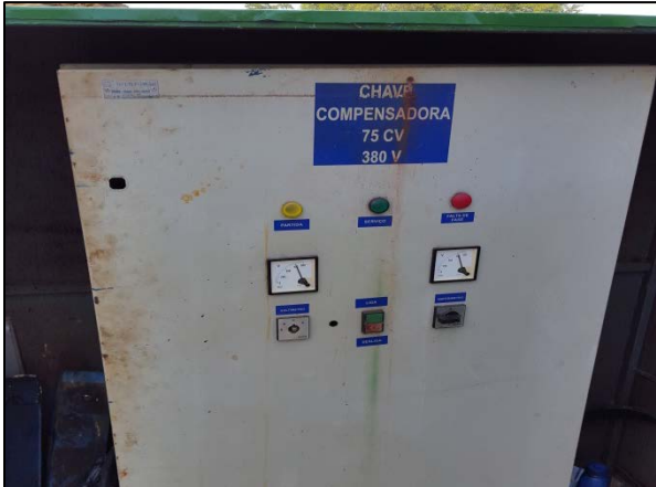
Figura 21. Painel do quadro de comando da captação
