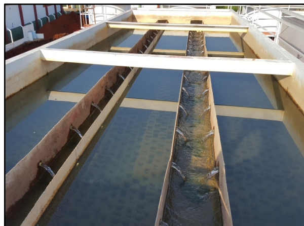
Figura 28. Decantador de alta taxa com placas inclinadas tipo colmeia
