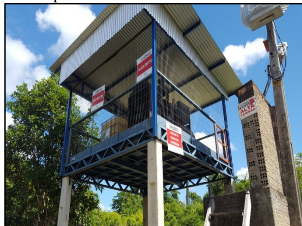
Figura 23. Gerador de energia na captação superficial no rio Peixoto de Azevedo.
