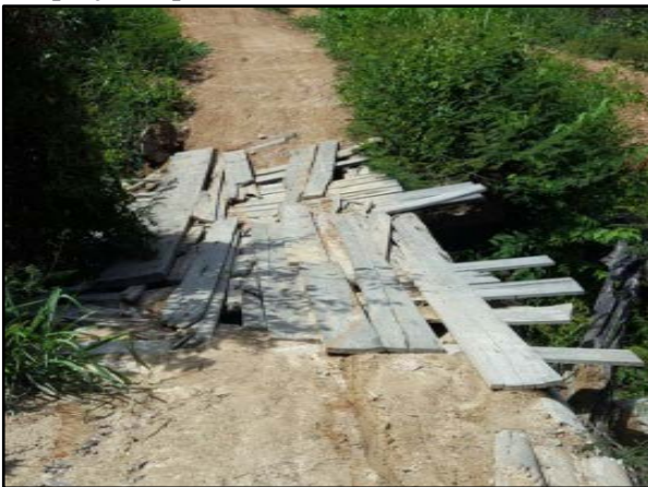
Figura 16. Ponte em estado precário para acesso à captação superficial no rio Peixoto de Azevedo
