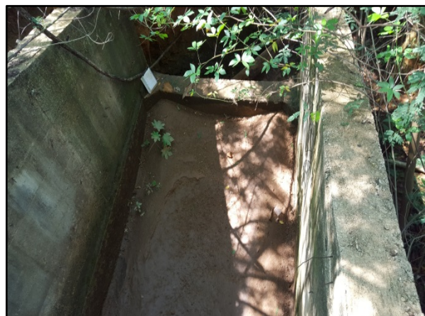
Figura 57. Dissipador de energia assoreado
