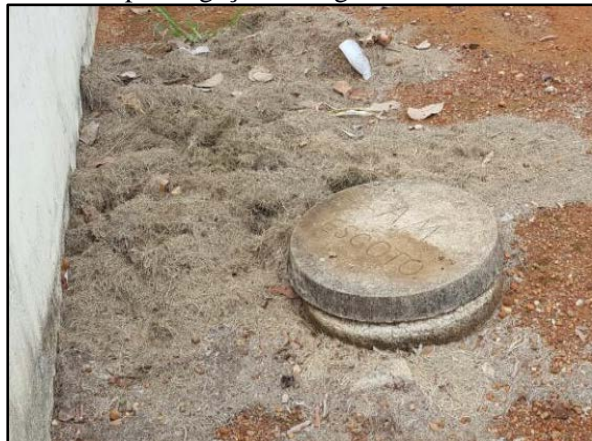
Figura 47. Tampa da caixa de inspeção na calçada no Bairro União para ligação de esgoto do domicílio na rede.
