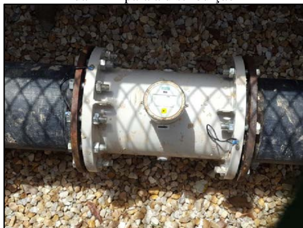
Figura 37. Macromedidor na tubulação de saída da ETA para a distribuição
