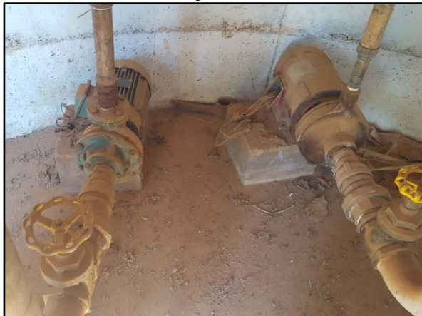
Figura 10. Conjuntos motobombas instalados na base do reservatório apoiado de concreto inativo
