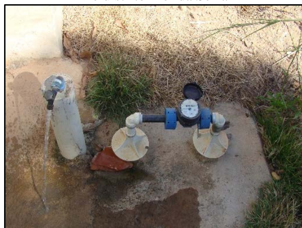
Figura 116. Hidrômetro em uma ligação predial no distrito Flor da Serra
