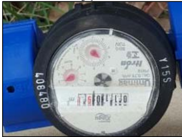
Figura 38. Hidrômetro novo instalado em 2015 em uma ligação domiciliar
