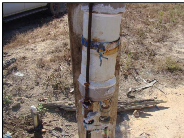
Figura 112. Clorador de contato do distrito Flor da Serra
