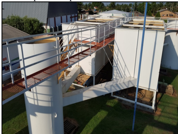
Figura 24. ETA metálica da sede urbana de Matupá com capacidade nominal de 50 L/s
