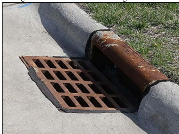
Figura 157. Boca de lobo com gradeamento
