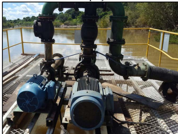
Figura 15. Conjuntos motobombas em operação na captação
