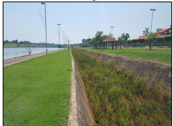
Figura 53. Canal de drenagem paralelo à Av. Interlagos
