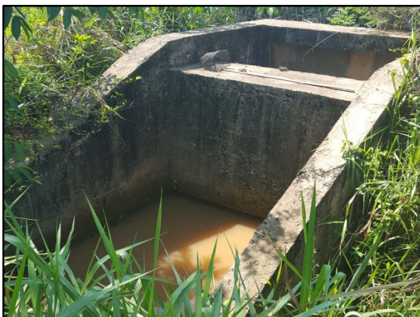
Figura 48. Dissipador de impacto próximo à Rua 21 no bairro Jardim das Flores
