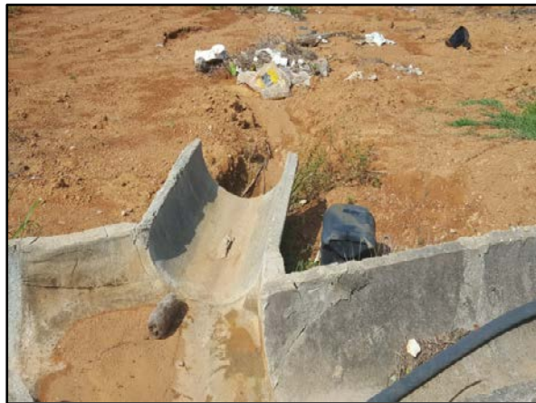
Figura 72. Formação de erosão no desague da canaleta ao redor da célula do aterro
