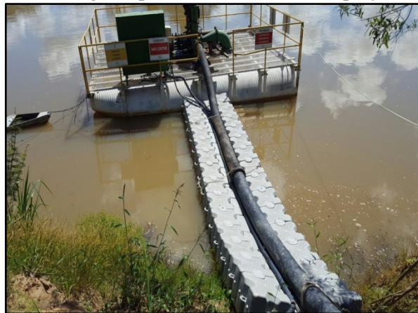
Figura 17. Flutuadores com superfície escorregadia para acesso à balsa da captação
