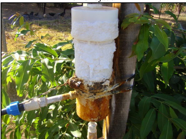
Figura 111. Clorador de contato do distrito Alto Alegre com incrustações na superfície e suporte enferrujado
