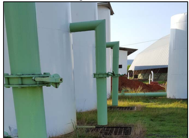
Figura 30. Tubulação para descarte da água de lavagem do filtro
