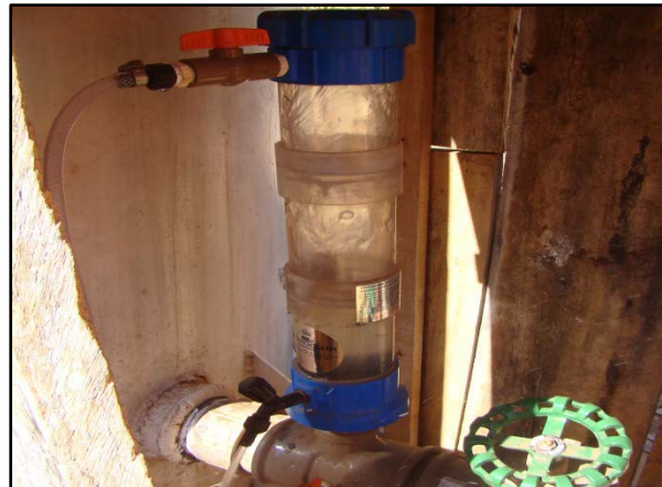
Figura 121. Clorador de contato inoperante após o filtro de areia
