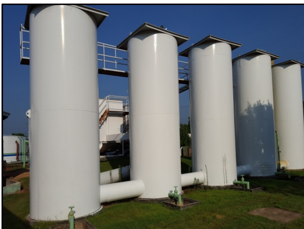
Figura 27. Tanques de floculação do tipo hidráulico de fluxo vertical com chicanas internas
