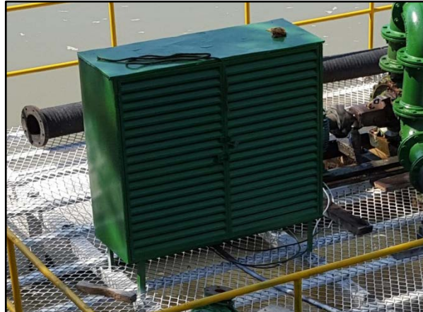
Figura 22. Abrigo do quadro de comando fixado na balsa da captação
