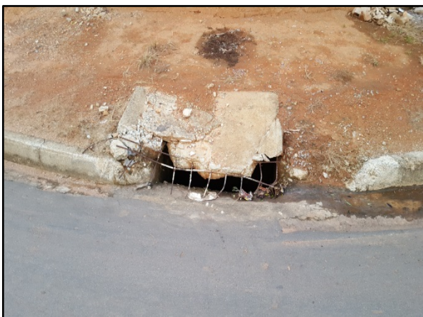
Figura 56. Boca de lobo com tampa danificada na Rua 15 H-3 no bairro Jardim das Flores
