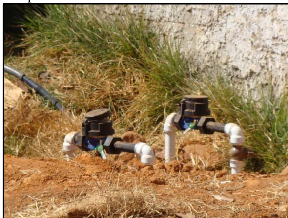
Figura 126. Hidrômetros instalados em ligações prediais na comunidade de Santo Antônio
