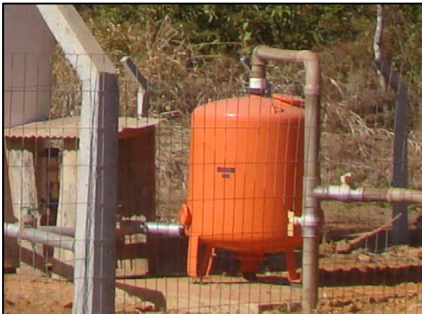
Figura 120. Filtro de areia para tratamento da água da comunidade de Santo Antônio
