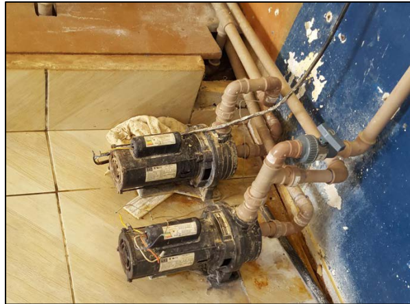
Figura 33. Bombas dosadoras das soluções de sulfato de alumínio e hipoclorito de cálcio
