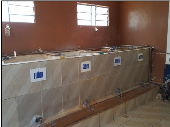
Figura 32. Tanque de preparo das soluções de sulfato de alumínio, hipoclorito de cálcio e fluorssilicato de sódio
