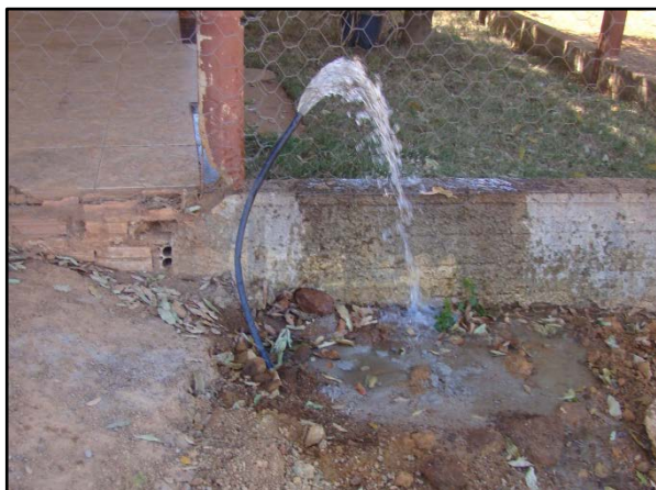
Figura 125. Rede de distribuição de mangueira PEAD vazando na comunidade de Santo Antônio
