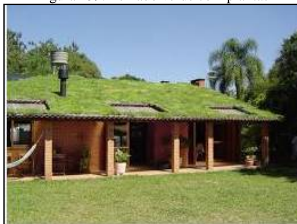
Figura 159. Telhado verde com plantas
