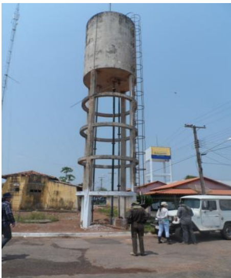
Figura 50 – Reservatório elevado Cohab Juruena
