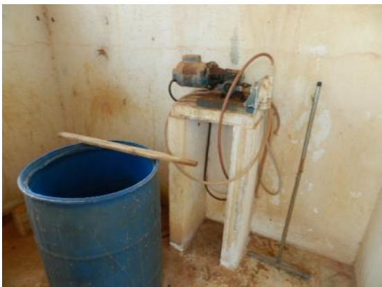
Figura 89 – Bomba dosadora de cloro queimada
