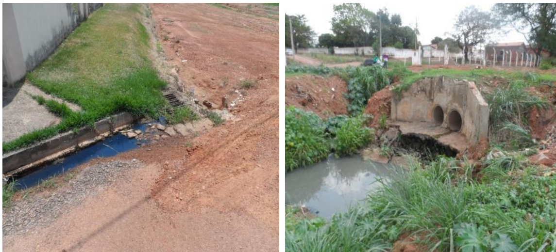
Figura 105 - Lançamento de esgoto na rede de águas pluviais.
