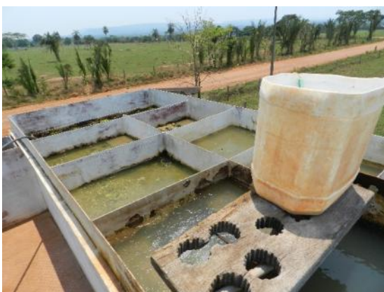
Figura 85 – Dosador improvisado de sulfato de alumínio
