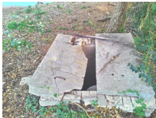
Figura 102 – Caixa de passagem na ETE danificada
