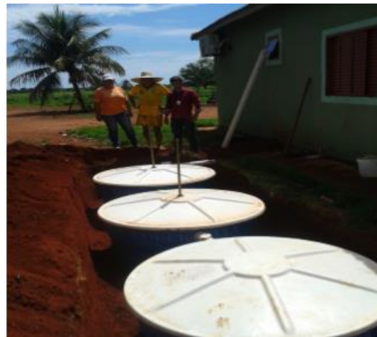
Figura 104 – Kit biofossa instalado
