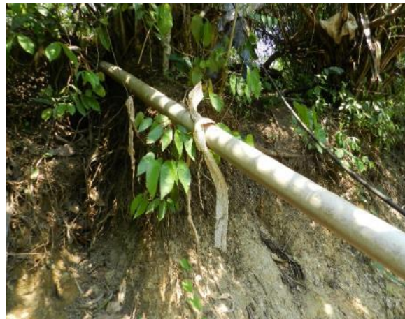
Figura 84 – Adutora água bruta
