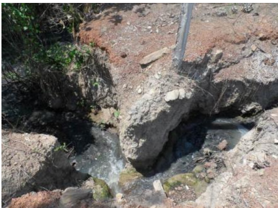
Figura 113 - Erosão em em beira de córrego pela extravazação de E.E.E.
