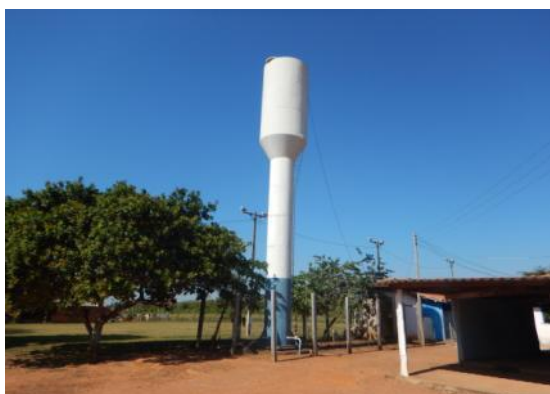
Figura 62 – Poço 1 e reservatório 1, ao lado da igreja católica
