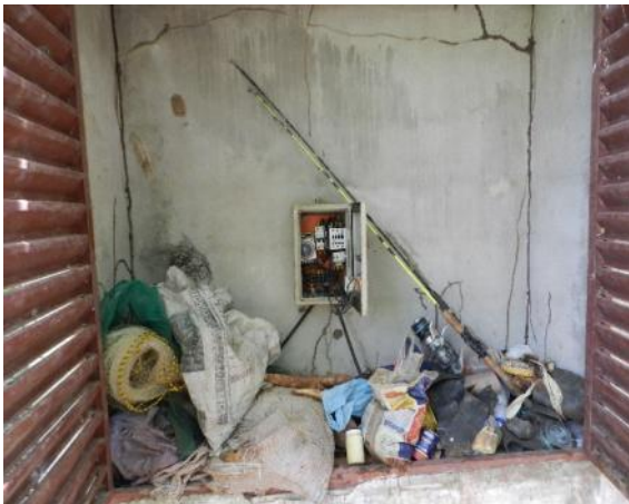
Figura 83 – Painel de comando
