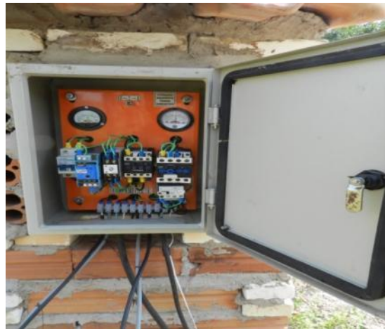
Figura 78 – Painel de comando do poço
