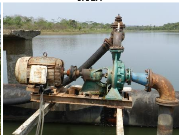
Figura 38– Bombeamento Represa Carnaíba
