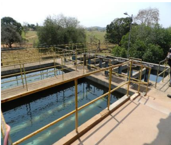
Figura 44 – ETA decantação e filtração.
