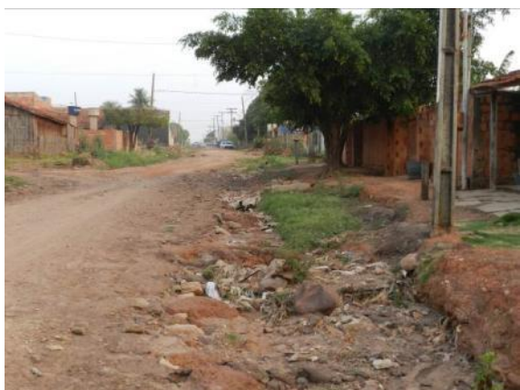
Figura 111 - Início de erosão em via não pavimentada com declividade acentuada
