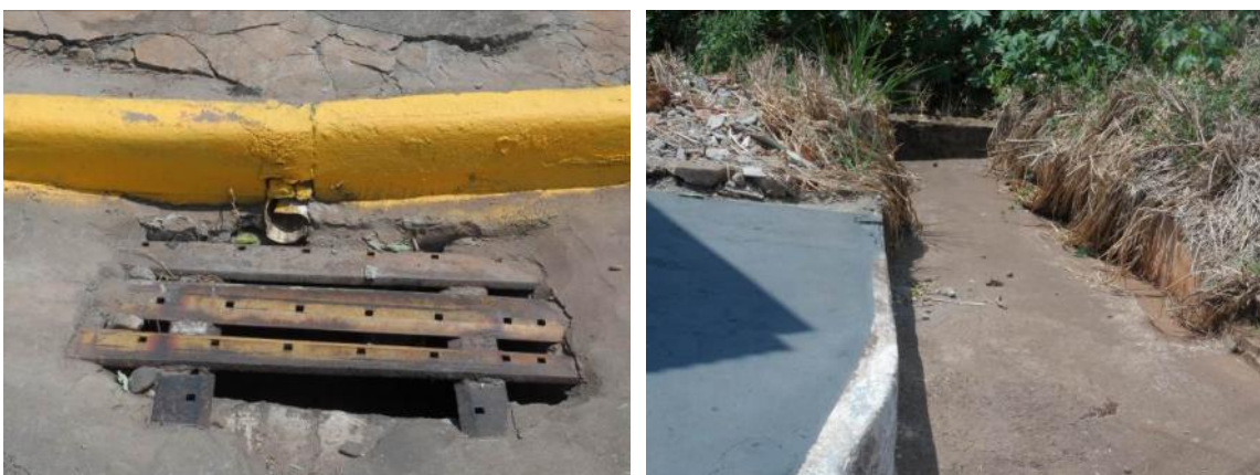
Figura 107 – Boca de lobo com grade.
