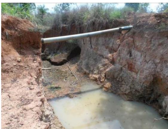
Figura 112 - Erosão causada pelo transbordamento de águas pluviais (barragem) sem a bueiro ou vertedouro.
