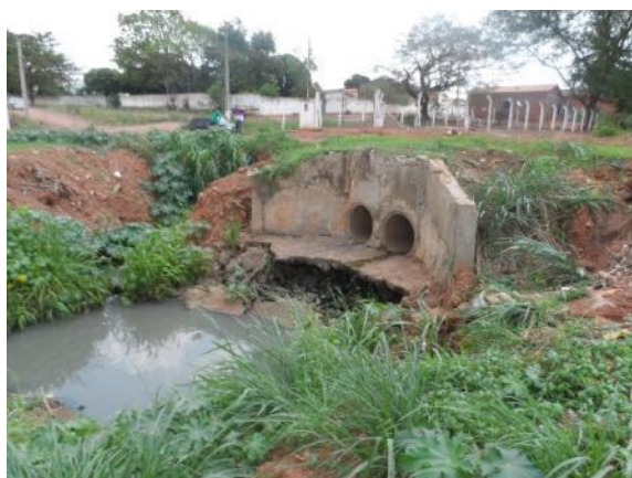
Figura 100– Esgoto escoando para o Córrego André
