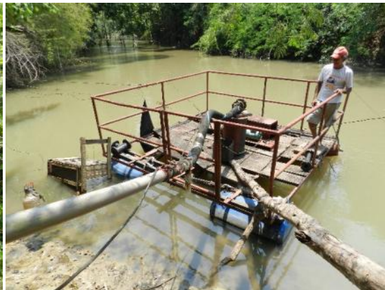
Figura 82 – Captação superficial tipo flutuante
