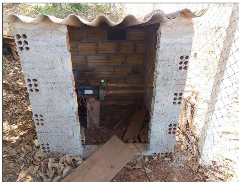
Figura 35: Abrigo da bomba auxiliar que contribui no abastecimento da Comunidade Progresso.
