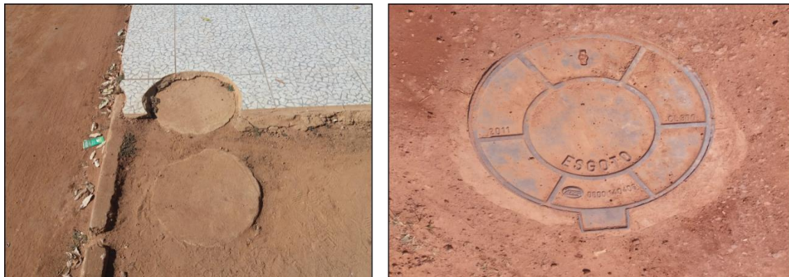
Figura 41: Tampas dos poços de visita de esgoto.
