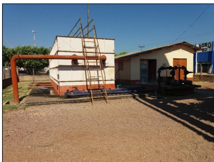
Figura 20 – Vista Geral - Estação de Tratamento de Água (ETA)
