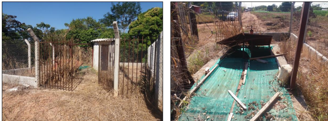
Figura 42: Estação Elevatória de Esgoto 01.
