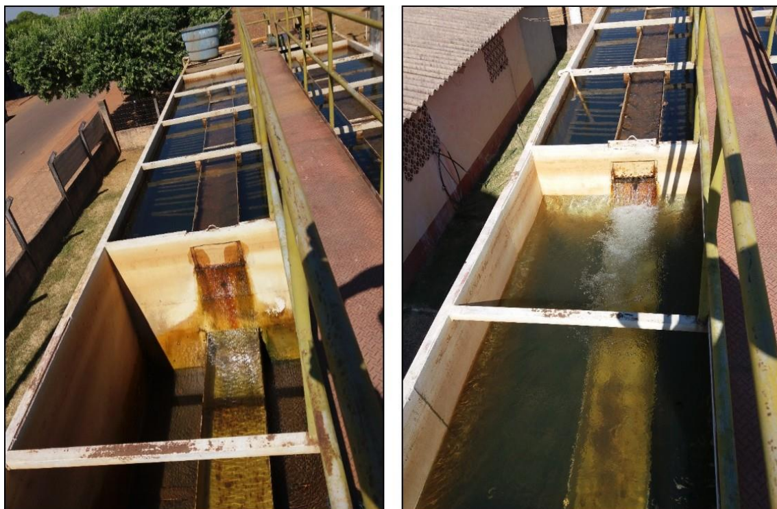
Figura 26: Filtros de água.
