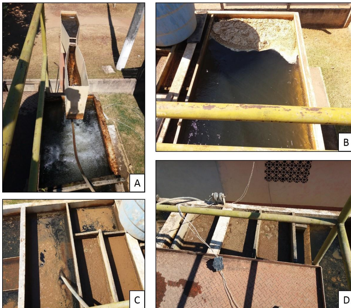
Figura 24: Sistema de tratamento de água. A: Entrada da água bruta no sistema; B: Tanque de Flocculação; C e D: Detalhes do tanque de Flocculação.
