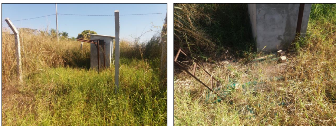
Figura 43: Estação elevatória de Esgoto 02.
