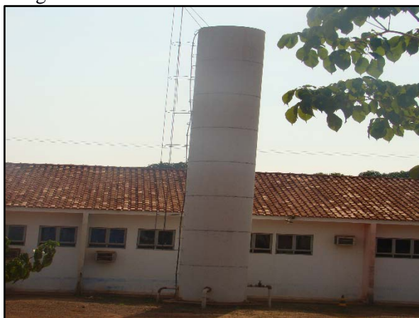
Figura 26. Reservatório torre metálico de 30m 3
