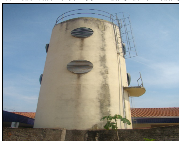
Figura 27. Reservatório de 200 m 3 da Creche Rosa Camacho
