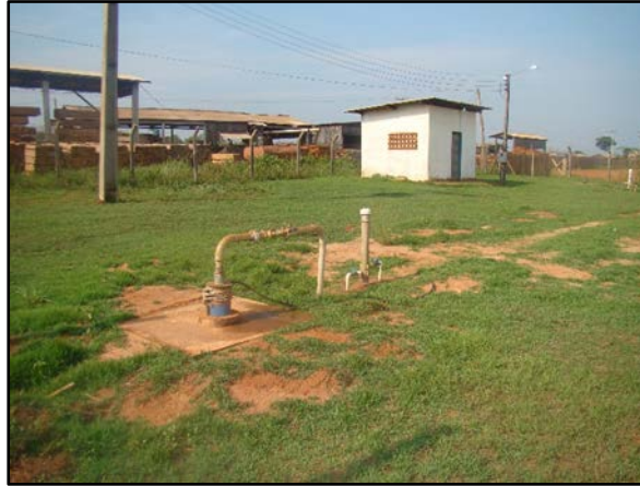
Figura 11. Estrutura do PT 03
