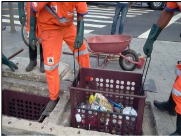
Figura 85. Cesta acoplada à boca do bueiro
