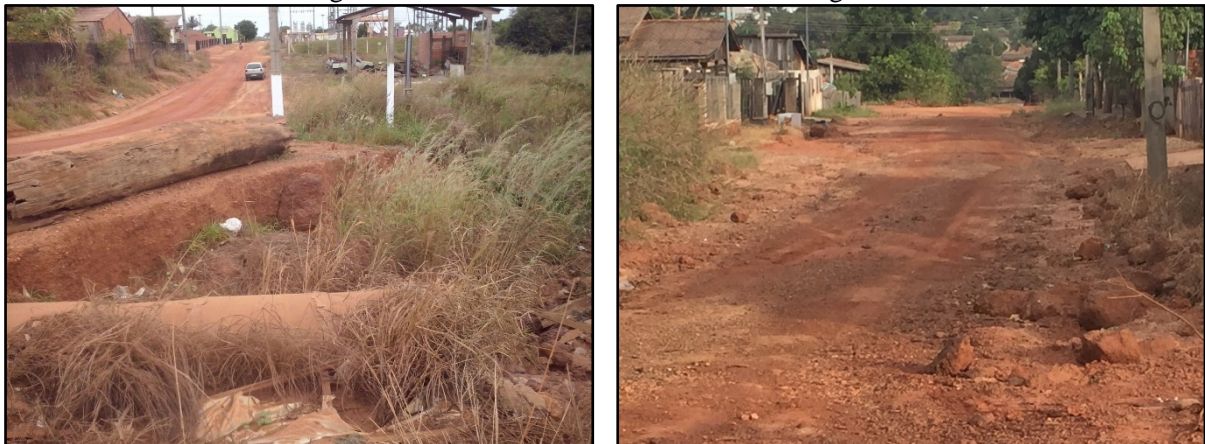
Figura 37. Erosões nas ruas em Nova Maringá-MT
