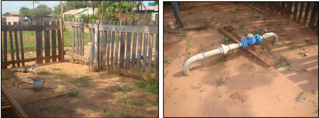
Figura 12. Estrutura do PT 04 com macromedidor instalado
