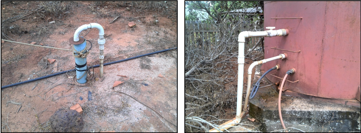
Figura 61. PT 02 com reservatório ao lado
