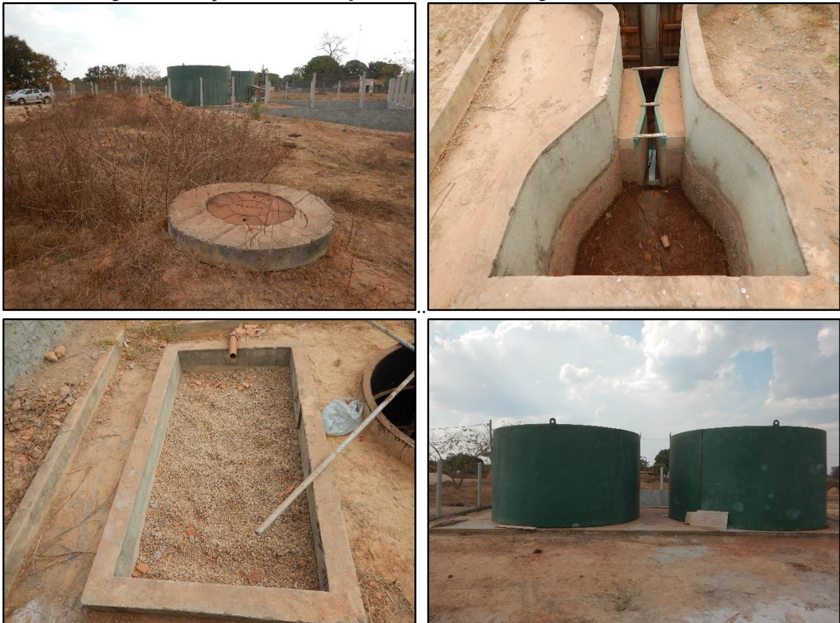
Figura 28. Dispositivos da estação de tratamento de esgoto de Nova Nazaré-MT
