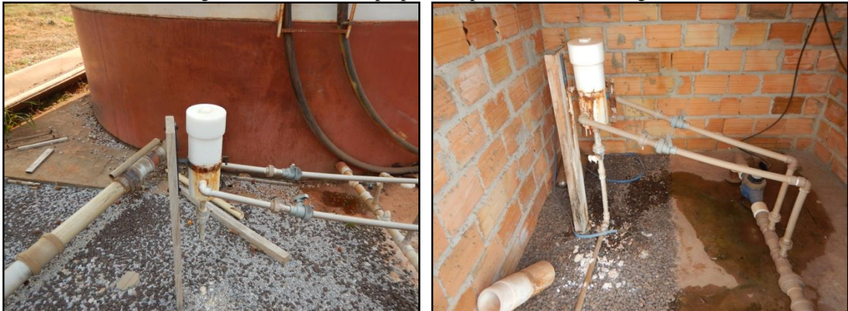
Figura 22 Cloradores tipo pastilha para tratamento da água
