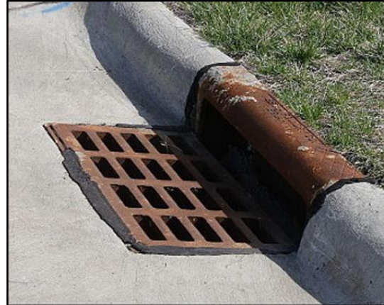
Figura 71. Boca de lobo com gradeamento na sarjeta
