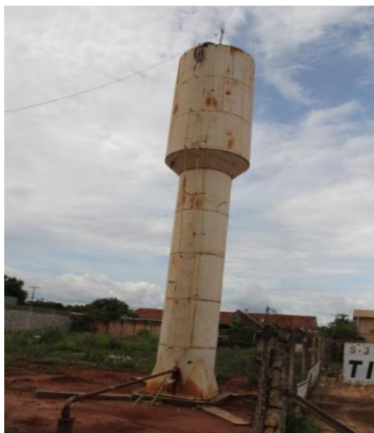
Figura 82: Reservatório I Água Limpa
