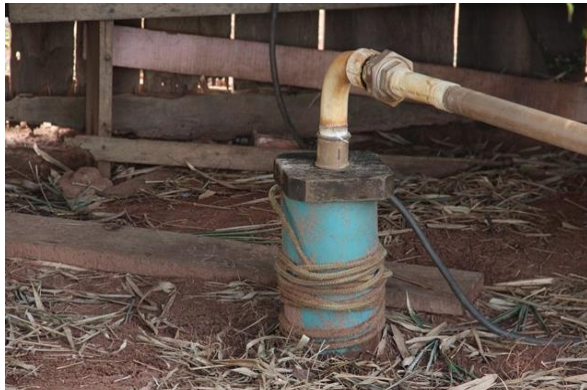
Figura 66: Poço Santa Terezinha
