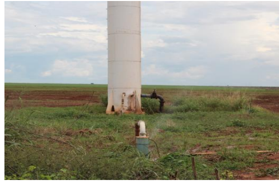
Figura 73: Poço II Água Limpa.
