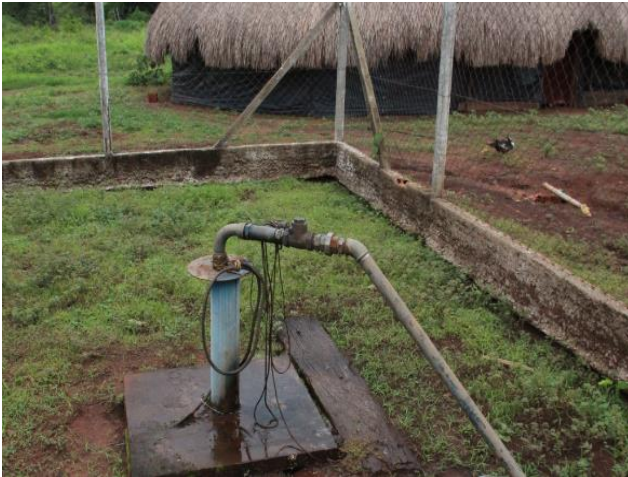
Figura 68: Poço Aldeia Tupará.
