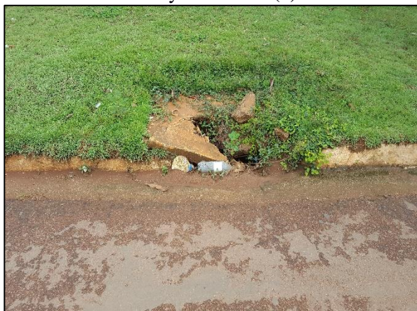
Figura 38. Boca de lobo com a tampa danificada reduzindo a área de entrada das águas pluviais na Av. Ayrton Senna (9)
