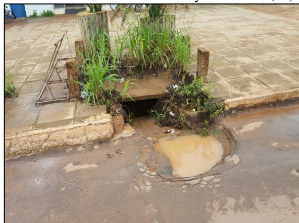
Figura 39. Boca de lobo coberta com mato e ineficiente devido ao estrangulamento da entrada e ao buraco no asfalto na Av. Ayrton Senna (10)
