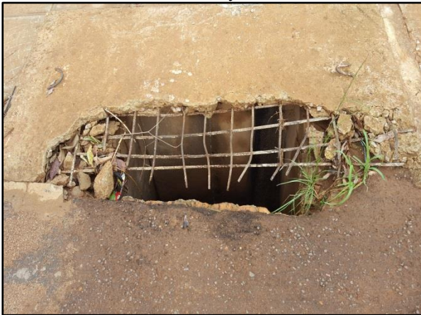
Figura 32. Ferragens expostas da tampa de uma boca de lobo Av. Ayrton Senna (9)
