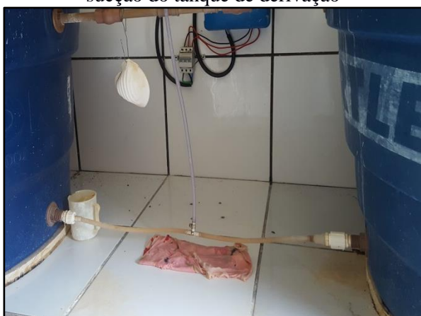
Figura 16. Mangueira que conecta as caixas com a solução de hipoclorito de cálcio na tubulação de sucção do tanque de derivação
