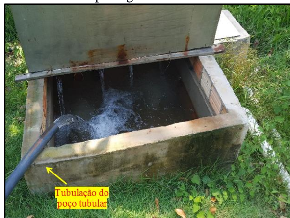
Figura 11. Tubulação do poço tubular alimentando a caixa de passagem dos drenos da mina
