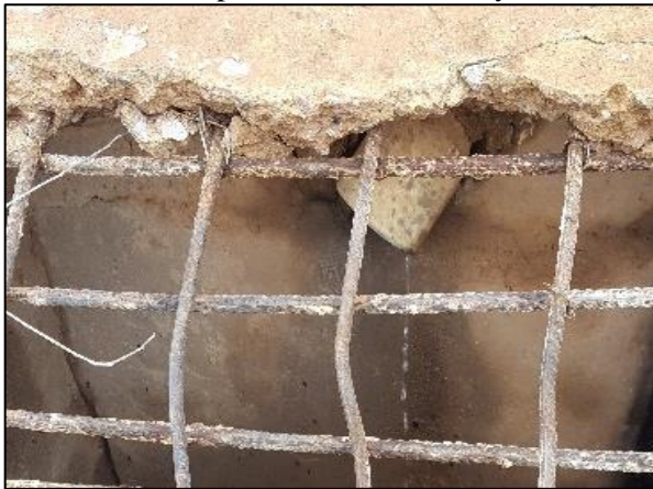
Figura 29. Lançamento de esgoto na boca de lobo em frente um supermercado na Av. Ayrton Senna
