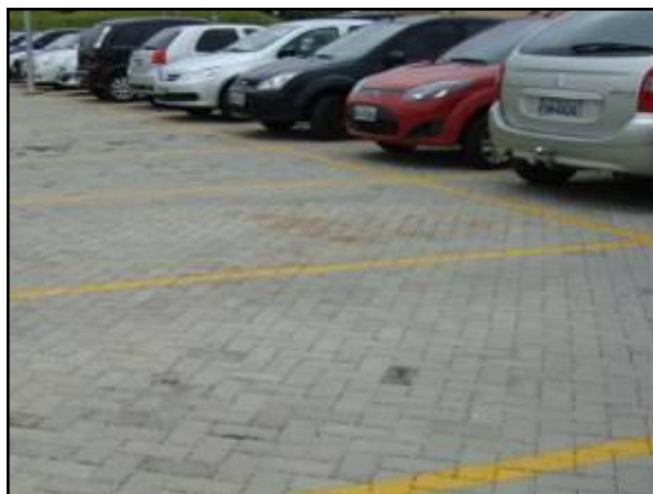
Figura 111. Pavimento poroso instalado em estacionamento
