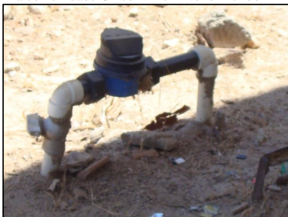
Figura 77. Hidrômetro instalado em uma ligação residencial na comunidade Cinco Mil em Novo Mundo-MT
