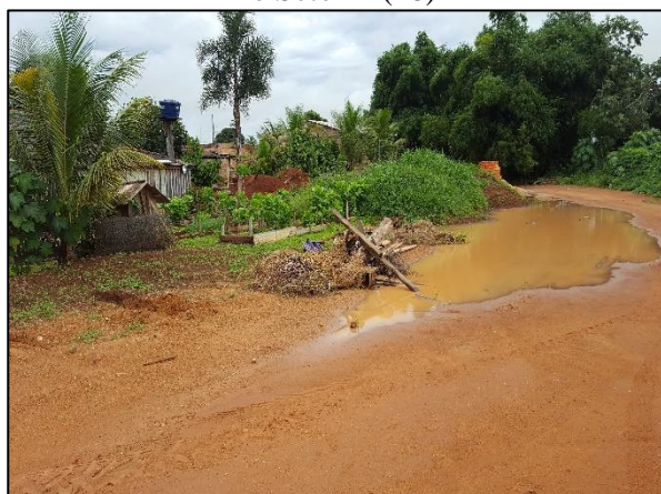
Figura 44. Ponto de alagamento na rua Cap. Félix no Setor II (18)
