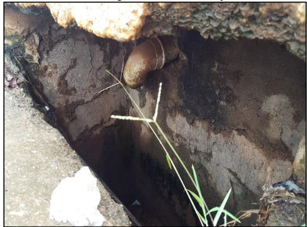
Figura 30. Lançamento de esgoto na boca de lobo em frente a uma padaria na Av. Ayrton Senna
