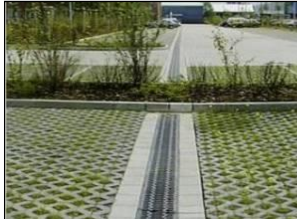
Figura 113. Trincheira de infiltração no estacionamento
