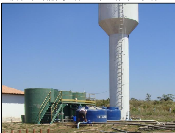
Figura 76. Reservatório instalado ao lado da ETA na comunidade Cinco Mil em Novo Mundo-MT
