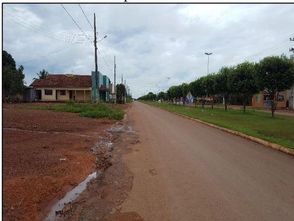
Figura 40. Erosão formada no limite entre o asfalto da av. Ayrton Senna e da rua Cedro Rosa não pavimentada
