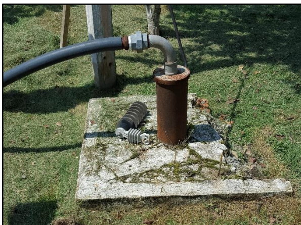
Figura 10. Captação subterrânea por poço tubular em Novo Mundo
