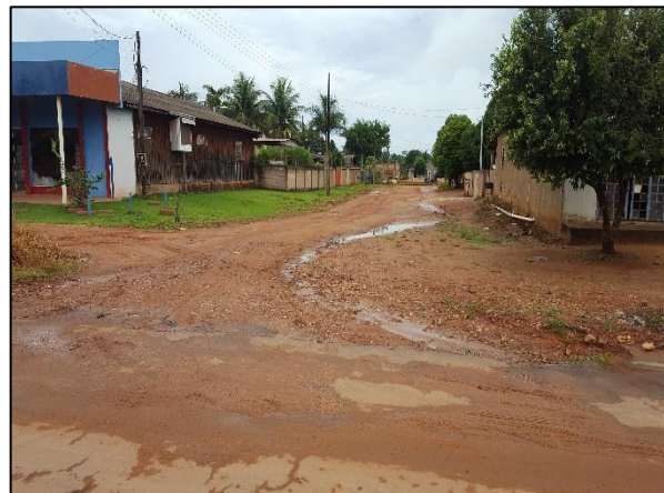
Figura 41. Erosão na rua São Paulo (22)
