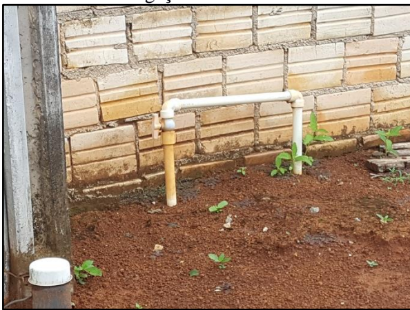
Figura 24. Cavalete sem hidrômetro de uma ligação domiciliar
