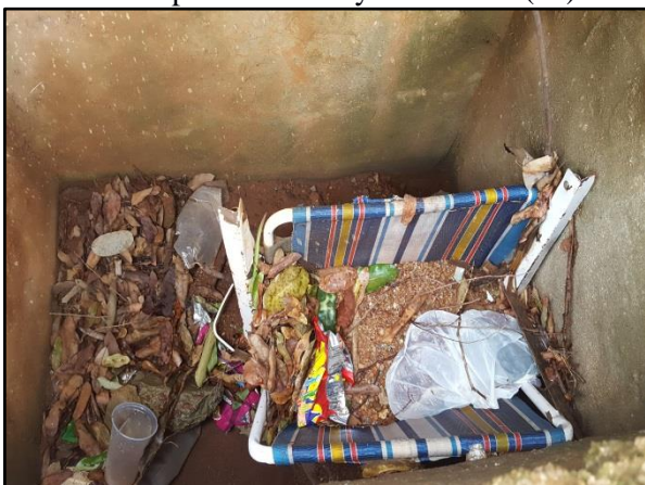
Figura 34. Boca de lobo com interior preenchido com resíduos de cadeira, copo descartável, folhas e sacola plástica Av. Ayrton Senna. (11)
