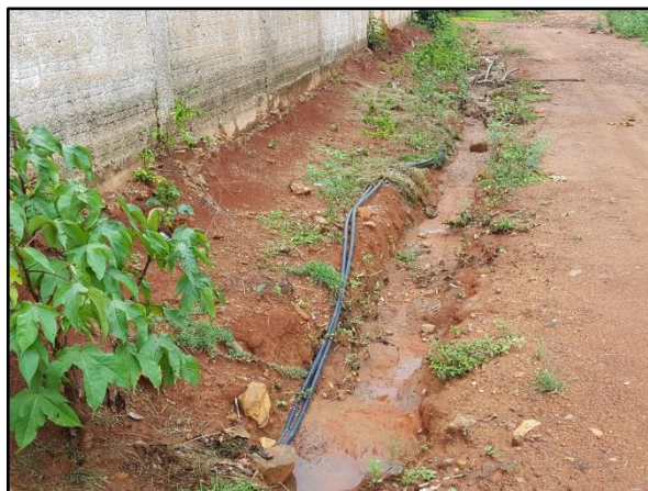
Figura 21. Tubulação de PEAD de 25 mm aflorante na Rua Juscelino Kubistchek
