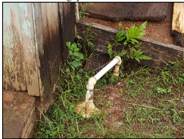
Figura 25. Cavalete sem hidrômetro de uma ligação comercial
