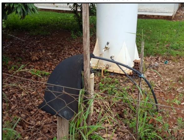
Figura 22. Poço tubular e reservatório tipo taça em uma residência na área urbana de Novo Mundo
