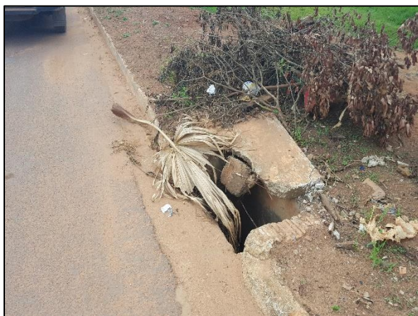
Figura 35. Boca de lobo com tampa danificada e com resíduos de folhas na Av. Ayrton Senna (5)
