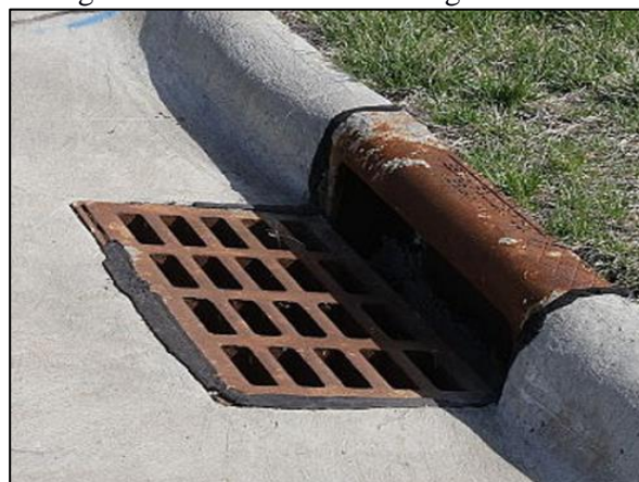
Figura 105. Boca de lobo com gradeamento
