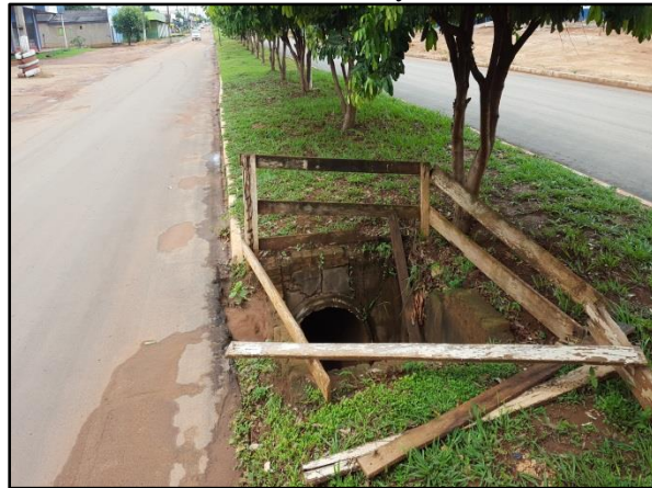
Figura 33. Caixa de passagem sem tampa no canteiro central da Av. Ayrton Senna (1)
