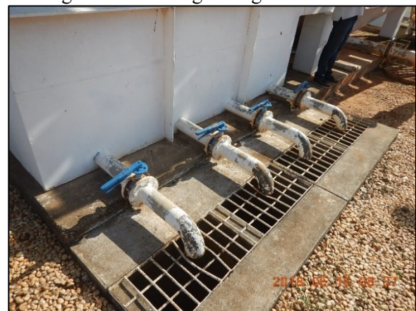
Figura 30. Descarga lavagem dos filtros
