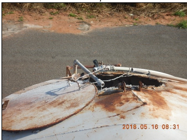
Figura 46. Câmara de contato em processo de oxidação
