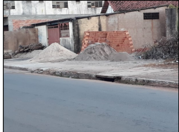
Figura 88. RCD dispostos na calçada
