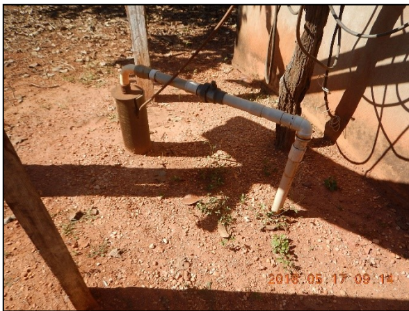
Figura 91. Barrilete do poço da Agrovila Araras
