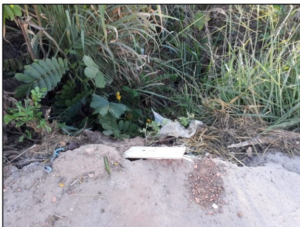
Figura 54. Descarga de galeria em fundo de vale
