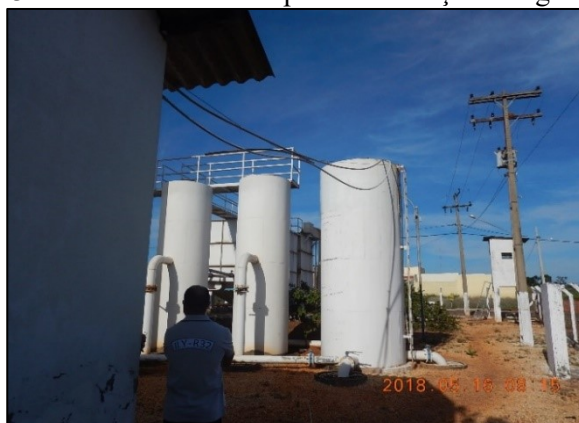
Figura 31. Câmara de contato para desinfecção da água tratada
