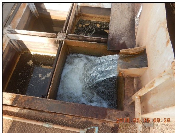
Figura 45. Orifício na parede do floclador
