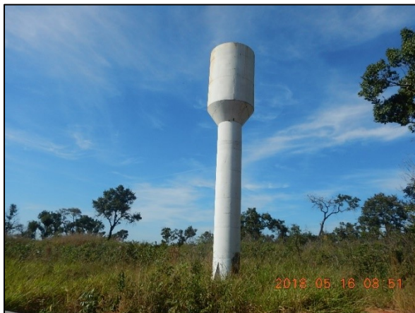
Figura 48. Reservatório elevado com sinais de vazamento
