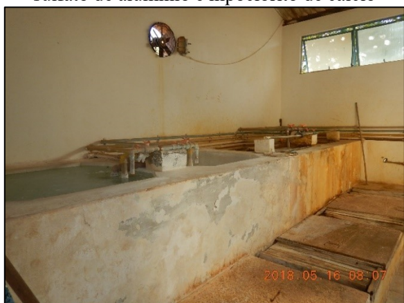
Figura 32. Tanque de preparo da solução de sulfato de alumínio e hipoclorito de cálcio
