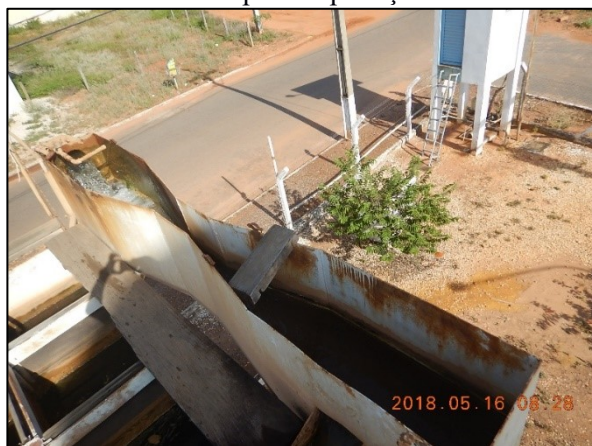
Figura 26. Calha Parshall - ponto aplicação de sulfato de alumínio
