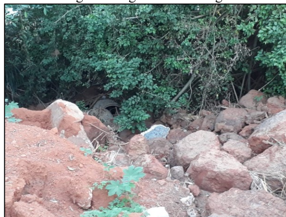
Figura 55. Descarga de galeria sem dissipador de energia à margem do rio Araguaia
