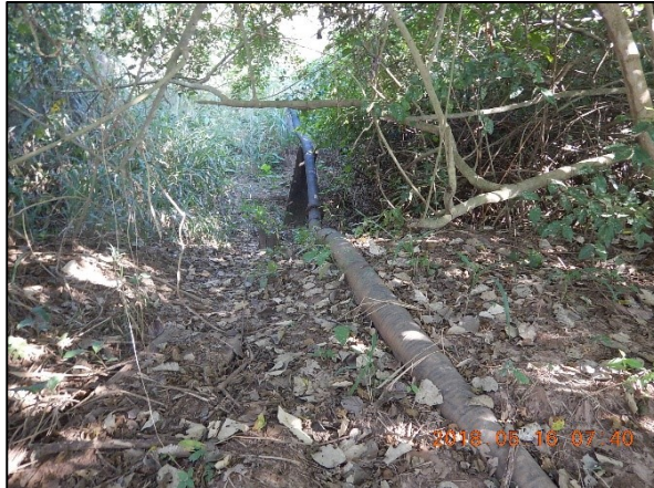
Figura 19. Adutora de água bruta
