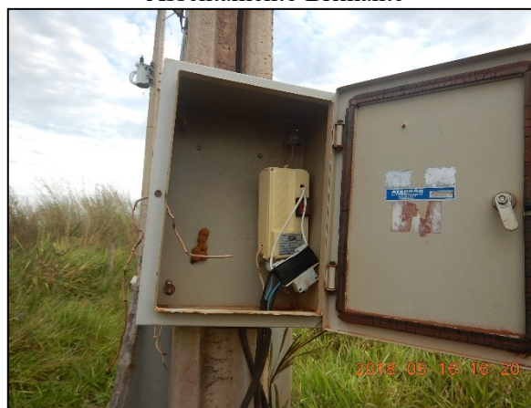
Figura 95. Quadro de comando do P01 no Assentamento Brilhante
