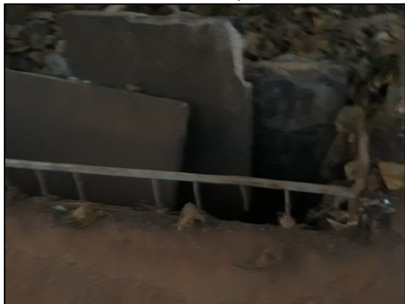
Figura 56. Boca de lobo com tampa danificada na Rua José Maria, centro
