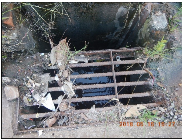
Figura 62. Boca de lobo com tampa danificada
