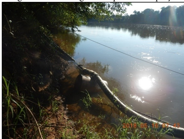
Figura 13. Rio Araguaia no ponto de captação
