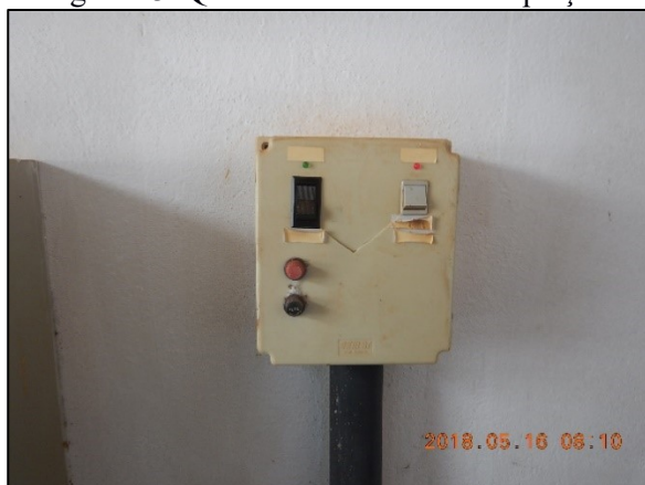
Figura 23. Quadro de comando da captação
