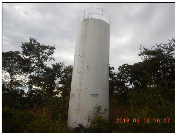
Figura 96. Reservatório metálico cilíndrico de 50 m 3 do P02
