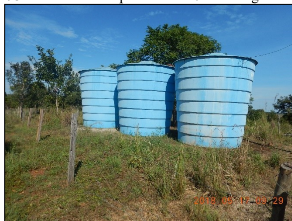
Figura 93. Reservatórios apoiados de 20 m 3 na Agrovila Araras
