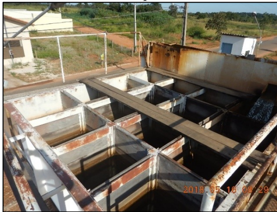
Figura 27. Floculador hidráulico de fluxo vertical do tipo Alabama
