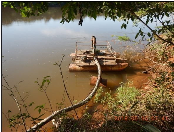
Figura 15. Sistema de captação e mangote de interligação na adutora
