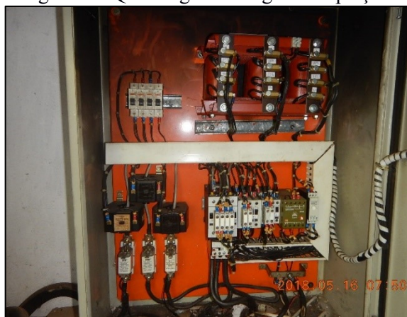
Figura 22. Quadro geral energia da captação
