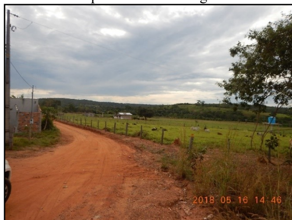
Figura 101. Estrada vicinal de acesso ao Assentamento Brilhante construída sem os dispositivos de drenagem
