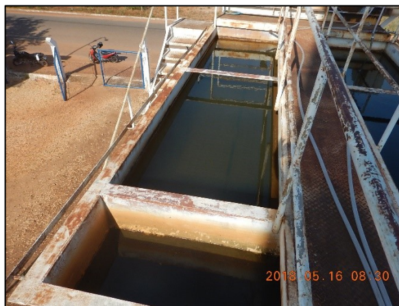
Figura 47. Passarela com sinais de corrosão
