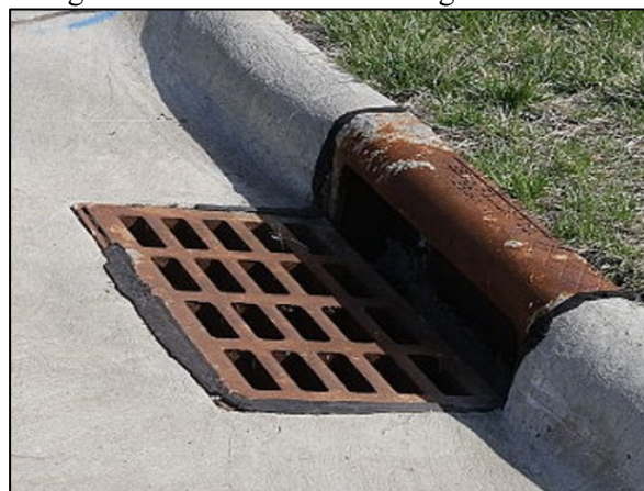
Figura 123. Boca de lobo com gradeamento
