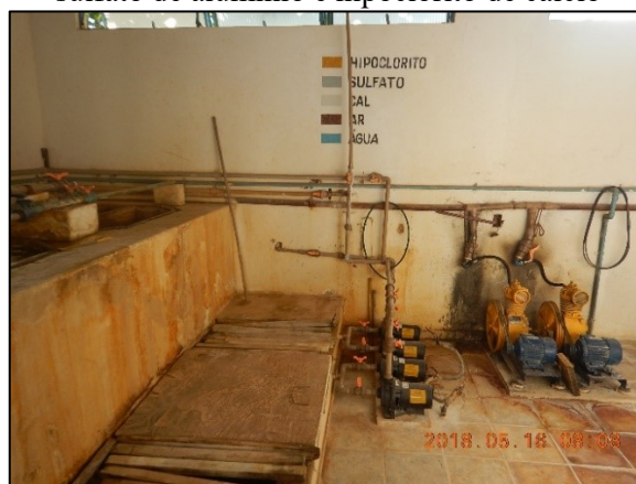
Figura 33. Bombas dosadoras das soluções de sulfato de alumínio e hipoclorito de cálcio
