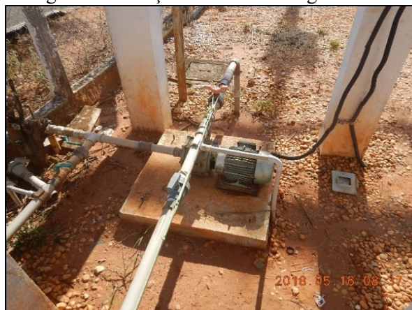
Figura 36. Estação elevatória de água tratada
