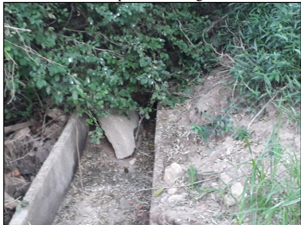
Figura 63. Desague de águas pluviais sem dissipador de energia
