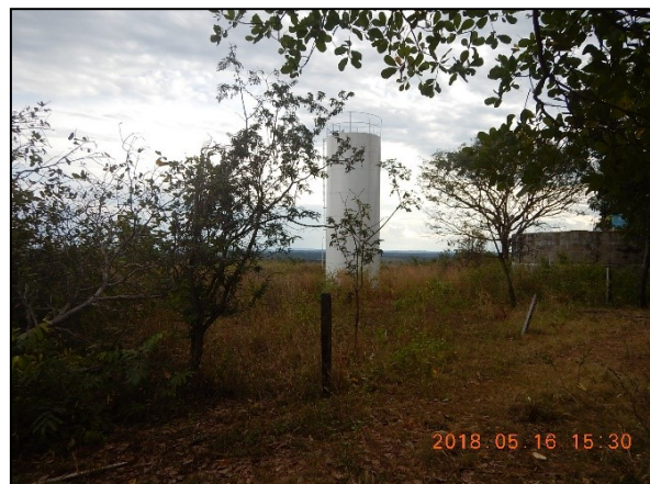
Figura 98. Reservatório metálico cilíndrico de 50 m 3 do Assentamento Sol
