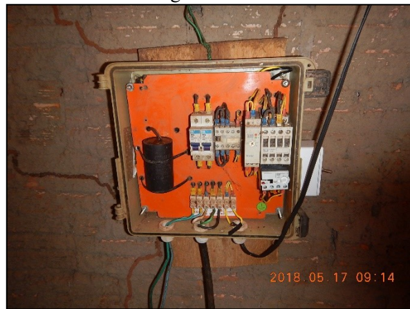
Figura 92. Quadro de comando da bomba do poço da Agrovila Araras
