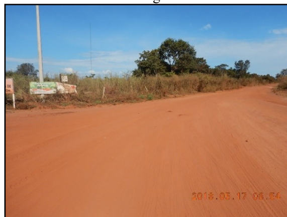
Figura 102. Estrada vicinal de acesso a Agrovila Araras construída sem os dispositivos de drenagem
