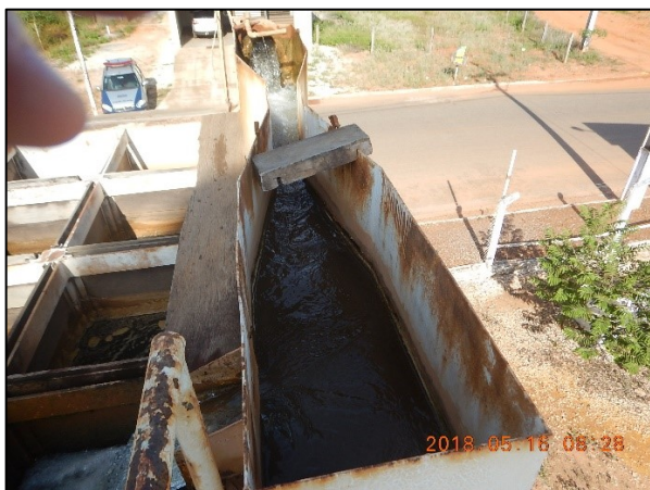
Figura 44. Barra de aço perfurando parede do floclador
