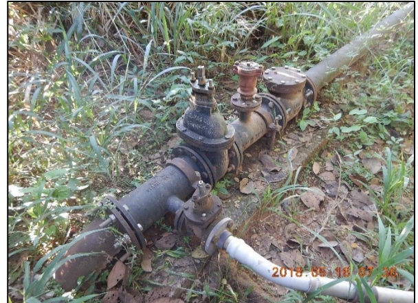
Figura 20. Adutora com diâmetro de 150 mm
