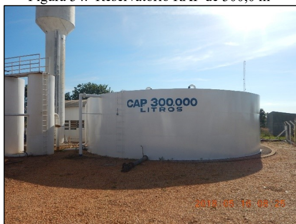
Figura 34. Reservatório RAP de 300,0 m 3
