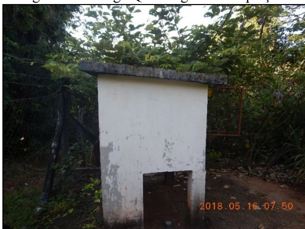
Figura 21. Abrigo Quadro geral da captação
