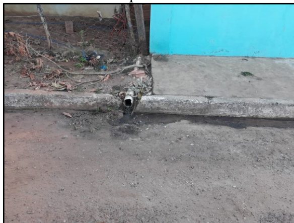
Figura 50. Despejo de água servida em via pública
