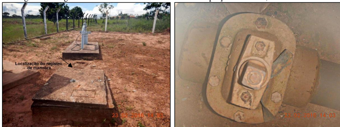
Figura 10. Registro de manobra localizado na área de captação do PT-02, em Ponte Branca
