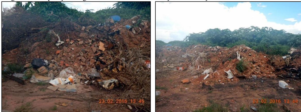
Figura 53. Disposição irregular de resíduos de construção e demolição em lixão de Ponte Branca
