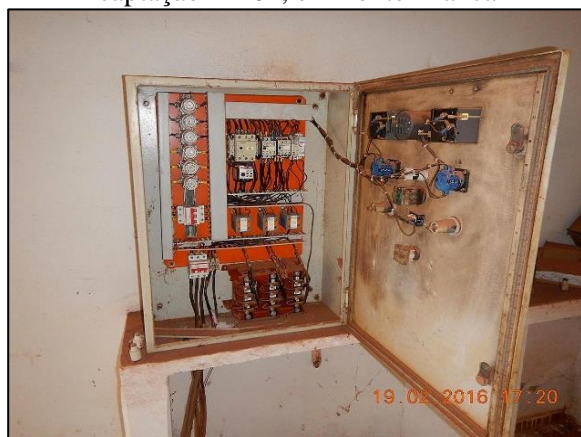
Figura 11. Quadro de comando da bomba da captação PT-01, em Ponte Branca
