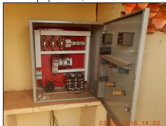
Figura 12. Quadro de comando da bomba da captação PT-02, em Ponte Branca
