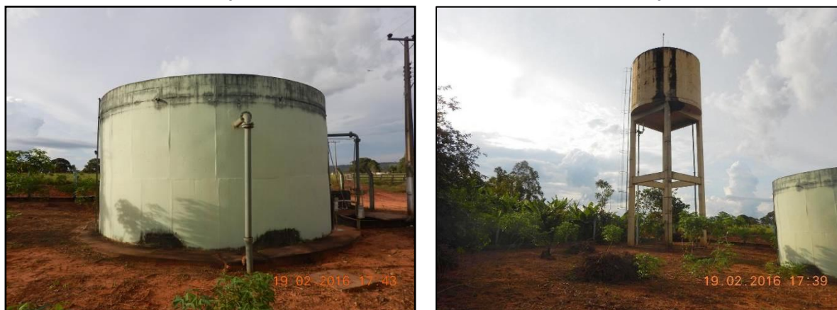
Figura 14. Reservatórios do sistema de abastecimento público de água de Ponte Branca RAP-01 REL-02
