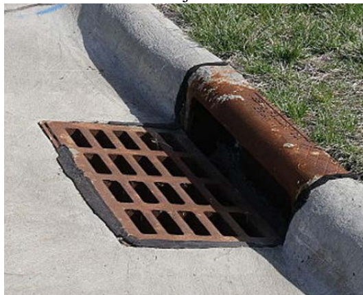
Figura 85. Boca de lobo com gradeamento na sarjeta
