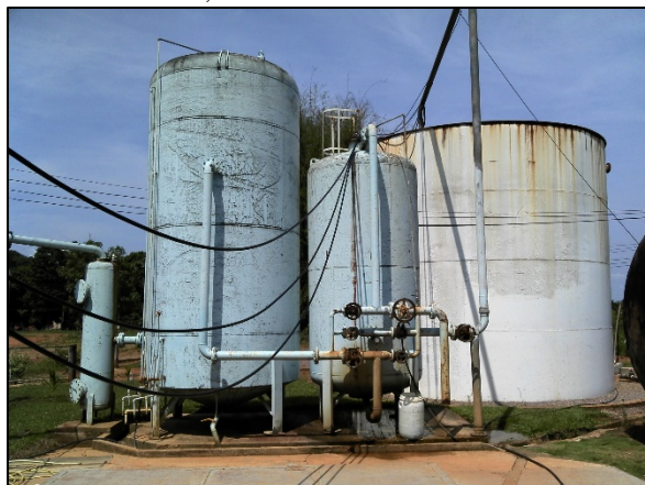
Figura 11. Floccodecantador, filtro e reservatório - ETA Porto dos Gaúchos
