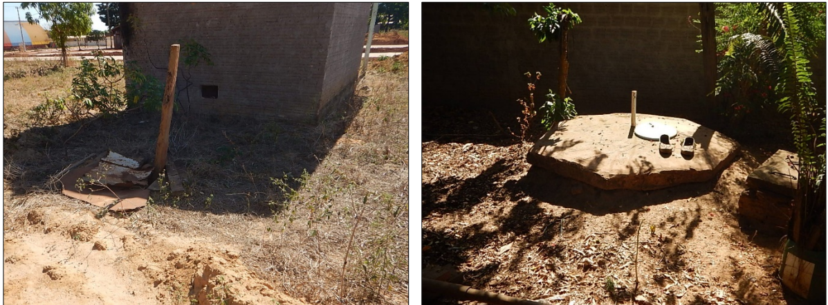
Figura 60. Fossa coberta com madeira e metais (a) e vista exterior de fossa com suspiro, Novo Paraná, Porto dos Gaúchos-MT
