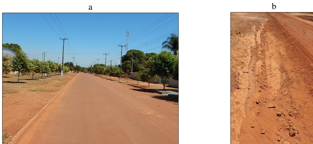
Figura 51. Via pavimentada (a) e erosões (b), Gleba São João, Porto dos Gaúchos-MT
