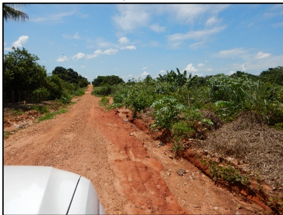
Figura 23. Erosão causada por águas pluviais, Av. Mato Grosso, Porto dos Gaúchos-MT
