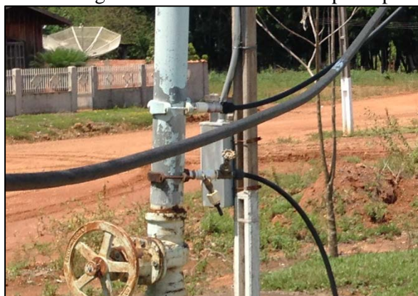
Figura 12. Tubulação de entrada da água bruta e colar de tomada para aplicação de sulfato de alumínio
