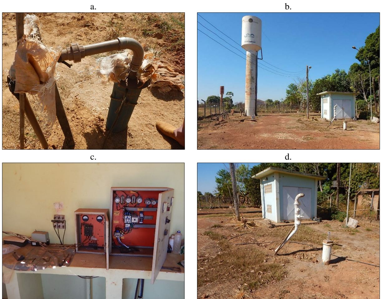
Figura 57. Poço tubular (a), reservatório e cerca de proteção (b), quadro de comando (c) e abrigo, Novo Paraná, Porto dos Gaúchos-MT
