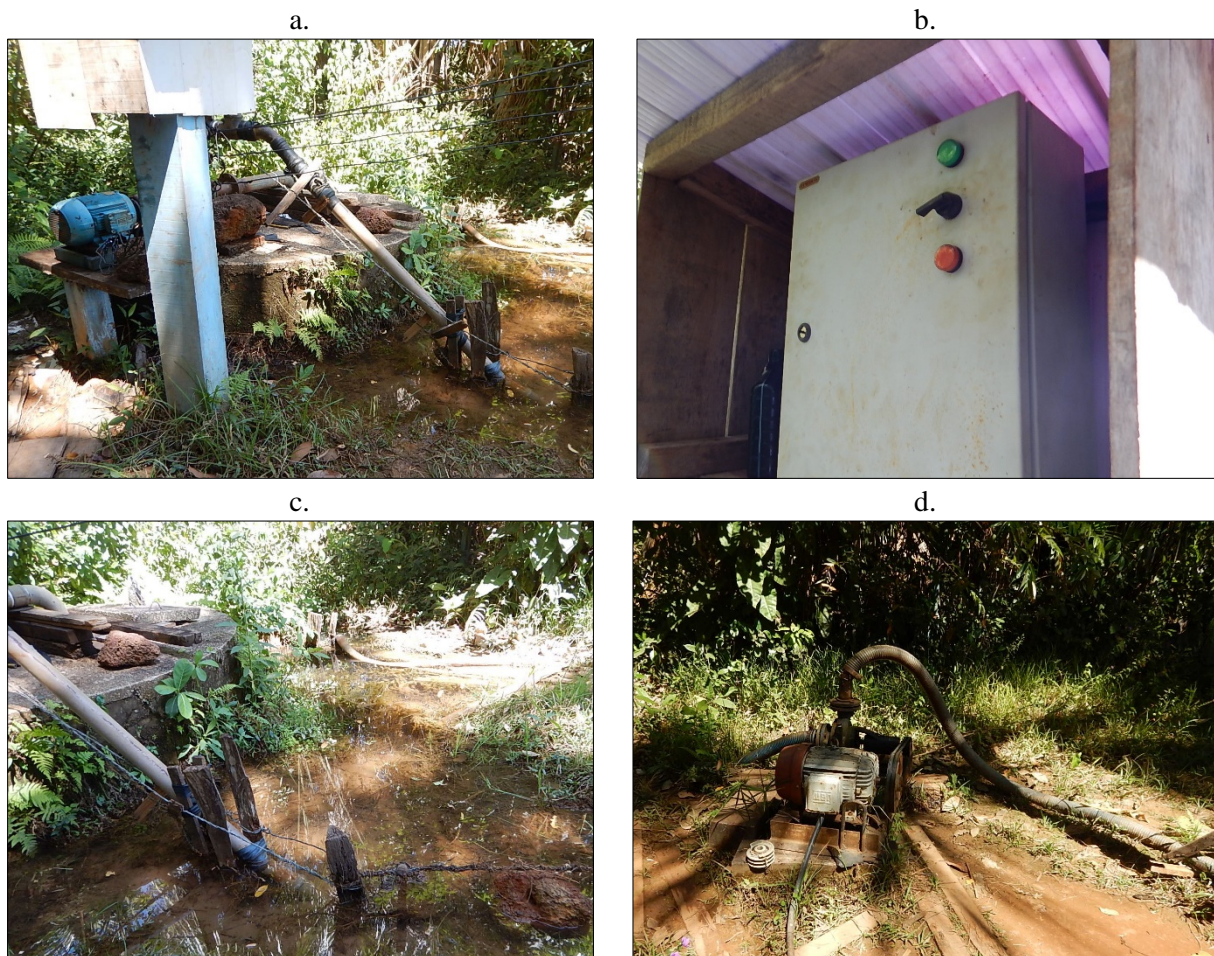
Figura 47. Mina d'água (a), quadro de comando adutora (c) e cerca de proteção(d), Gleba São João, Porto dos Gaúchos-MT
