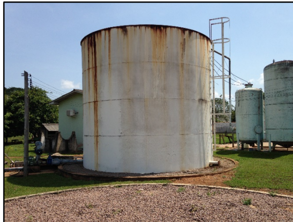
Figura 14. Reservatório R1 de 200,0 m 3 na área da ETA, Porto dos Gaúchos-MT
