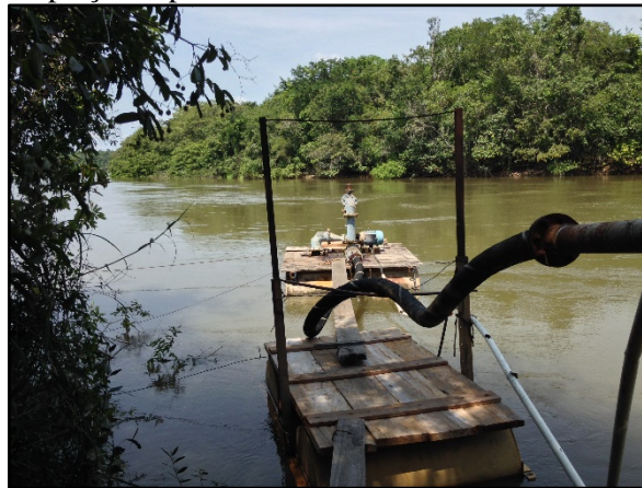
Figura 9. Captação superficial no rio Arinos, Porto dos Gaúchos-MT
