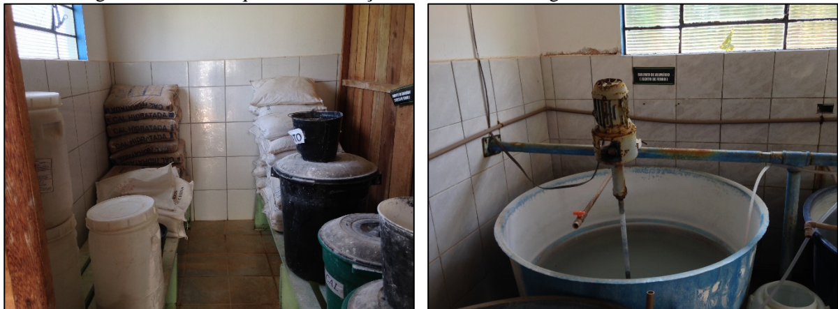
Figura 13. Casa de química da estação de tratamento de água de Porto dos Gaúchos
