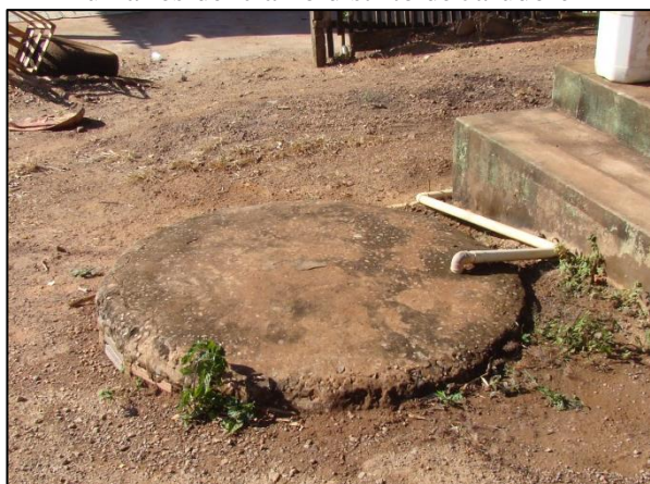
Figura 125. Tampa de uma fossa rudimentar em uma residência no distrito de Jarudore
