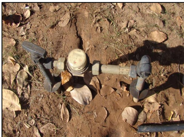
Figura 104. Ligação predial equipado com hidrômetro no distrito Alto Coité
