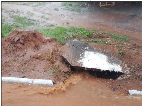
Figura 43. Boca de lobo com depressão mal executada na Av. Brasília no bairro Jd. das Américas (15)
