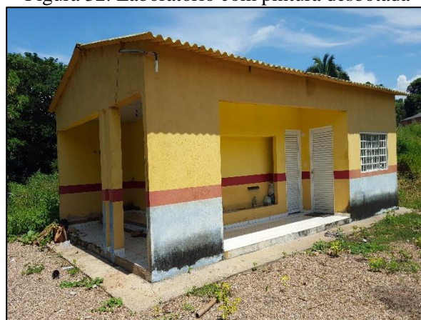
Figura 32. Laboratório com pintura desbotada
