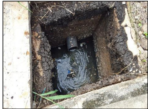
Figura 34. Caixa de passagem do efluente tratado da ETE-Centro
