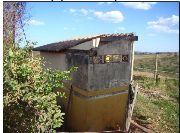
Figura 123. Abrigo do clorador e do quadro de comando do poço tubular de Aparecida do Leste
