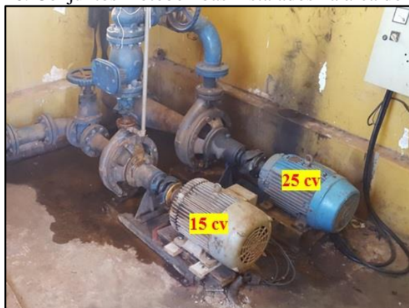
Figura 26. Conjuntos motobombas instalados na área do RAP-01
