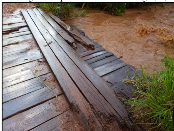
Figura 60. Ponte de madeira suscetível à carregamento pela enxurrada do córrego (11)
