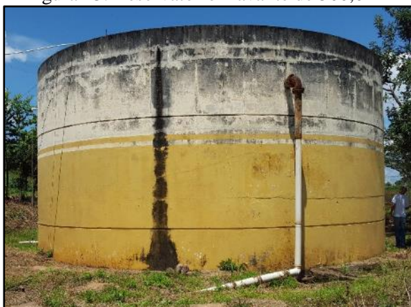
Figura 23. Reservatório Xavante de 500,0 m 3
