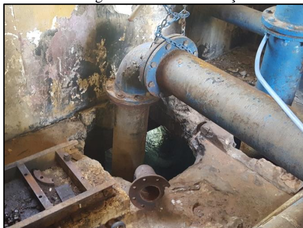
Figura 14. Tubulação de sucção da captação interligada na câmara de sucção
