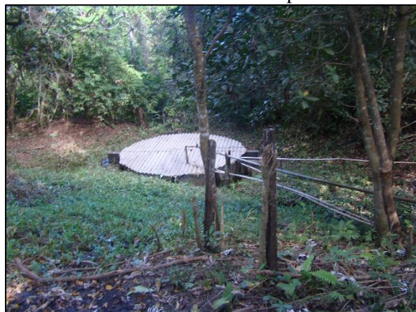
Figura 124. Poço de acumulação da água da mina para abastecimento da comunidade de Aparecida do Leste
