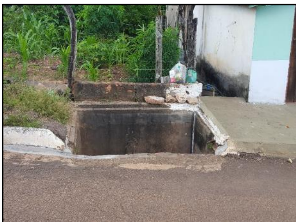
Figura 40. Boca de lobo sem tampa na Av. Bandeirantes no bairro Vila Santa Teresinha (23)
