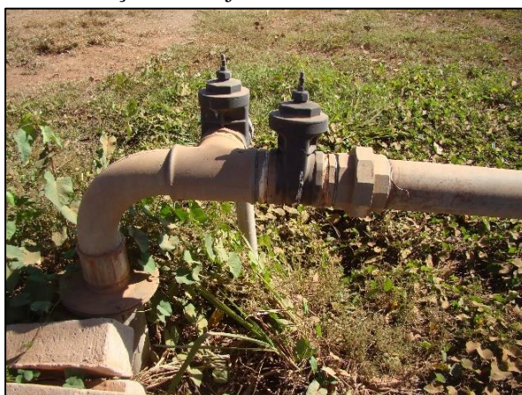
Figura 117. Poço tubular jorrante do distrito Johannesburgo
