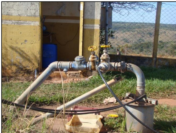
Figura 122. Poço artesiano do povoado Aparecida do Leste – Sistema I
