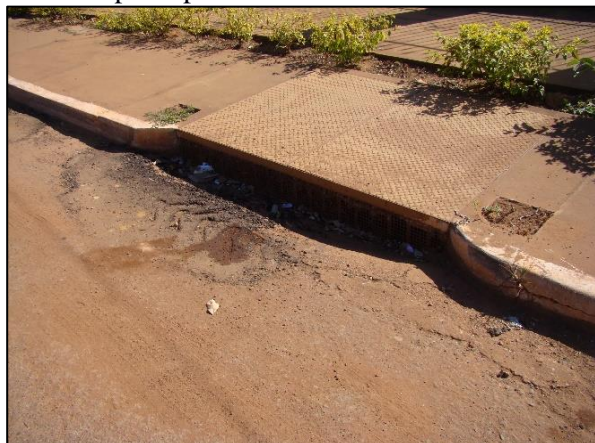
Figura 127. Dispositivos de microdrenagem na rua principal do distrito de Jarudore
