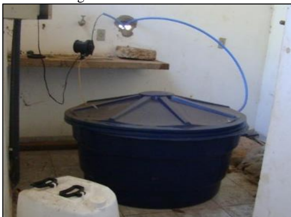
Figura 102. Tratamento simples de desinfecção de água do distrito Alto Coité
