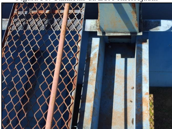
Figura 31. Canaletas da ETA enferrujadas
