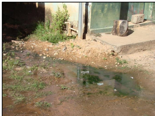
Figura 105. Vazamento de água na via pública do distrito de Alto Coité
