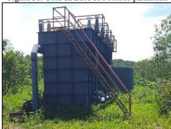
Figura 30. Obra da ETA de Poxoréu paralisada
