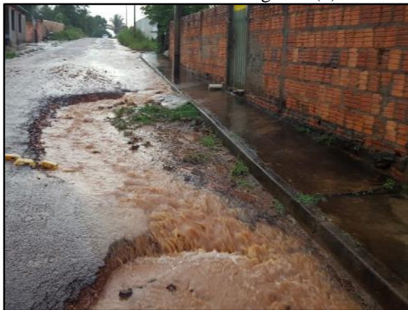
Figura 63. Processo erosivo na Rua Eduardo P. dos Santos no bairro Lagoa II (9)
