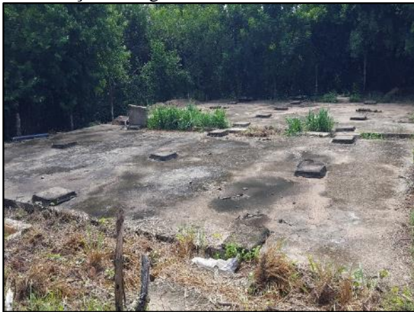
Figura 33. ETE-Centro enterrada composta de fossa séptica, filtro anaeróbio e desinfecção por cloração da região central de Poxoréu-MT.
