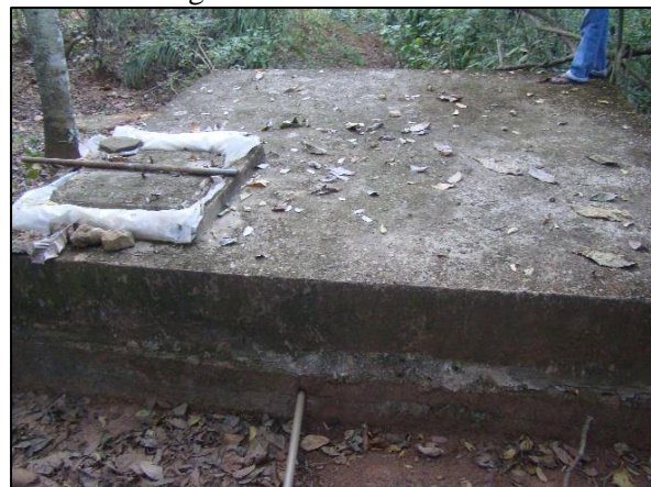
Figura 111. Poço de acumulação para abastecimento da população de Paraíso do Leste situada à margem direita do Rio Paraíso
