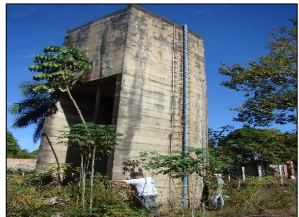
Figura 103. Reservatório de água tratada do distrito Alto Coité
