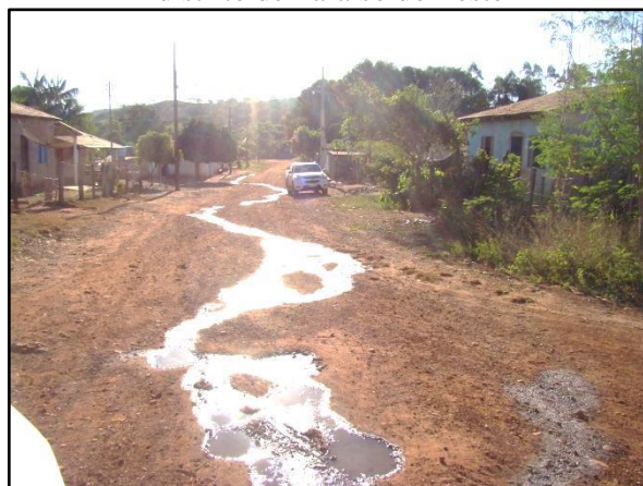
Figura 116. Vazamento de água na via pública do distrito de Paraíso do Leste
