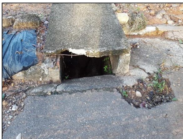
Figura 41. Boca de lobo com tampa danificada na Rua Nabu no bairro Vila Cruzeiro
