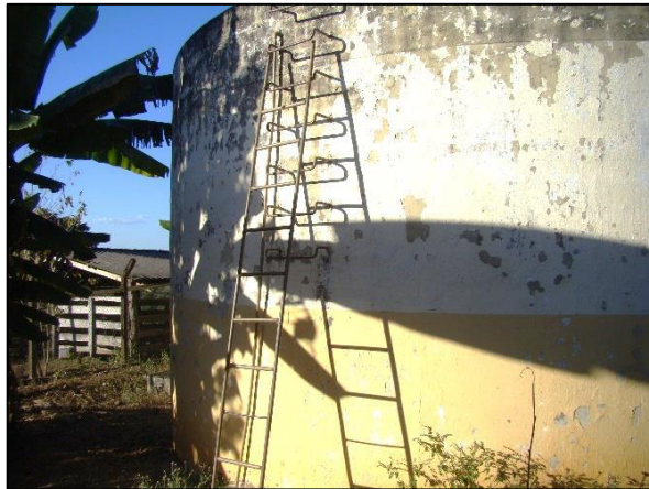
Figura 112. Reservatório RAP-01 no distrito de Paraíso do Leste
