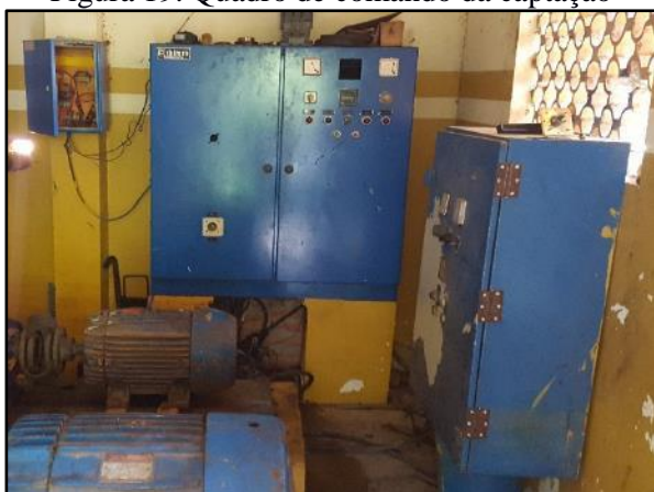
Figura 19. Quadro de comando da captação
