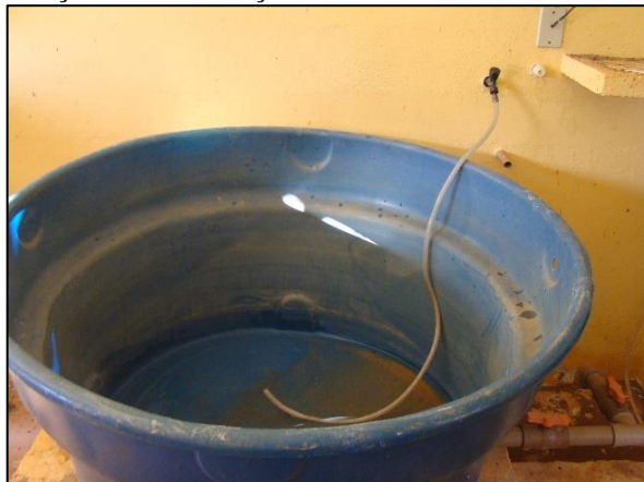
Figura 113. Reservatório para preparação da solução de desinfecção no distrito Paraíso do Leste
