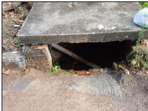
Figura 38. Ligação de esgoto em uma boca de lobo localizada na Av. Bandeirantes no bairro Vila Santa Terezinha
