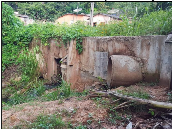
Figura 65. Desague do sistema de drenagem do bairro Vila Terezinha sem dissipador de energia (26)
