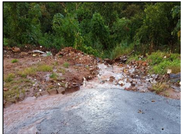
Figura 64. Erosão na saída rápida da Rua Salvador no bairro Jd. Poxoréu (17)
