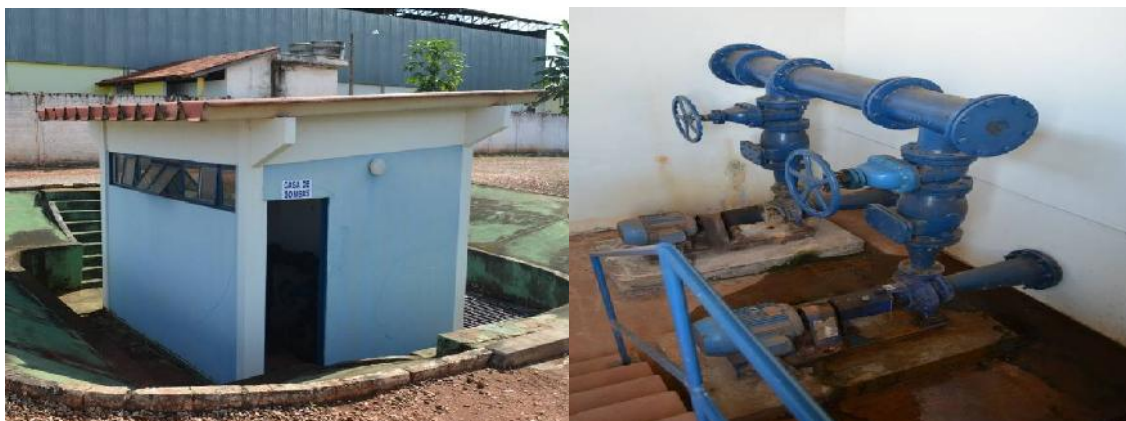
Figura 23 - Vista interna e externa da casa de bombas
