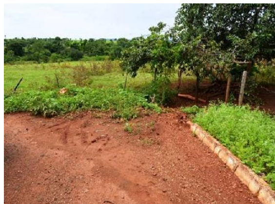
Figura 62 - Erosão em rua não pavimentada
