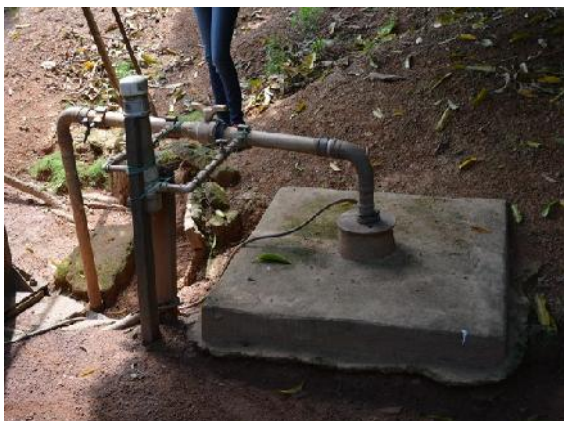
Figura 35 – Poço Tubular com clorador
