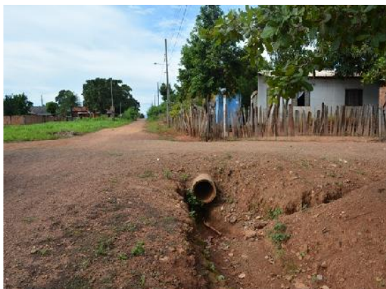
Figura 65 - Saída de tubulação de drenagem sem dissipador de energia princípio de erosão
