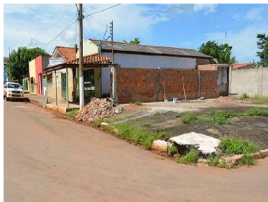
Figura 60 - entulho acima boca de lobo de passeio
