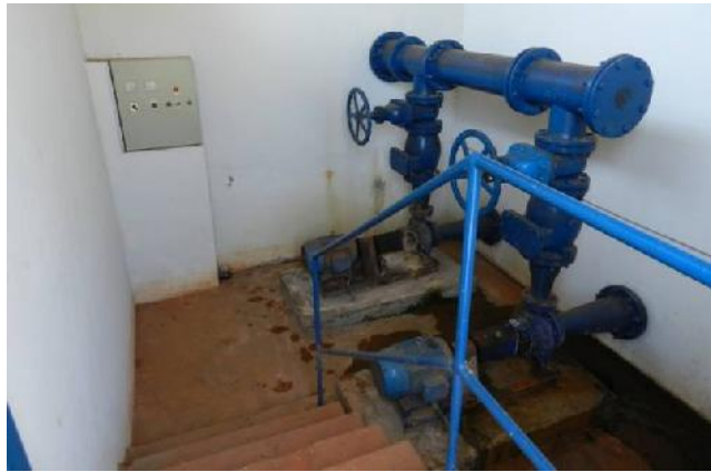
Figura 51 - Conjunto moto bomba
