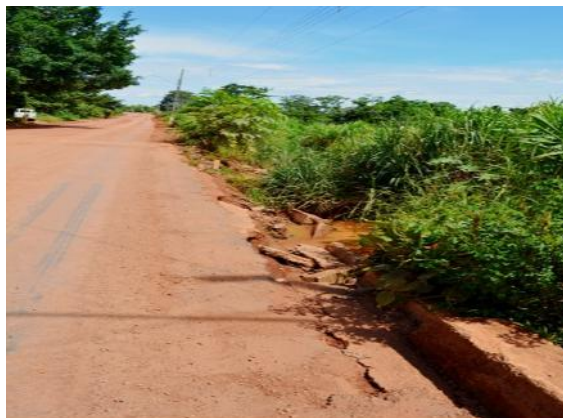
Figura 54 - Ponto de erosão entrada cidade - vindo Lambari d' Oeste
