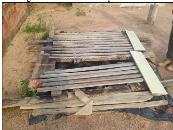
Figura 20. Fossa com tampa danificada
