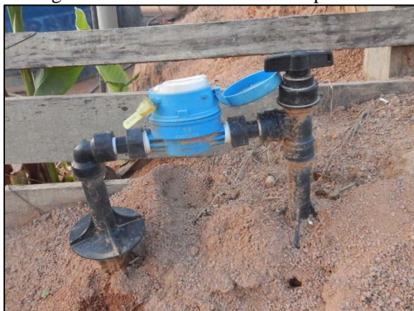
Figura 17. Hidrômetro instalado após ETA
