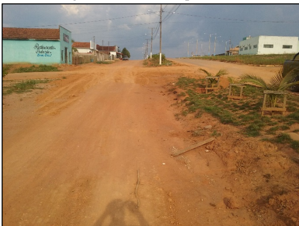
Figura 25. Ruas sem pavimento
