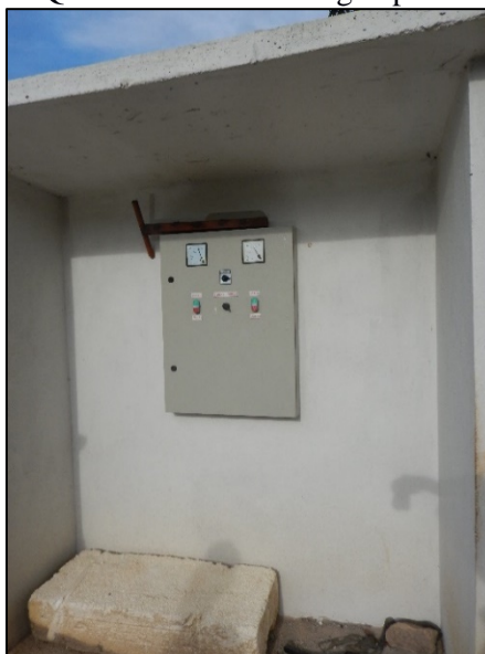
Figura 10. Quadro de comando “Igarapé São Gabriel”
