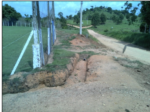
Figura 26. Início de erosão próximo da represa
