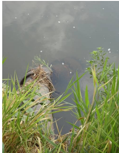
Figura 35 - Tubulação de sucção
