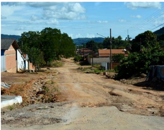
Figura 72 – fim de asfalto e início de via não pavimentada início de ravinas
