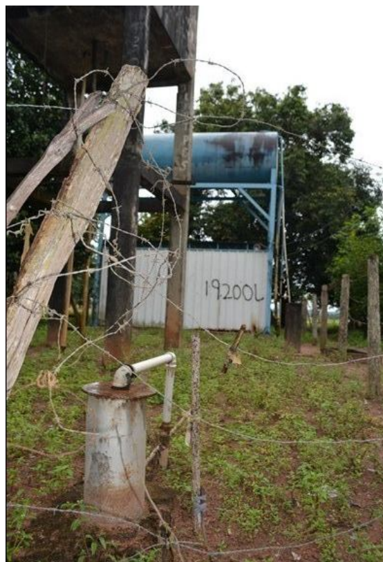
Figura 23 – poço nº 01 abastece a Vila Progresso
