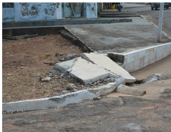
Figura 67– Boca de lobo danificada
