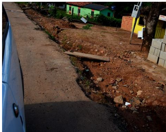
Figura 73– Pavimento sem meio fio e sarjeta início de processo erosivos na lateral da via.
