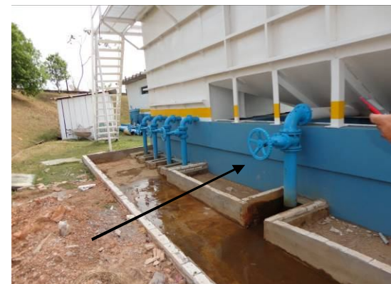
Figura 45– registro para descarga do lodo do decantador
