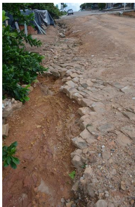
Figura 75– Início de processos erosivos em via não pavimentada.
