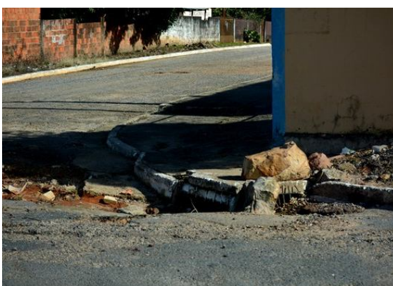
Figura 64– Boca de lobo danificada pela destruição do pavimento.
