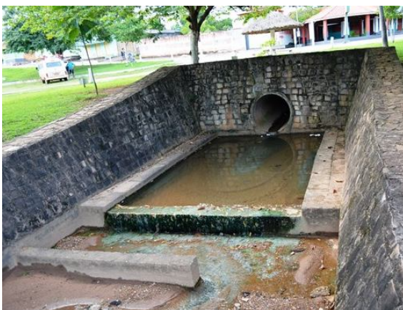
Figura 68– ponto de dissipação das águas captadas no sistema de drenagem.
