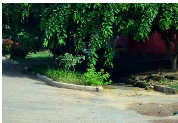
Figura 71 – Saída de água para o córrego
