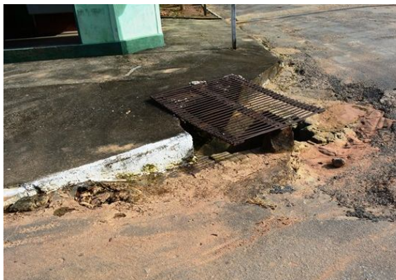
Figura 60 – Boca de lobo sem tampa e pavimento danificado
