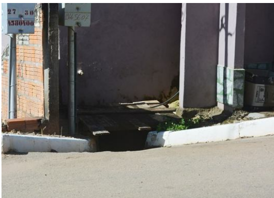
Figura 62– Boca de lobo com tampa improvisada de madeira
