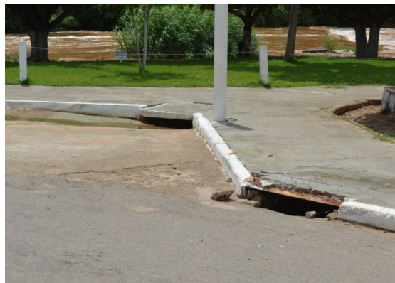
Figura 61– Boca de lobo próximas da cachoeira
