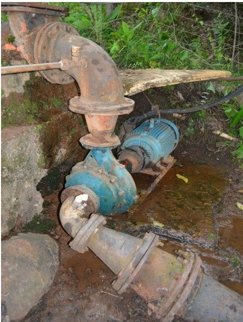
Figura 34 - bomba da captação
