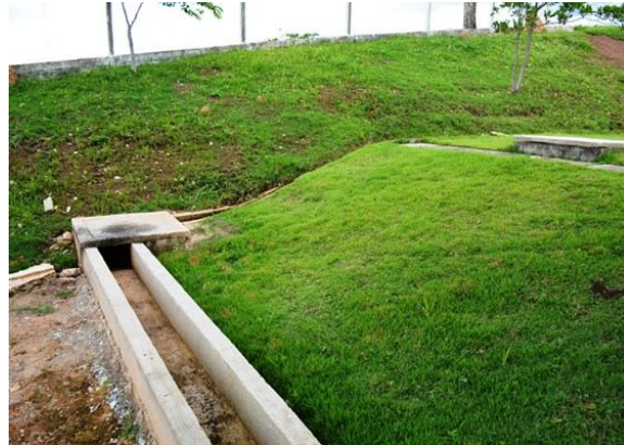
Figura 41 – Sistema de drenagem da área do DAE
