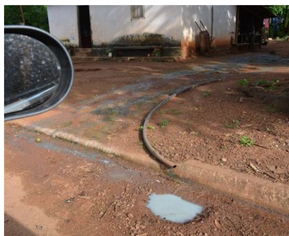
Figura 57– lançamento de água servidas na rua Vila São Jorge
