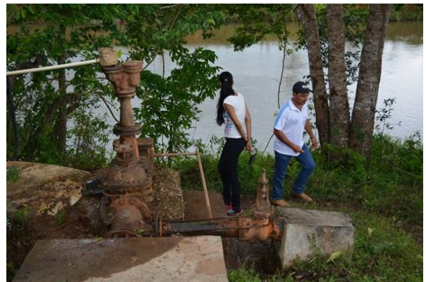
Figura 33 - Tubulação de sucção em ferro fundido.
