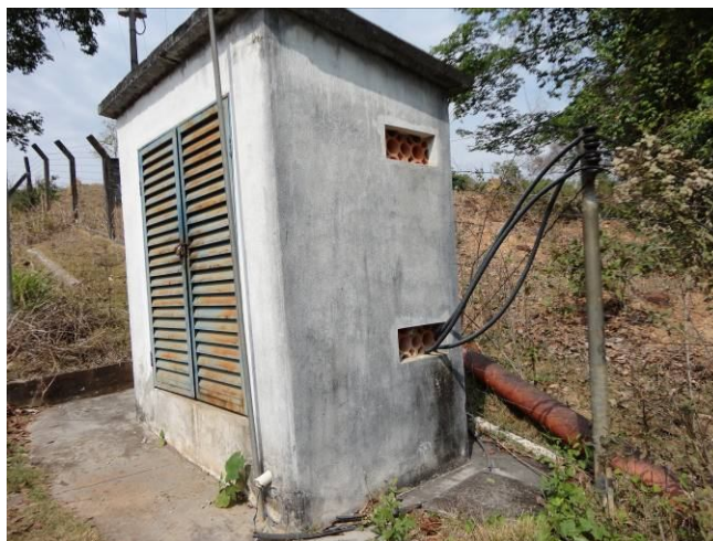
Figura 36 – Casinha para proteção quadro de comando da bomba
