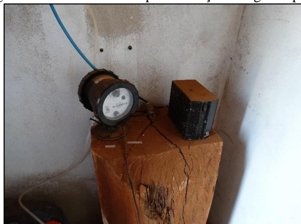
Figura 9. Bomba dosadora para cloração da água captada
