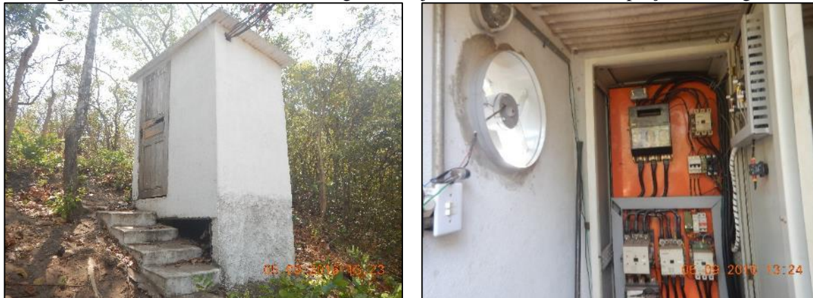
Figura 10. Quadro de comando e abrigo do conjunto motor-bomba da captação rio Araguaia
