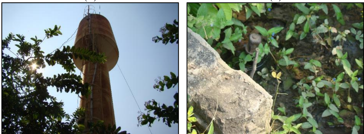
Figura 63. Reservatório metálico 40 m 3 (A) e vazamento de água na base do reservatório (B) (A) (B)
