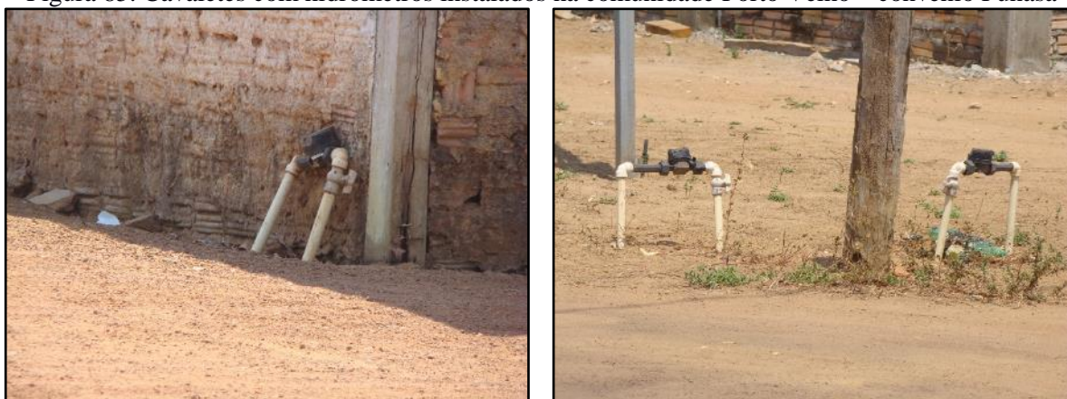
Figura 85. Cavaletes com hidrômetros instalados na comunidade Porto Velho – convênio Funasa
