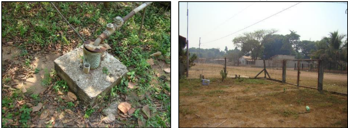
Figura 62. Vista do poço tubular com encamisamento geomecânico (A) e área de proteção (B), (A) (B)
