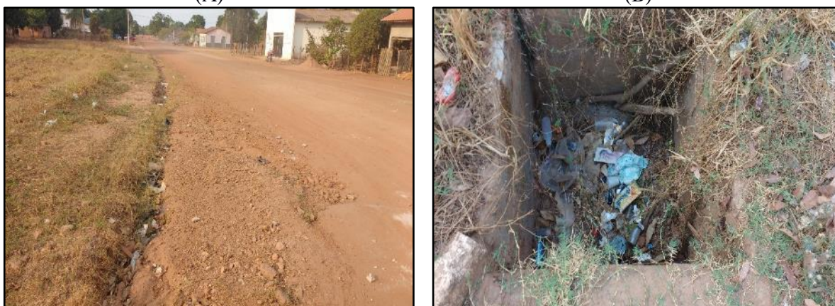
Figura 38. Erosão nas vias do município (A), boca de lobo sem tampa e obstruída (B) (A) (B)
