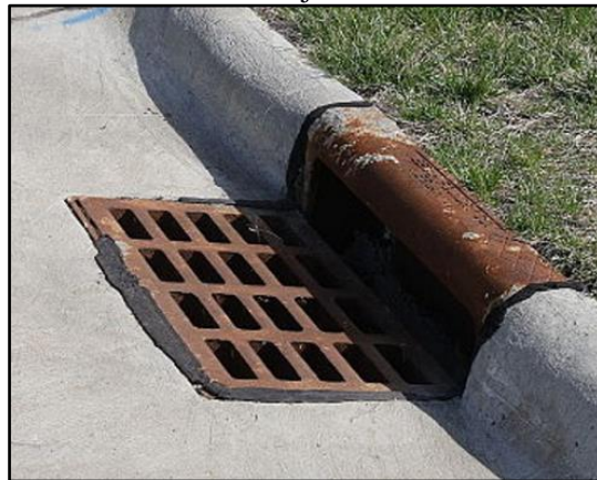
Figura 108. Boca de lobo com gradeamento na sarjeta
