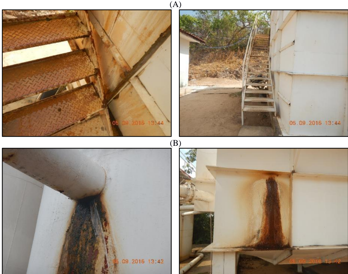
Figura 17. Escada de acesso oxidada e abaulamento na estrutura do floculador (A), pintura desgastada e material oxidado (B)
