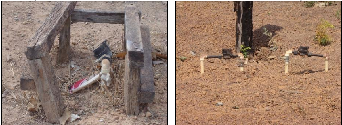
Figura 78. Cavaletes com hidrômetros instalados na comunidade Paulista do Araguaia
