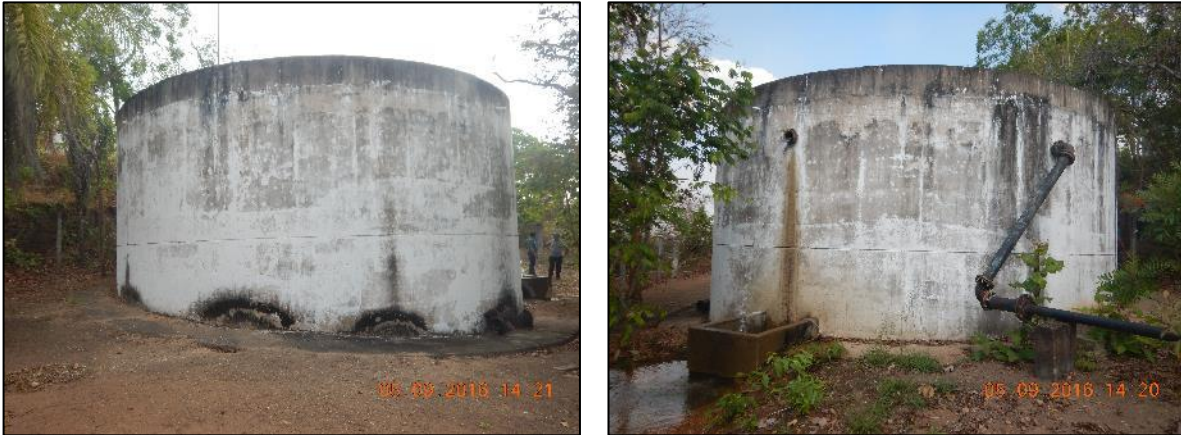
Figura 18. Reservatório ativo do sistema de abastecimento – RAP 01
