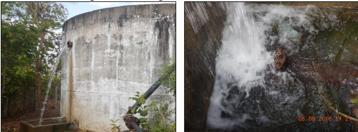
Figura 19. Perda de água no extravasor do reservatório
