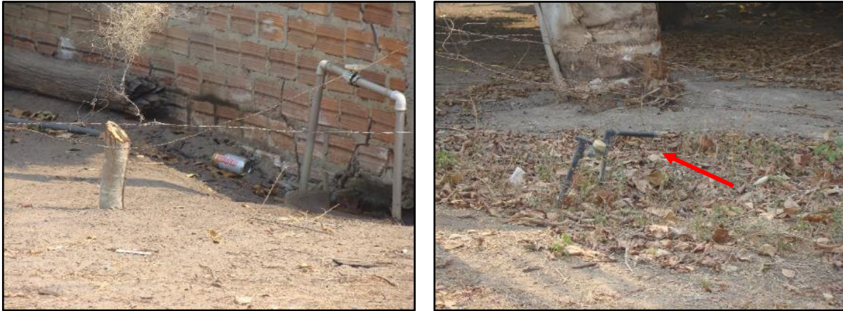
Figura 64. Cavaletes de água instalados sem hidrômetro
