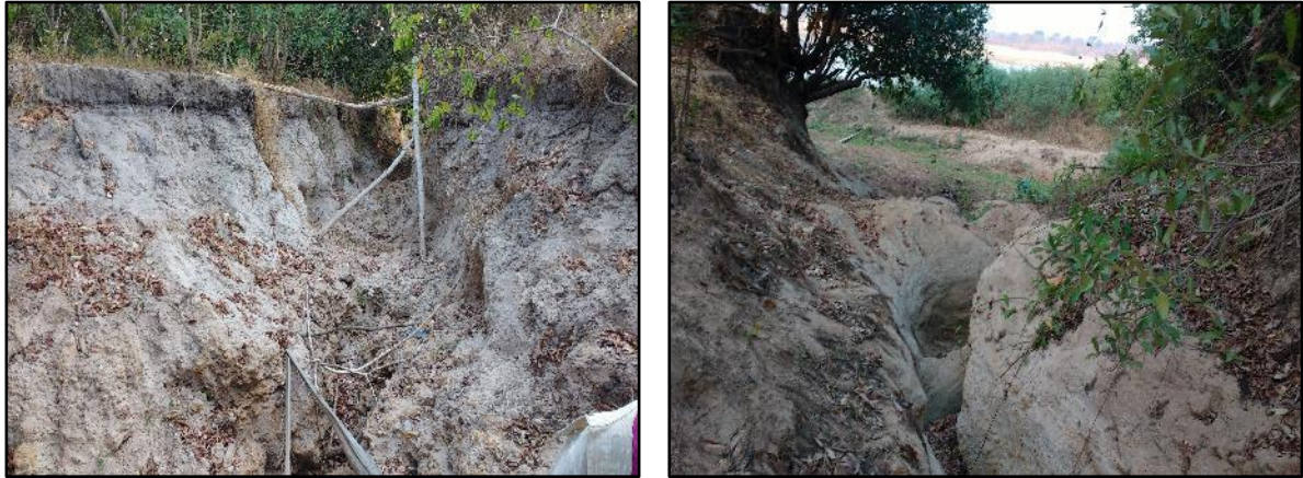
Figura 39. Erosão no canal existente
