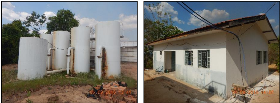
Figura 12. ETA compacta metálica (A) e casa de química da ETA (B) de Santa Terezinha (A) (B)
