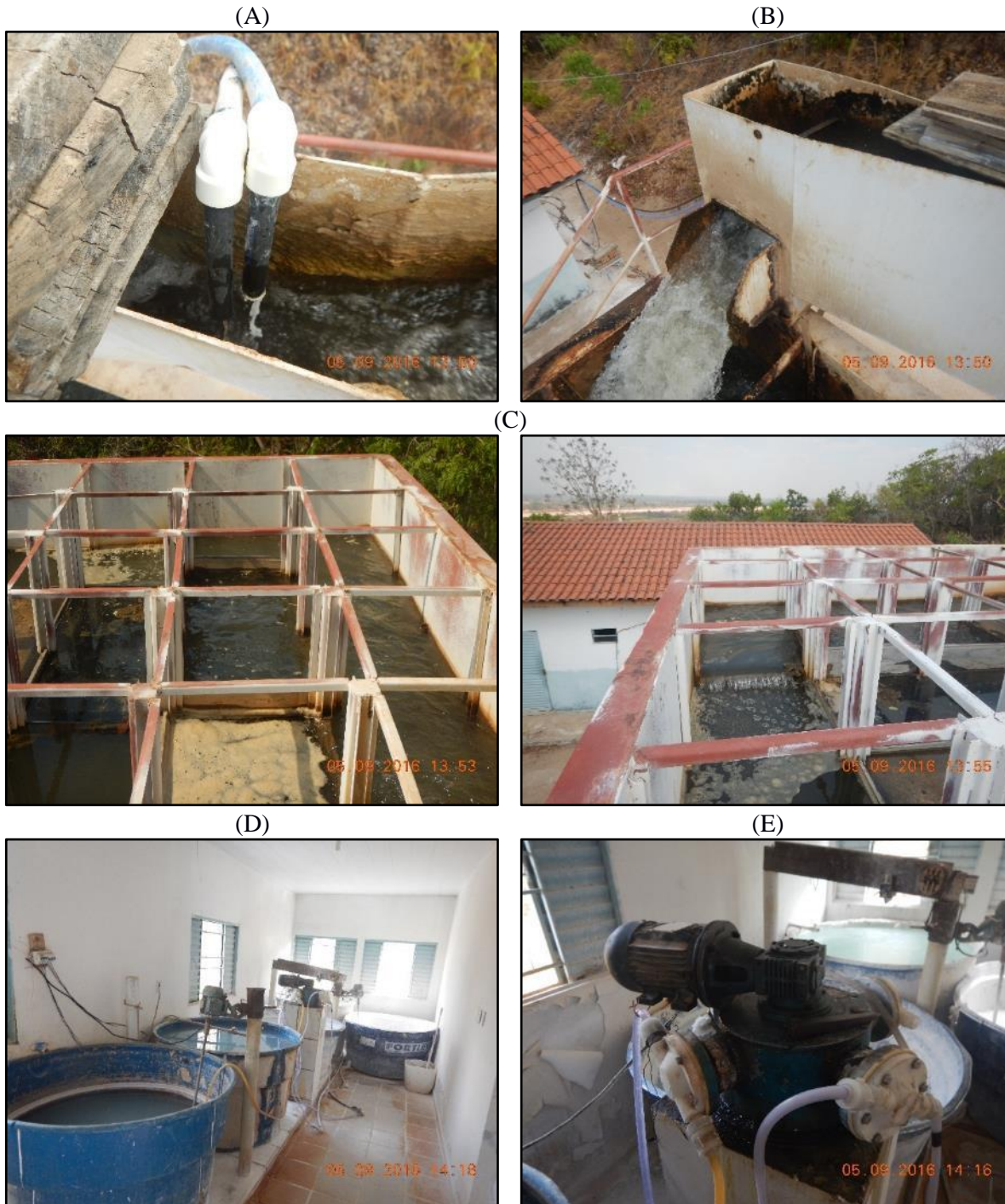
Figura 13. Aplicação do sulfato na calha Parshall da ETA (A), alta vazão na entrada do floclador (B), turbulência constante no processo de floclação (C), tanques misturadores das soluções (D) e bomba dosadora (E)
