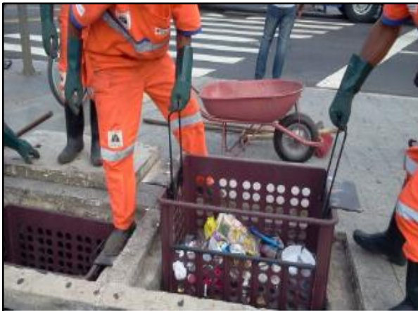
Figura 58. Cesta acoplada a boca do bueiro
