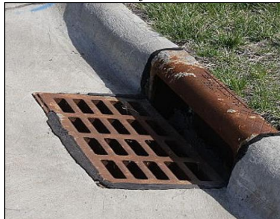
Figura 59. Boca de lobo com gradeamento na sarjeta
