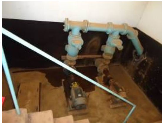
Figura 40 – Conjunto moto bomba.
