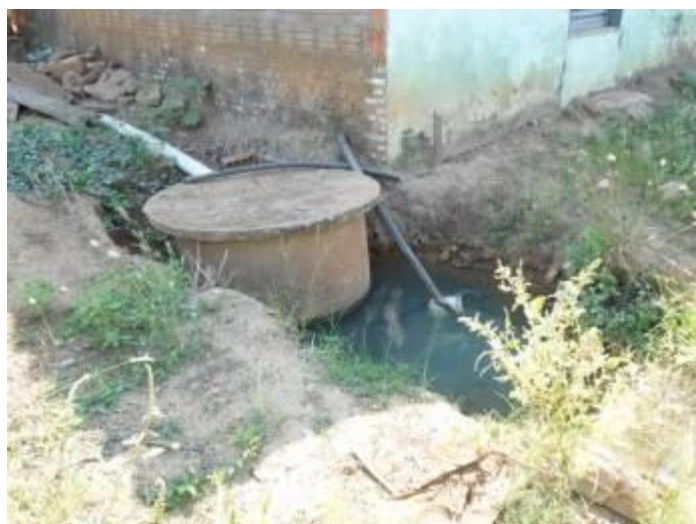
Figura 55 – Fossa séptica com vazamento.
