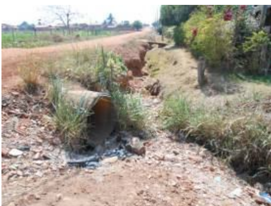
Figura 62- Erosão em via não pavimentada causada pelo lançamento de águas pluviais sem a dissipação de energia.
