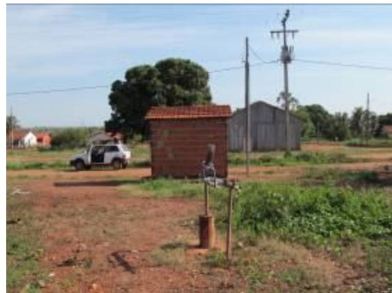
Figura 23 – Poço e clorador.
