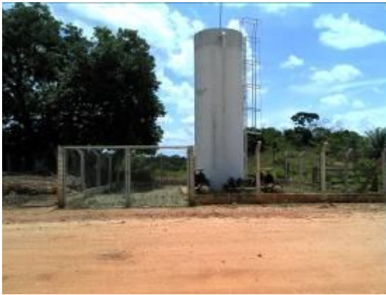
Figura 36 – Elevat de Água Bruta 01.
