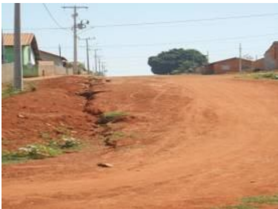
Figura 60 - Início de erosão em via não pavimentada com declividade acentuada.
