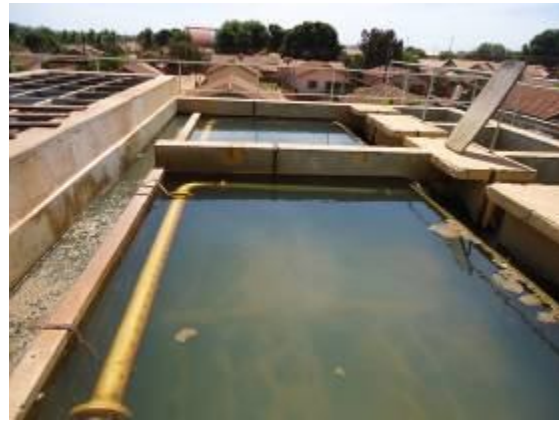
Figura 39 – ETA de concreto.
