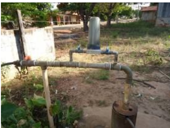
Figura 24 – Poço e clorador.
