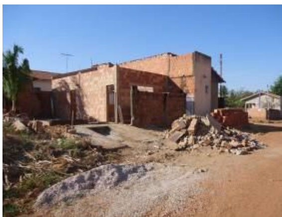
Figura 78 – RCD disposto em via pública não pavimentada – periferia da cidade.
