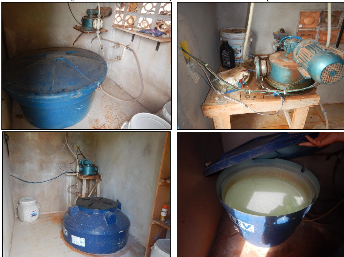
Figura 15. Sistema de desinfecção e bomba dosadora em Sapezal
