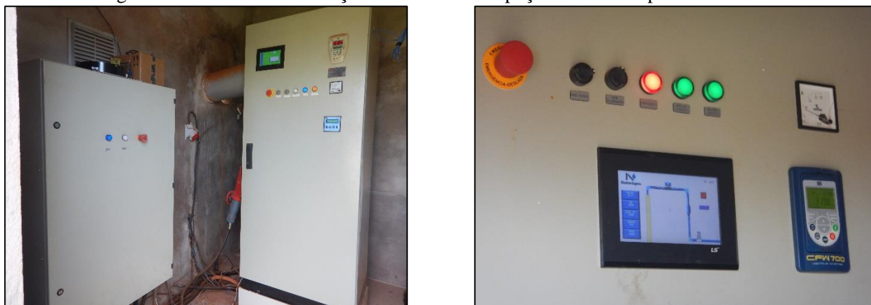
Figura 13. Sistema de automação e telemetria dos poços do SAA Sapezal
