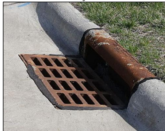
Figura 63. Boca de lobo com gradeamento na sarjeta
