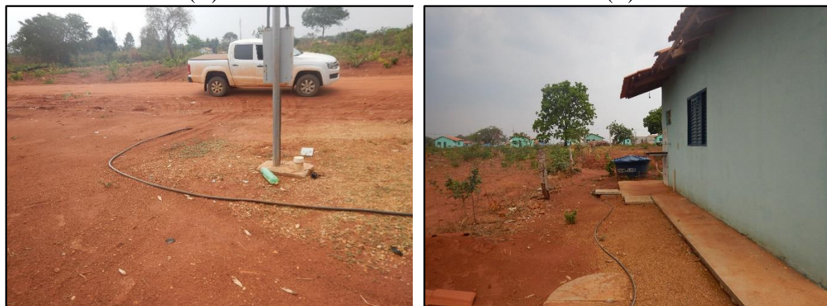
Figura 10. Tubulação PEAD utilizada para distribuição (A), Ligação domiciliar sem hidrômetro (B)
