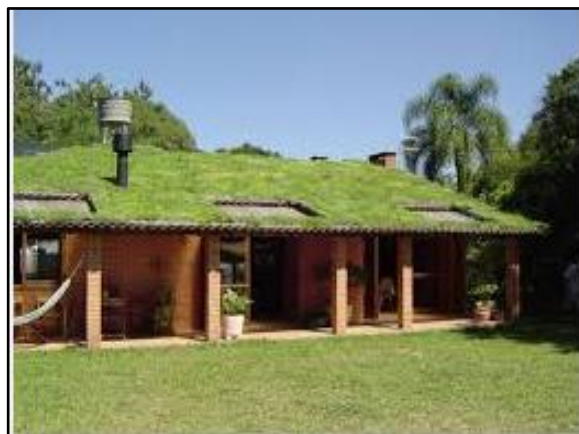
Figura 56. Telhado verde com plantas
