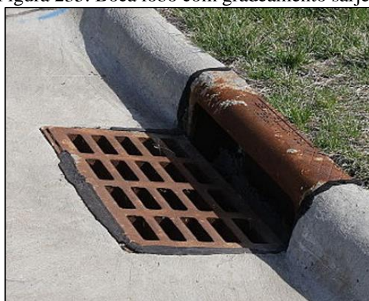
Figura 235. Boca lobo com gradeamento sarjeta
