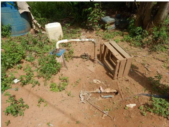
Figura 209. Poço e reservatório individual
