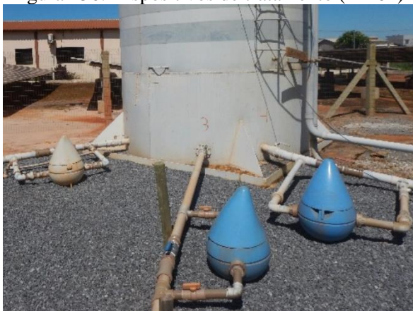
Figura 156. Dispositivos de tratamento (PT-01)
