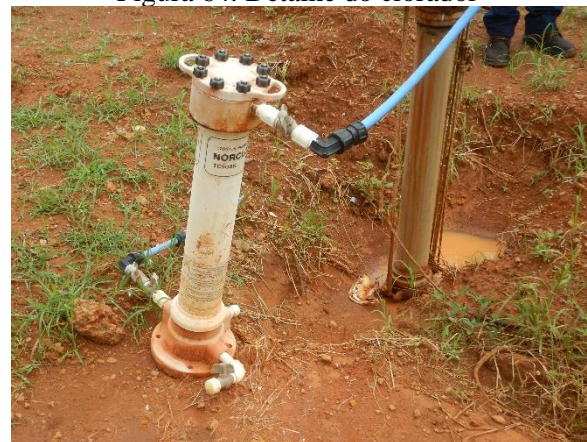
Figura 64. Detalhe do clorador
