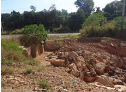
Figura 91. Erosão no bueiro canal terra MT-242
