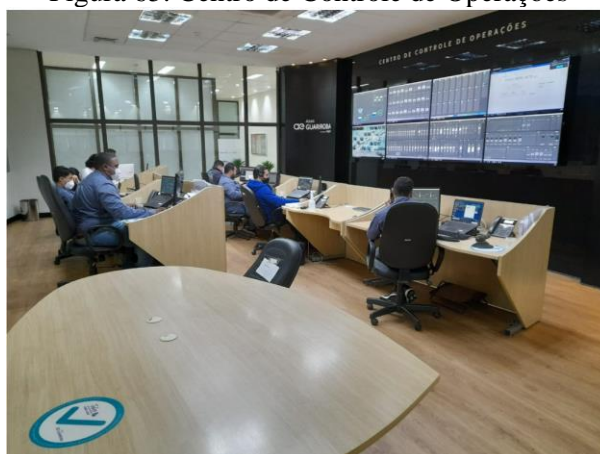
Figura 65. Centro de Controle de Operações
