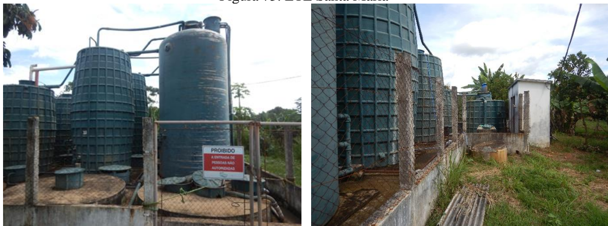
Figura 75. ETE Santa Maria
