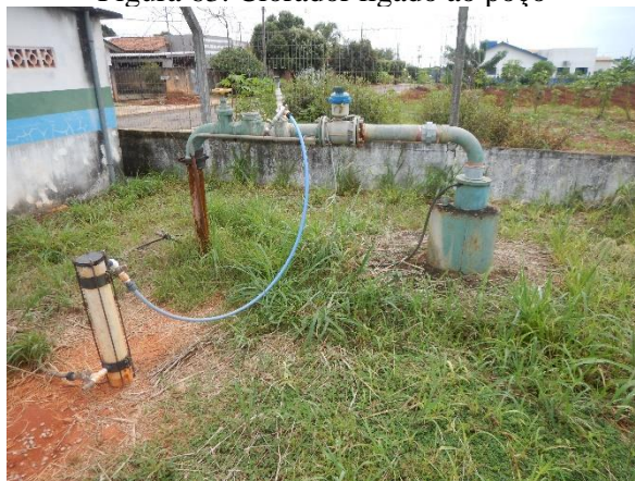
Figura 63. Clorador ligado ao poço
