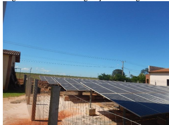
Figura 164. Sistema de geração de energia solar
