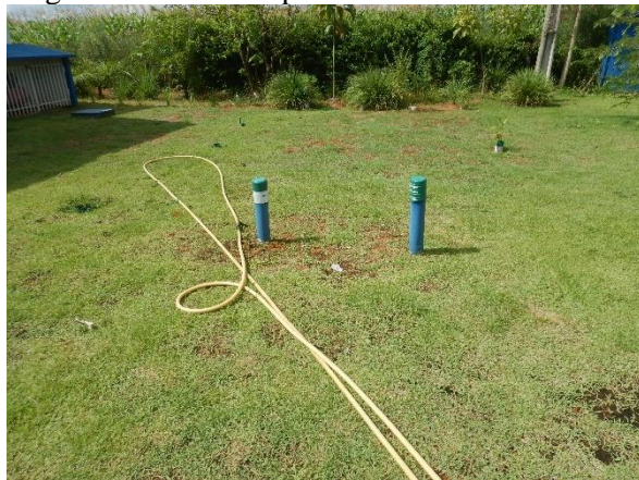
Figura 210. Fossa séptica da Unidade de Saúde
