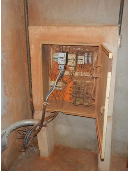
Figura 161. Painel de Controle (PT-01)
