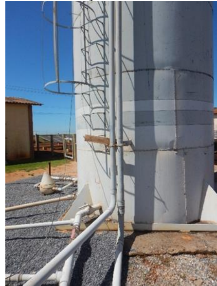
Figura 155. Tubulação de saída do reservatório
