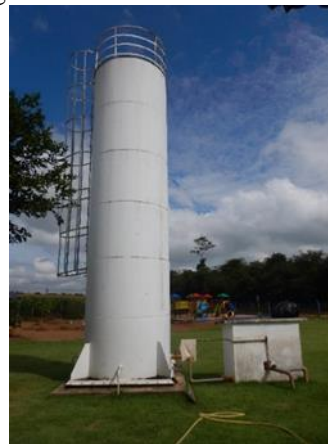
Figura 208. Reservatório da Escola
