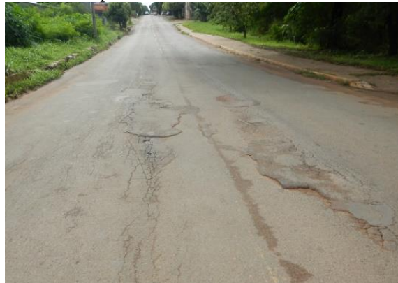
Figura 104. Fissuras no pavimento local do BCCA da Avenida Mário Raiter
