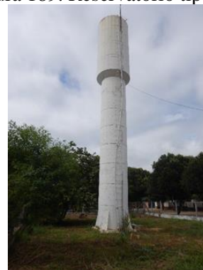
Figura 189. Reservatório tipo taça
