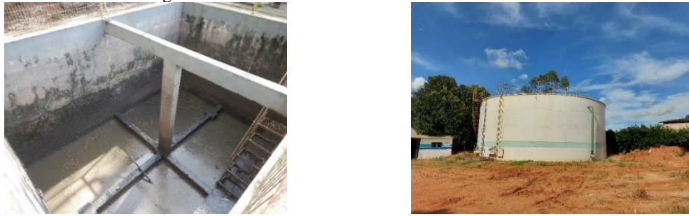
Figura 72. Desarenador e reator UASB – ETE Central
