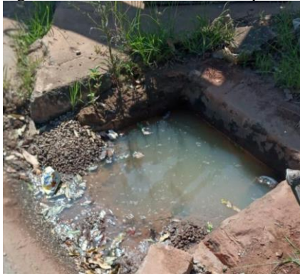
Figura 105. Boca lobo obstruída por RS
