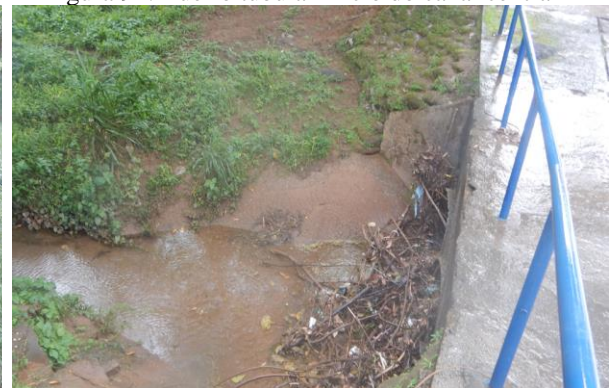
Figura 94. Bueiro tubular início do canal central
