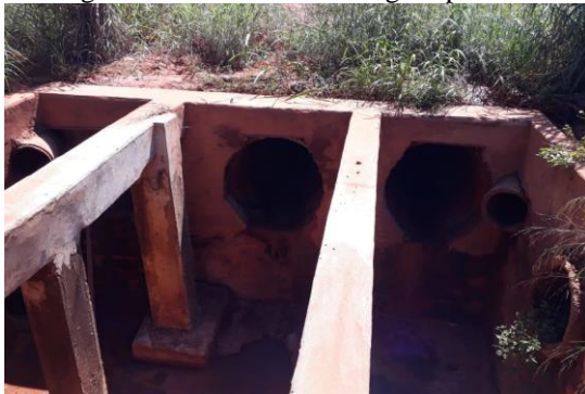
Figura 167. Caixa coletora águas pluviais
