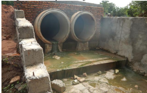
Figura 100. Dissipador energia Bairro São José
