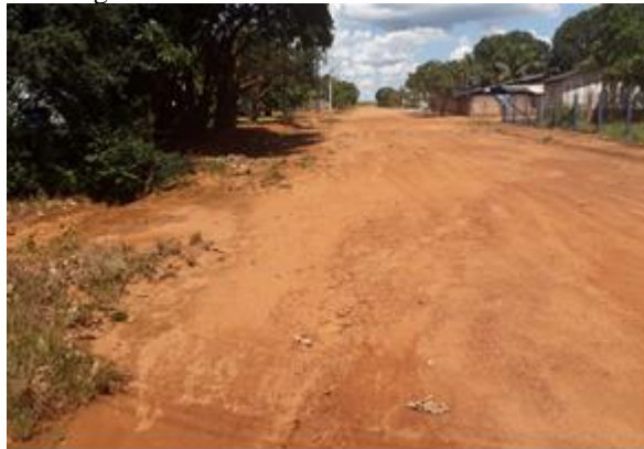
Figura 181. Sinais de erosão na Rua Cinco
