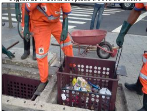
Figura 234. Cesta acoplada à boca do bueiro
