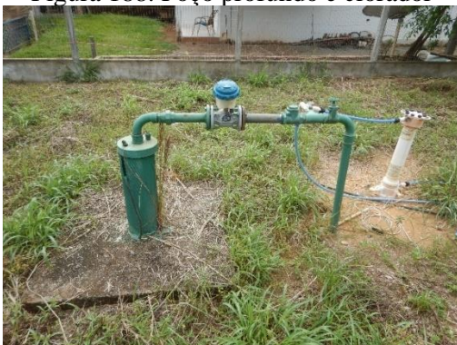
Figura 188. Poço profundo e clorador
