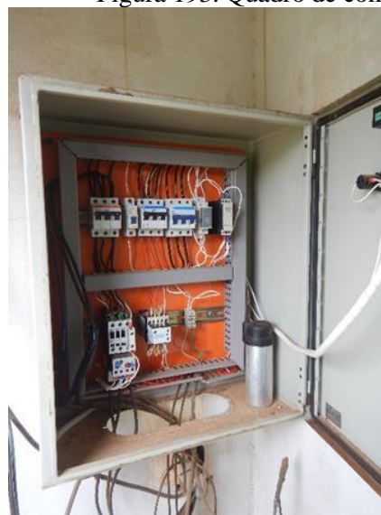
Figura 193. Quadro de comando
