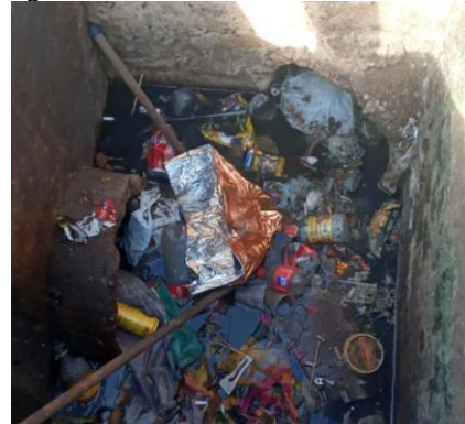
Figura 106. Boca lobo obstruída com RS
