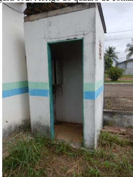
Figura 192. Abrigo do quadro de comando
