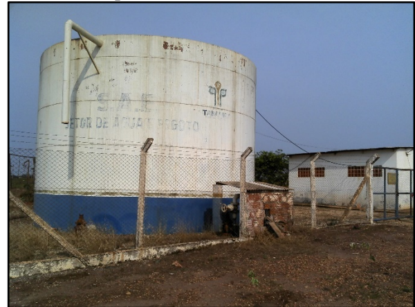
Figura 63. Reservatório de 200 m 3 de capacidade, material metálico e forma cilíndrica, sendo apoiado no solo, Nova Fronteira
