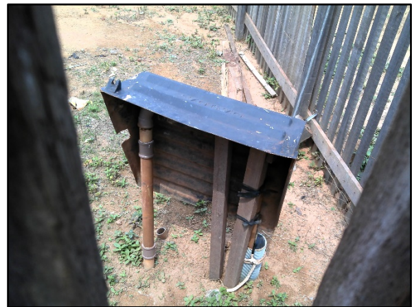
Figura 69. Vista do poço de captação, sem laje de proteção e sem macromedidor, Americana do Norte, Tabaporã-MT
