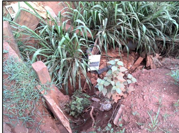
Figura 41. Boca de lobo sem a tampa de concreto na rua Sandra, Tabaporã-MT
