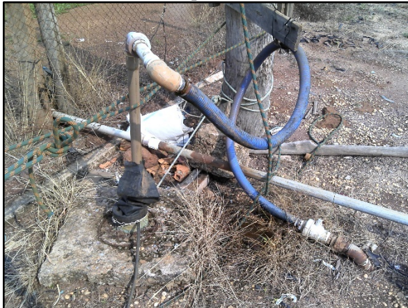
Figura 62. Poço 1 utilizado para captação do sistema de abastecimento de Nova Fronteira, Tabaporã-MT
