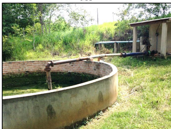
Figura 6. Captação na Nascente 01, Tabaporã - MT
