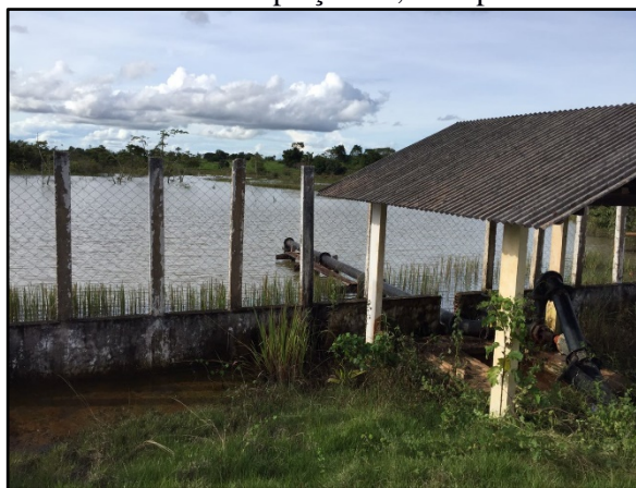
Figura 14. Vista do abrigo do conjunto motobomba da captação 03, Tabaporã-MT
