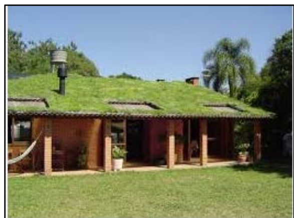
Figura 92. Telhado verde com plantas
