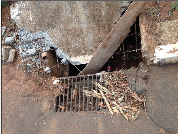
Figura 40. Boca de lobo deteriorada apresentando risco de acidente aos pedestres, na Av. Zé Paraná Tabaporã-MT
