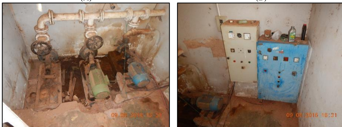
Figura 25. Bomba pressurizadora (A) e quadro de energia (B) (A) (B)
