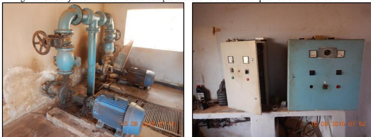
Figura 18. Conjunto motobomba da estação elevatória existente e quadros de comando na ETA
