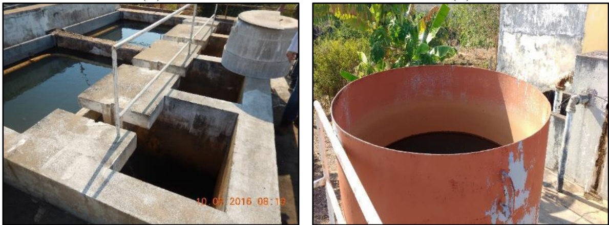
Figura 15. Filtros da ETA de concreto (A), ETA metálica (B) (A) (B)
