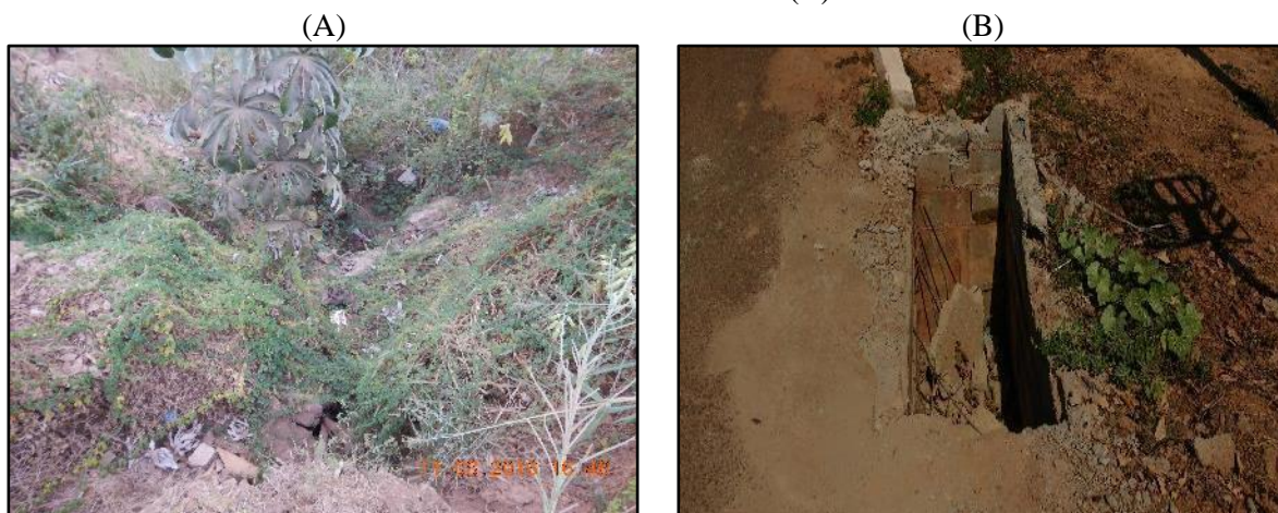
Figura 48. Erosão ocasionada pela ausência de dissipadores no final da galeria de água pluvial (A), boca de lobo danificada (B)
