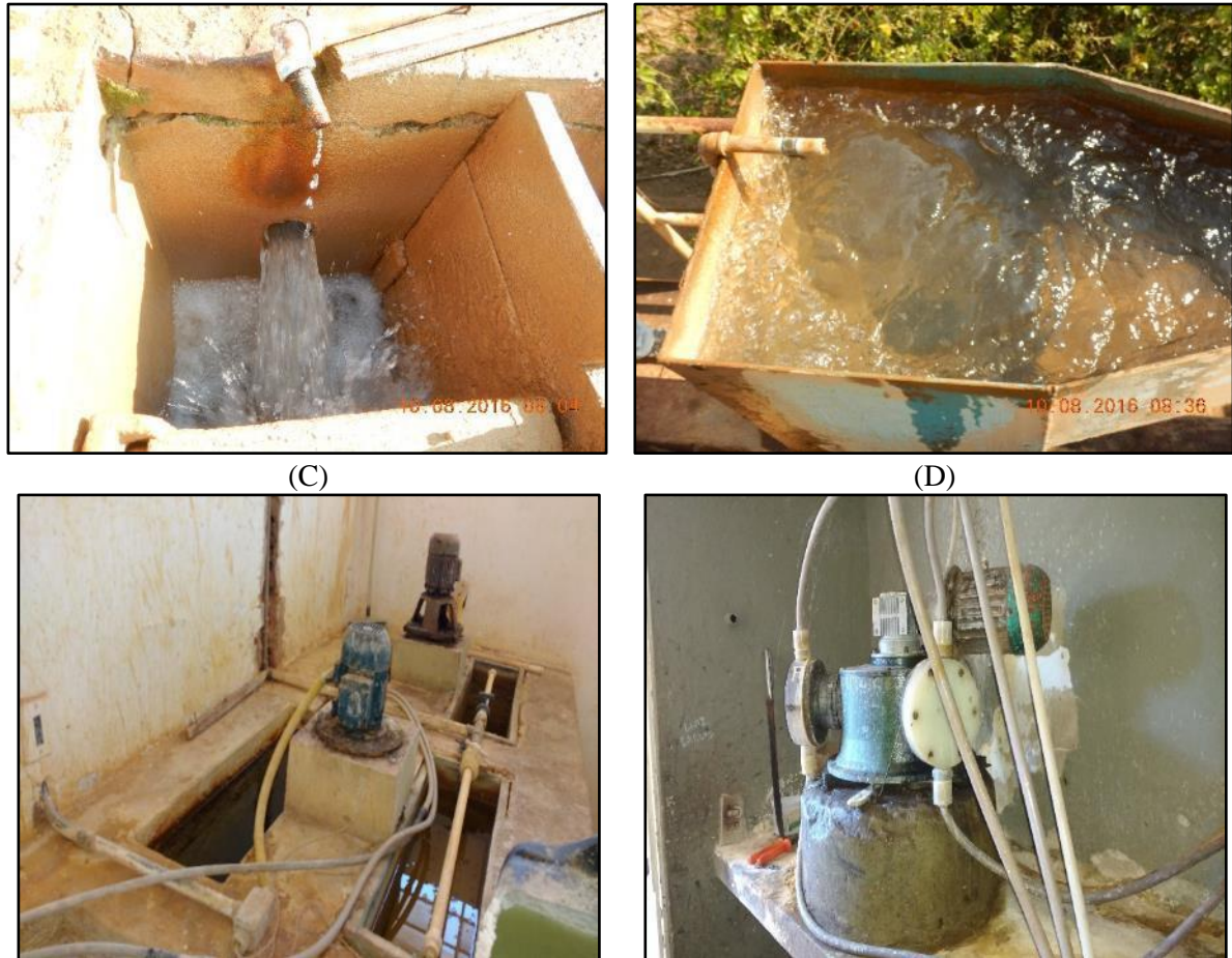
Figura 13. Aplicação do sulfato na entrada da ETA concreto (A), ETA metálica (B), misturador da solução de sulfato de alumínio (C) e bomba dosadora (D)
