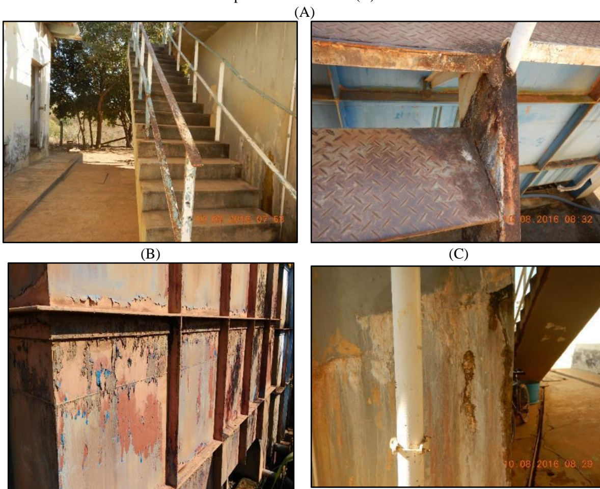
Figura 17. Corrimão da escada de acesso e guarda-corpo oxidados (A), pintura desgastada (B) e paredes danificadas (C)
