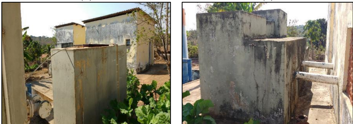
Figura 16. Câmara de contato para cloração (A) e caixa de acumulação para bombeamento (B) (A) (B)
