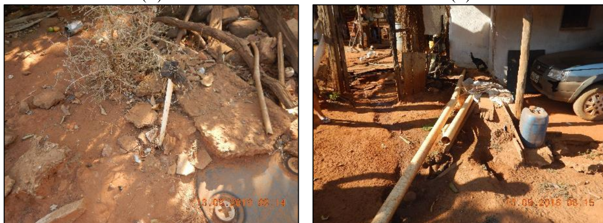
Figura 79. Vista do suspiro da fossa rudimentar (A) e água servida lançada a céu aberto (B)
