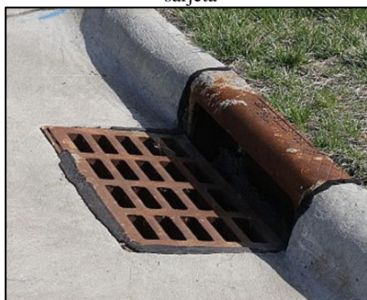
Figura 107. Boca de lobo com gradeamento na sarjeta
