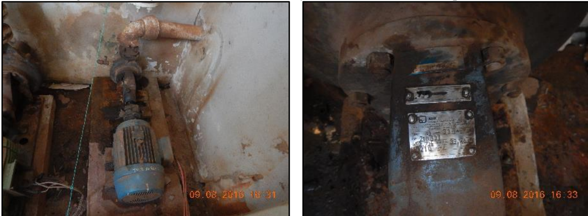
Figura 19. Conjunto motobomba da estação elevatória do RAP-01 para RAP-02
