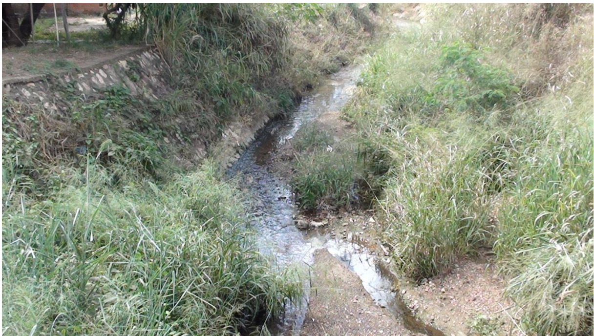
Figura 14 – Curso d'água com taludes em concreto (Revestimento Degradado e com presença de Vegetação Invasora) – Coord. UTM 8271846N, 589333L
