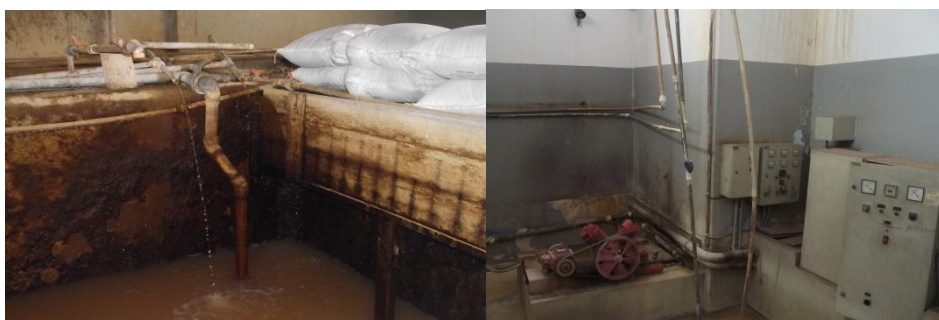
Figura 17 - Tanque De Mistura De Sulfato e Bombeamento Sulfato De Alumínio
