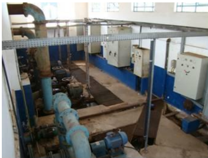
Figura 12 - ETA 1 – casa de bombas
