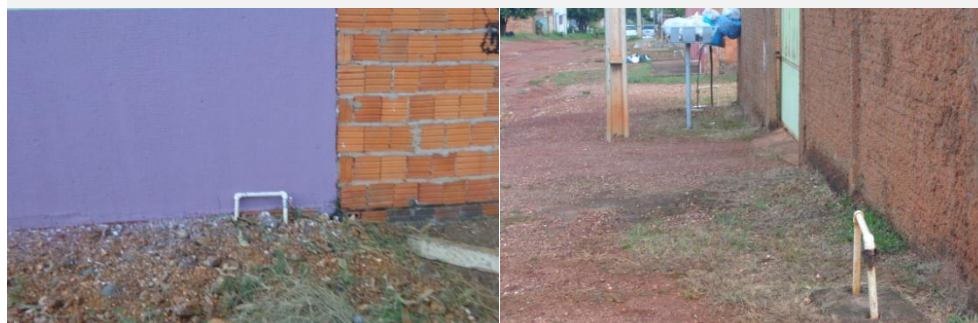
Figura 24 - Ligação irregular no sistema de abastecimento de água
