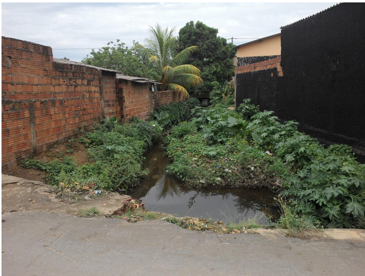
Figura 6 - Residência Muito Próxima de Curso D'água (jusante do bueiro) – Coord. UTM 8266779N, 596797L
