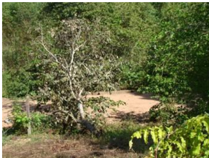
Figura 17 - Núcleo Habitacional Santa Isabel – Sub-bacia 02 - Sistema fossa/filtro desativado.
