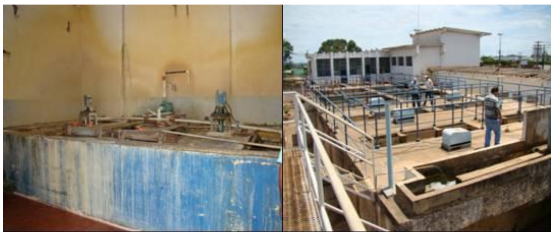
Figura 10 - ETA 1 – Tanque preparo e Vista geral da ETA 1
