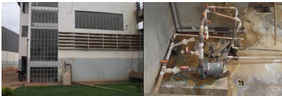
Figura 15 - Chegada de água bruta ETA 2 e Bombeamento de coagulantes na ETA 2
