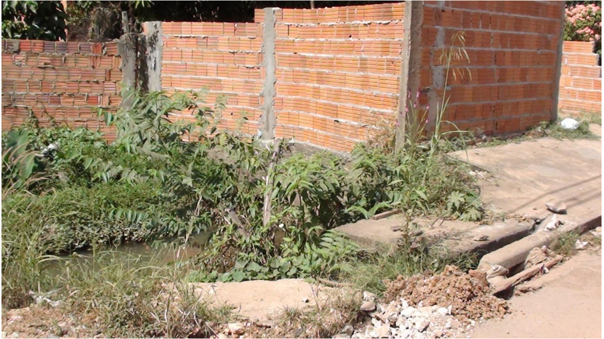
Figura 4 - Residência Sobre Curso D'água - Coord. UTM 8271153N, 588823L
