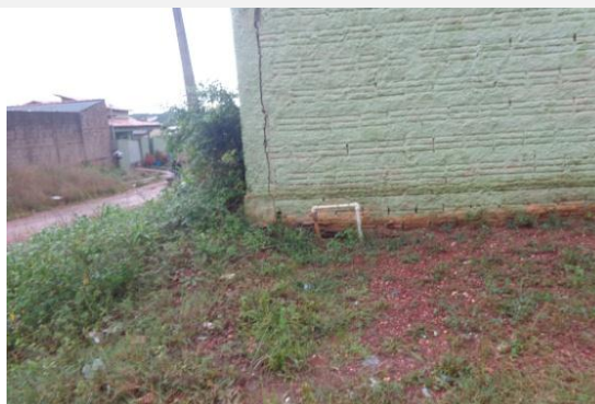
Figura 23 - Ligação irregular no sistema de abastecimento de água
