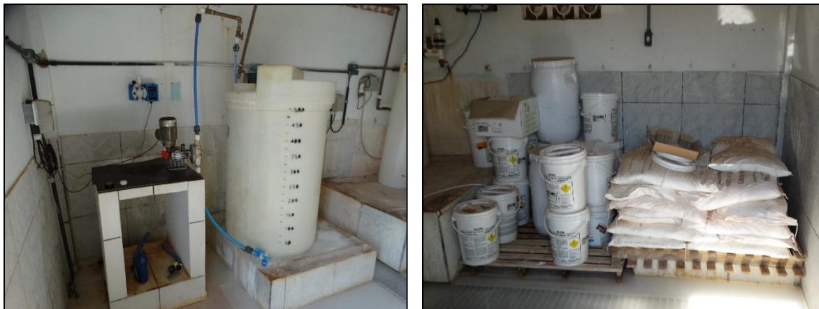
Figura 35 - Casa de química e da ETA de Tratamento de água – Cloração
