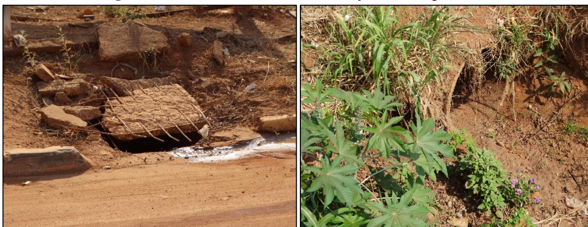
Figura 55. Problemas visíveis de manutenção na drenagem em Vera
