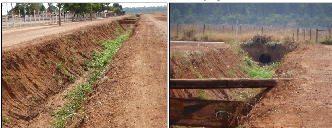
Figura 54. Canal de escoamento da água pluvial de Vera
