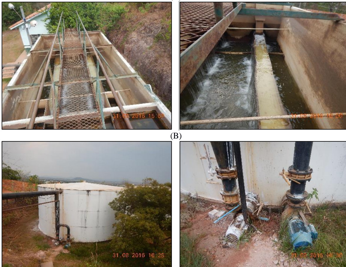
Figura 20. Filtro de fluxo descendentes (A) e sistema de bombeamento para retrolavagem (B)
