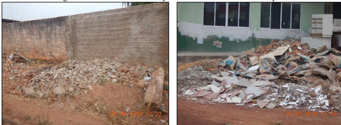
Figura 71. Resíduos da construção civil acondicionados nas calçadas
