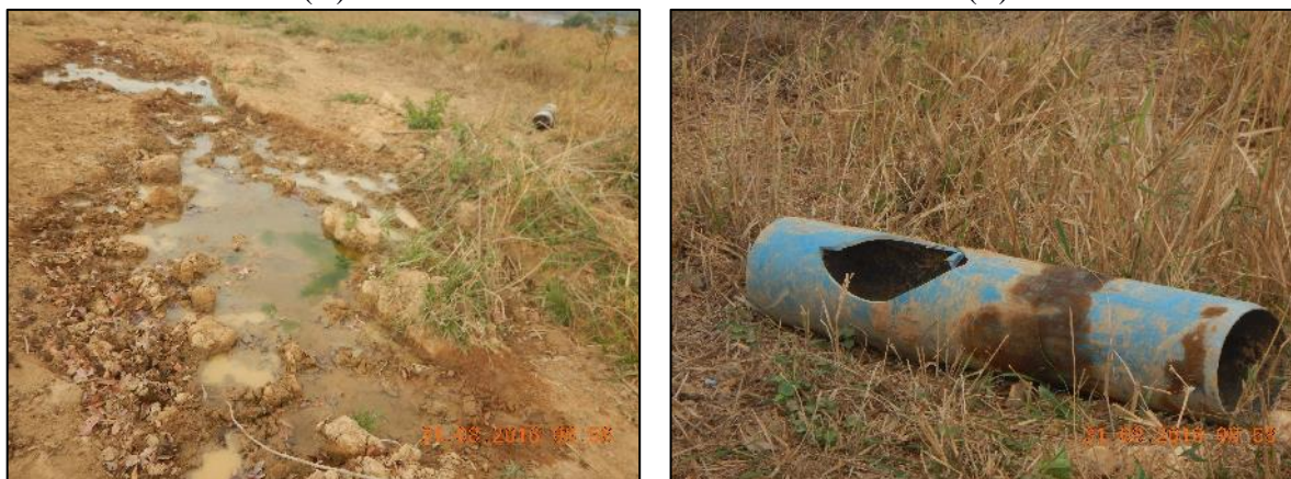
Figura 16. Vazamentos visíveis ao solo (a) e tubulação da adutora substituída - danificada (B)
