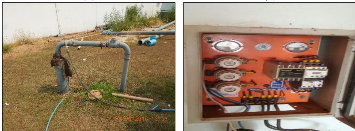
Figura 13. Vista do poço PT-01(A) e quadro de comando do poço (B)
