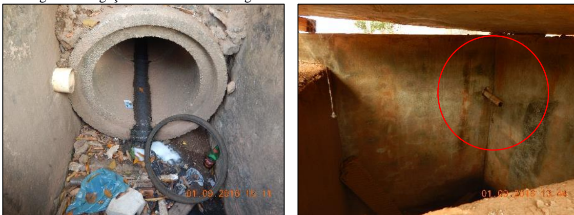
Figura 50. Ligações clandestinas de esgoto em bocas de lobo do núcleo urbano de Vila Rica
