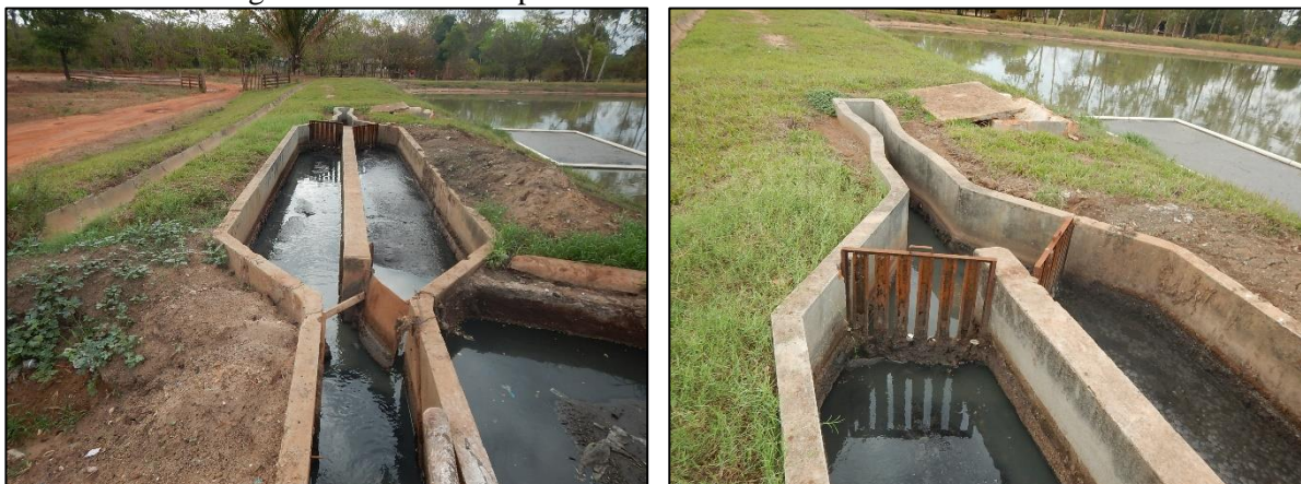
Figura 34. Tratamento preliminar com Calha Parshall e desarenador
