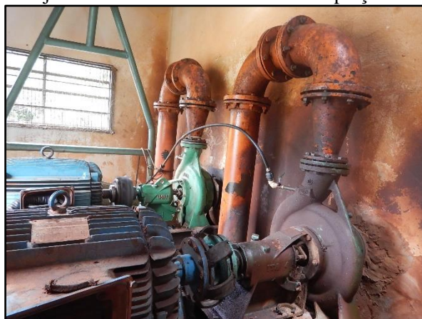
Figura 11. Conjuntos motobomba da EEAB da captação no rio Perdido
