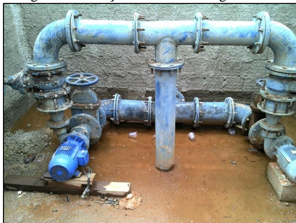
Figura 26. Estação elevatória de água tratada
