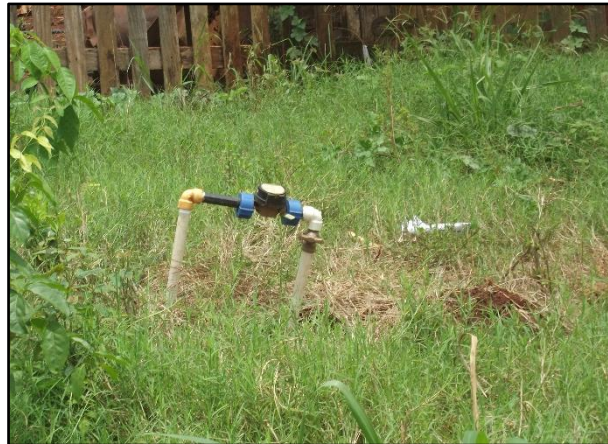
Figura 90. Cavalete com hidrômetro, Terra Roxa, Juína-MT
