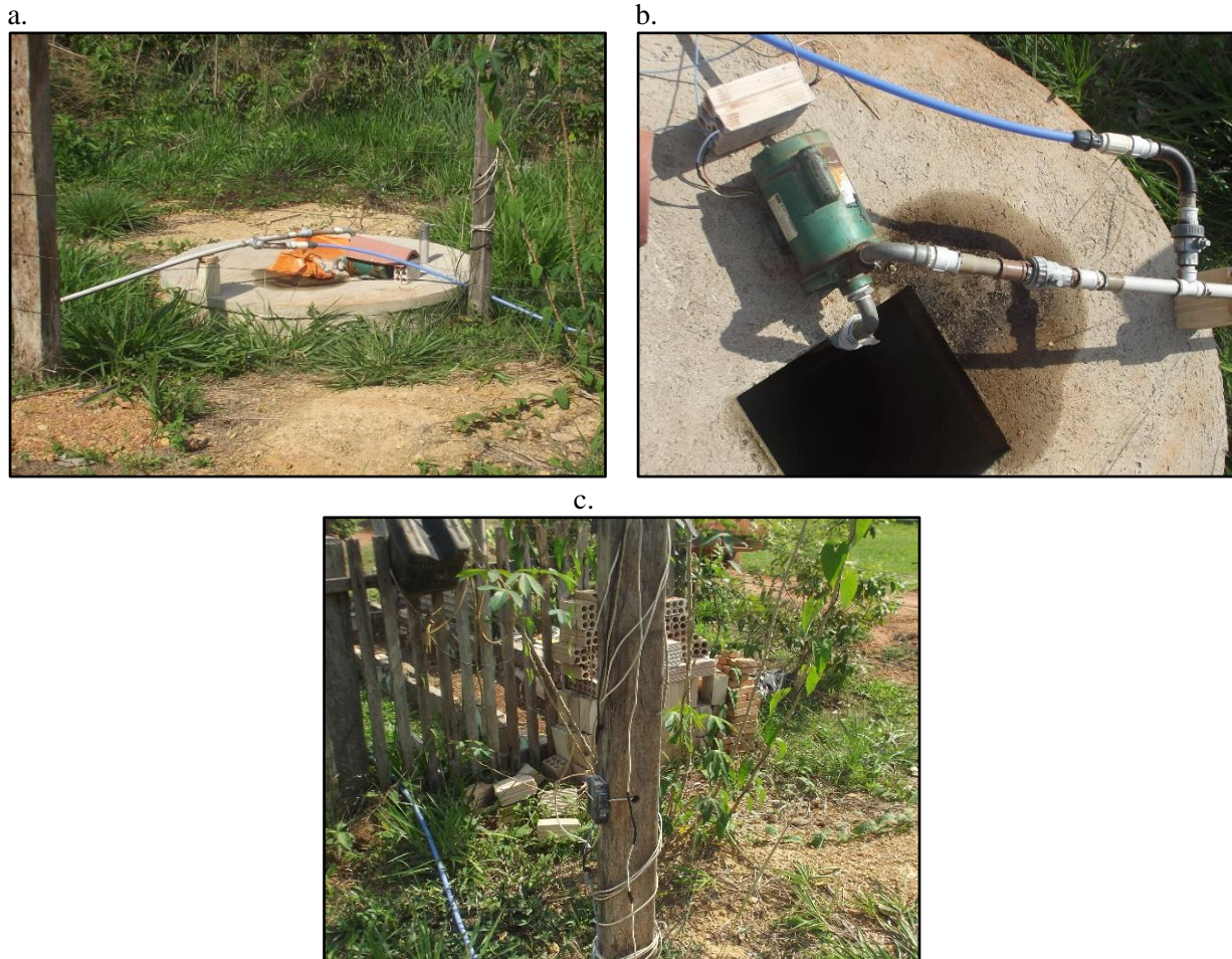
Figura 72. Vista de poço freático (a), bomba de sucção de eixo horizontal (b) e acionamento da bomba (c), Fontanillas, Juína-MT
