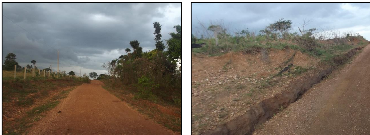
Figura 112. Via não pavimentada (a), processos erosivos (b), Iracema 3, Juína-MT
