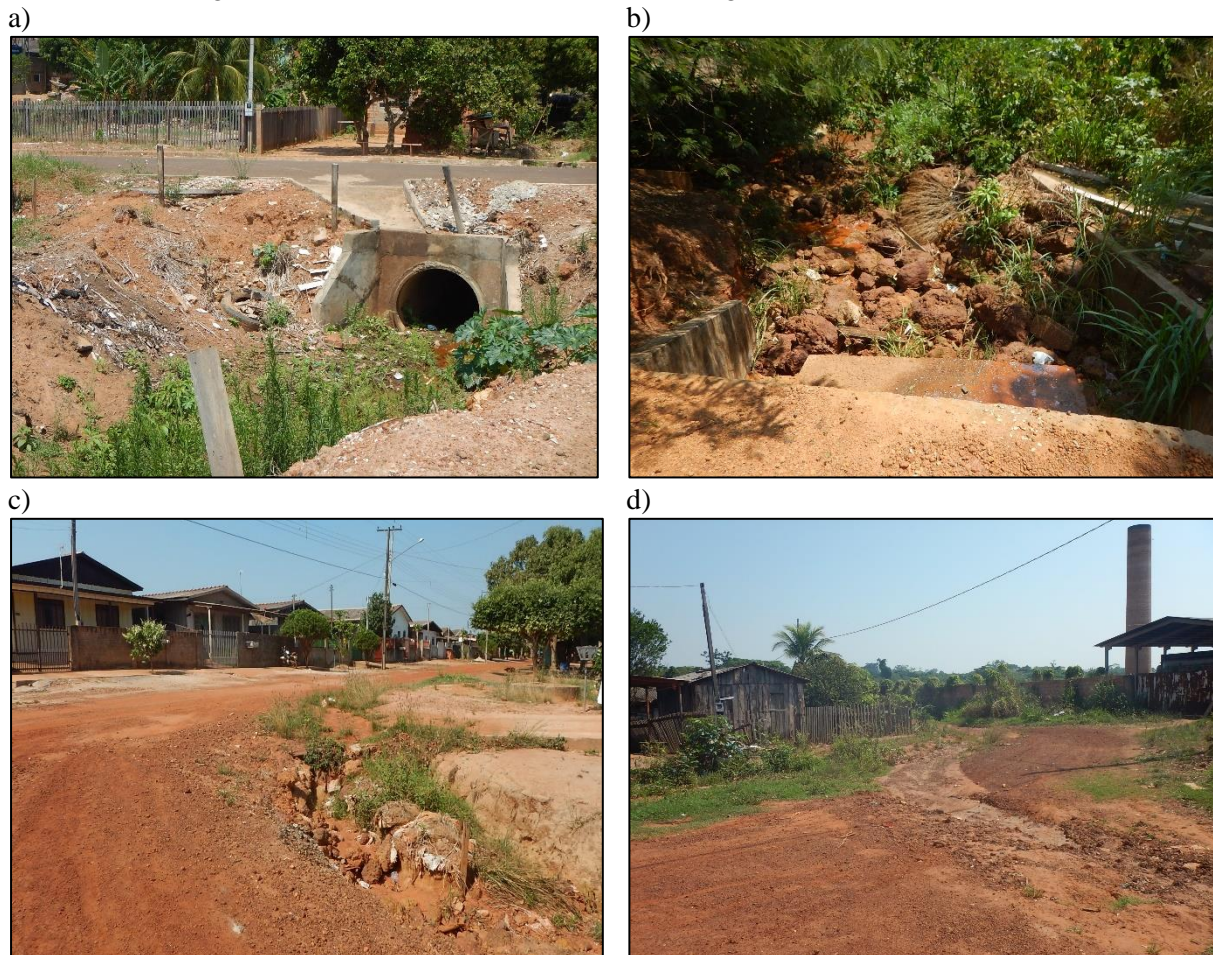
Figura 50. Processos erosivos nas vias e córregos urbanos em Juína-MT
