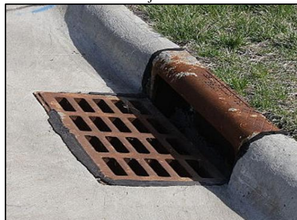
Figura 133. Boca de lobo com gradeamento na sarjeta
