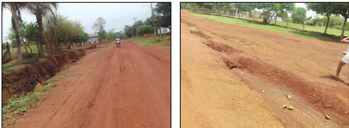
Figura 92. Via não pavimentada (a) e processos erosivos (b), Terra Roxa, Juína -MT
