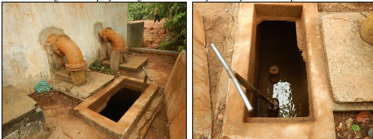
Figura 10. Captação de água em Juína – Poço de sucção da EEAB para as ETAs
