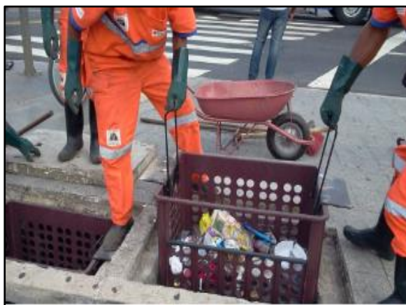
Figura 132. Cesta acoplada à boca do bueiro
