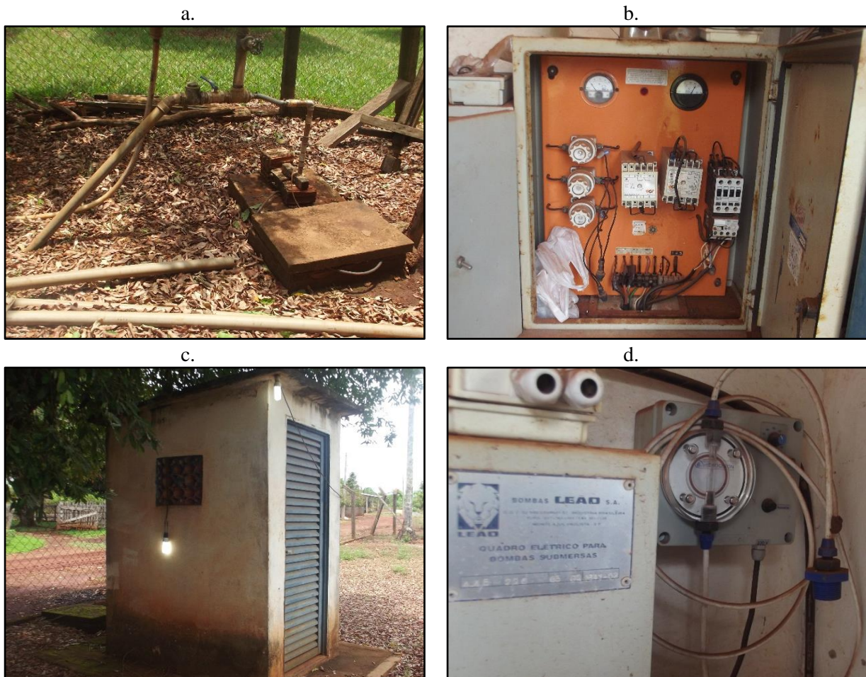
Figura 88. Vista da boca do poço tubular e do cavalete (a), quadro de comando (b), abrigo em alvenaria (c) e dosador de cloro (d), Terra Roxa, Juína-MT
