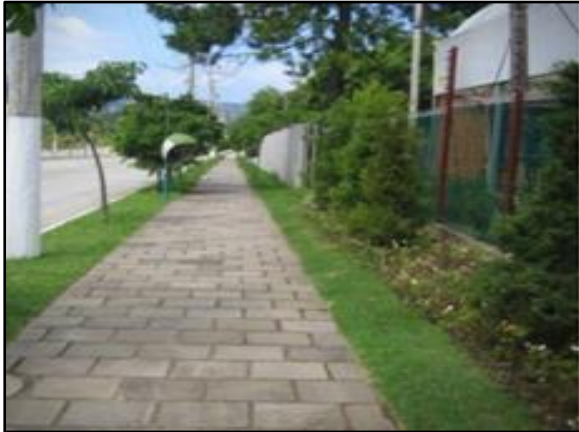
Figura 142. Vala de retenção ao longo da rua
