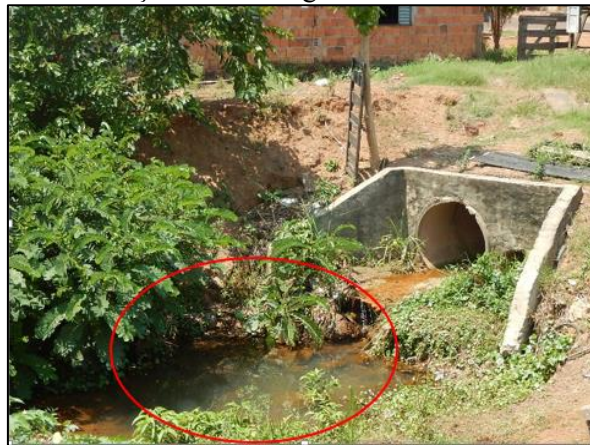
Figura 48. Lançamento de esgoto “in natura” em córregos
