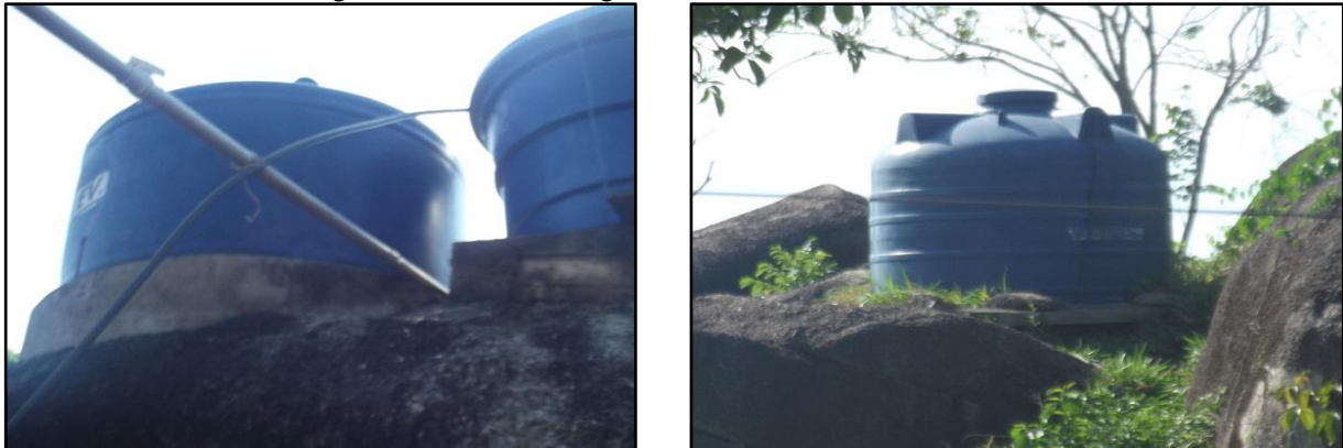
Figura 104. Caixas d'água de fibra, Iracema 2, Juína-MT
