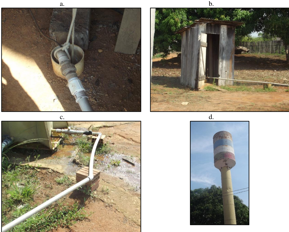
Figura 81. Vista da boca do poço tubular (a), abrigo (b), adutora (c) e reservatório (d), Filadélfia, Juína-MT
