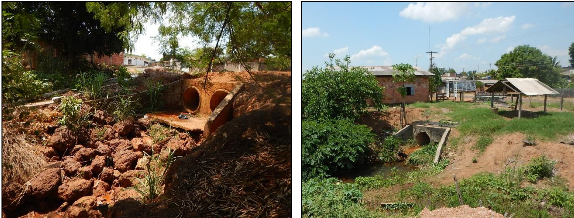
Figura 46. Dispositivos de microdrenagem e erosão Juína-MT
