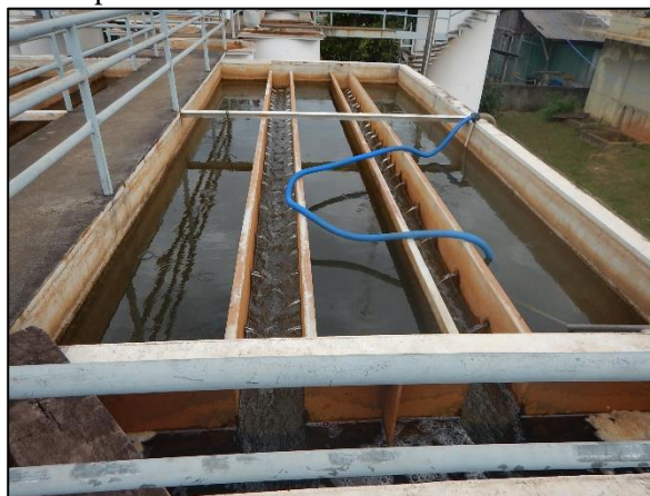
Figura 17. Visão superior do decantador de alta taxa e lonas de decantação
