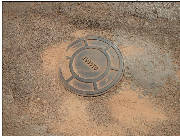
Figura 31. Poço de visita do sistema de esgoto de Juína-MT
