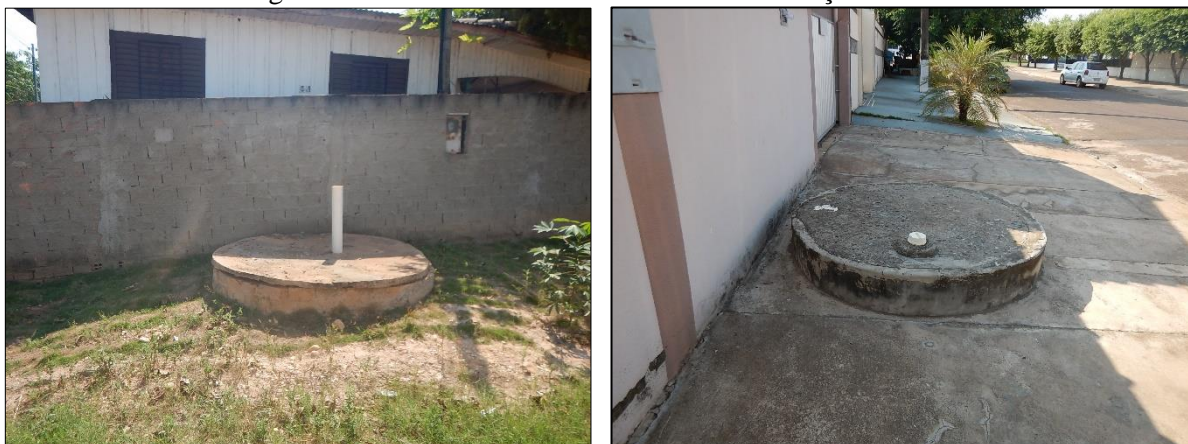
Figura 29. Fossas rudimentares instaladas nas calçadas de Juína
