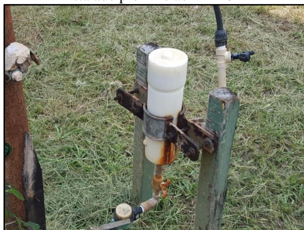
Figura 19. Dosador de cloro do tipo contato instalado próximo ao REL-01
