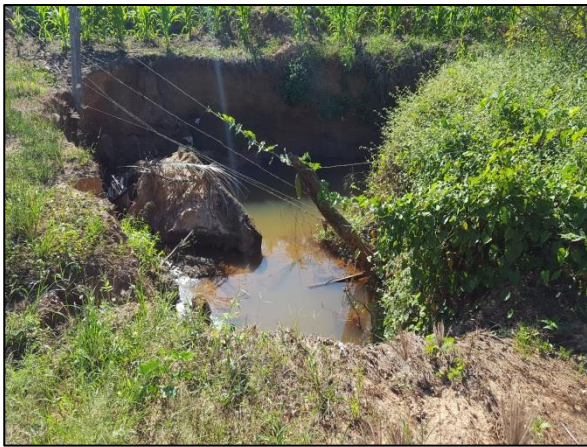
Figura 53. Processo erosivo no leito do corpo hídrico em um terreno na Av. Mato Grosso (8)
