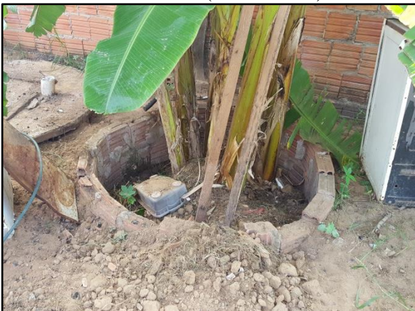
Figura 28. Fossa de bananeira em uma residência localizada na Rua das Corujas, no bairro Recanto dos Pássaros (Setor Centro)
