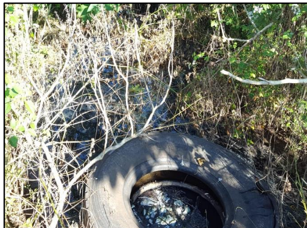
Figura 31. Esgoto transbordando na saída do filtro anaeróbio na ETE do loteamento Itamarati
