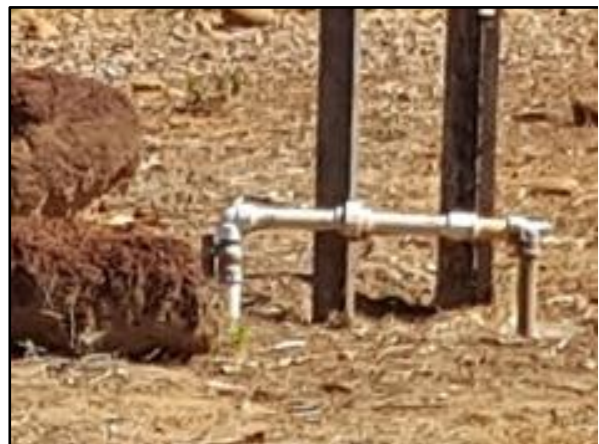
Figura 26. Ligação domiciliar sem hidrômetro na sede urbana de Denise
