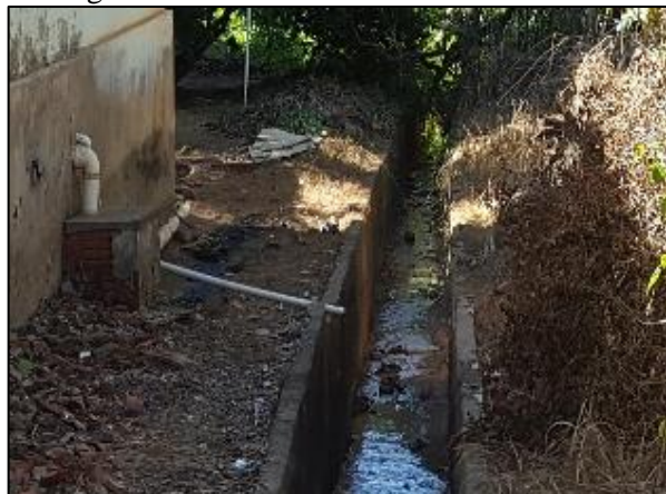
Figura 41. Lançamento de esgoto no canal de drenagem de uma residência na Av. Mato Grosso
