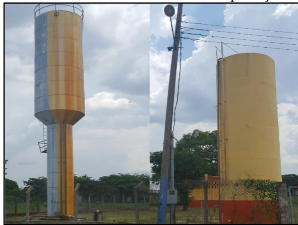
Figura 23. Reservatórios RAP-01 de 40 m 3 e RAP-02 de 100 m 3 do Setor Boa Esperança
