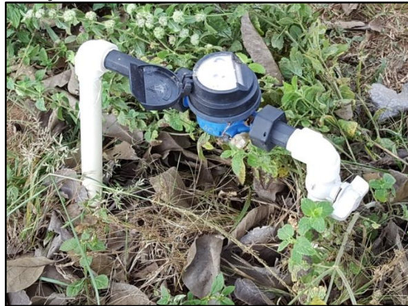
Figura 94. Hdirômetro instalado em uma ligação domiciliar na rede de distribuição da comunidade Banco da Terra, em Denise-MT
