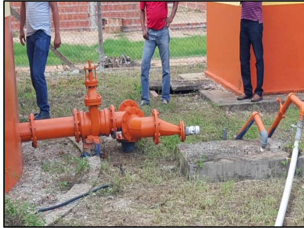
Figura 14. Barrilete para instalação de conjuntos motobomba para distribuição da água do reservatório do Recanto dos Pássaros
