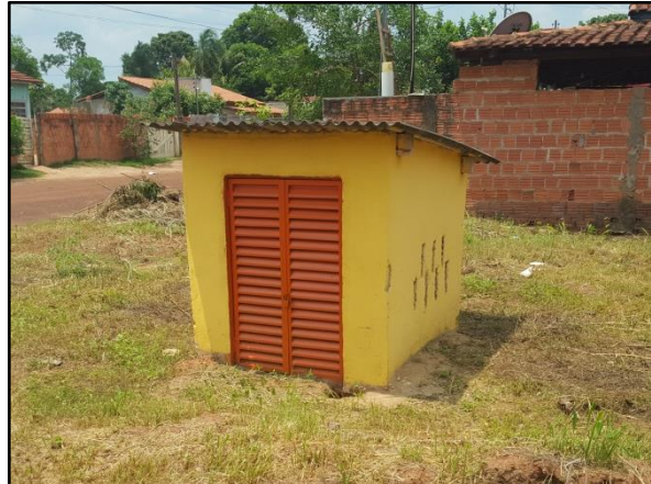
Figura 20. Abrigo do dosador de cloro do tipo contato instalado próximo ao barrilete do PT-Feirinha
