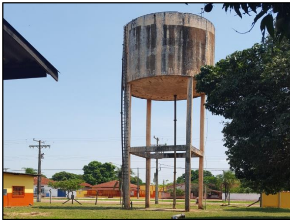
Figura 22. Reservatório REL-01 de 100,0 m 3 do Setor Centro
