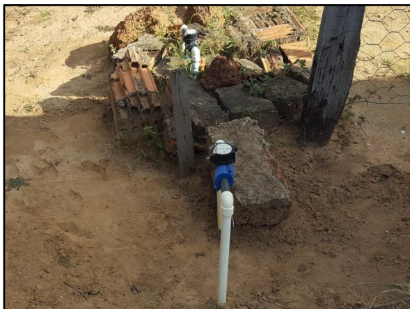
Figura 25. Hidrômetros instalados em ligações domiciliares da sede urbana de Denise
