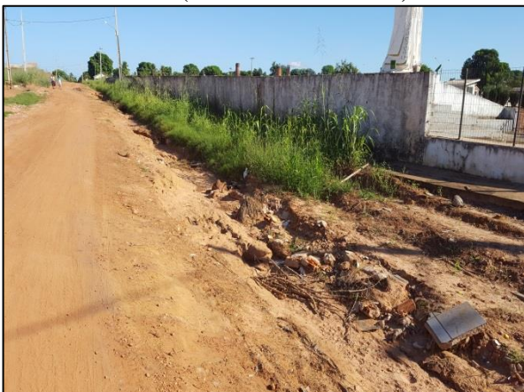
Figura 51. Processo erosivo na Rua Elizeu A. de Lima (ao lado do cemitério)
