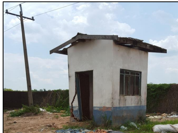
Figura 67. Guarita deteriorada na área do lixão de Denise
