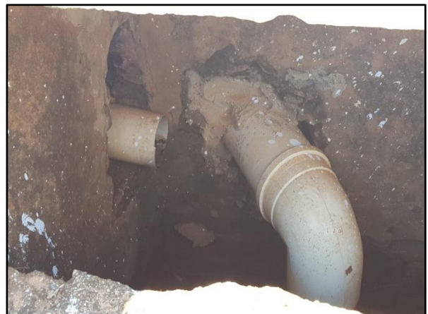
Figura 35. Ligação de esgoto na boca de lobo localizada na esquina da Rua Antônio Alves Teixeira com a Rua Juscelino Kubitschek
