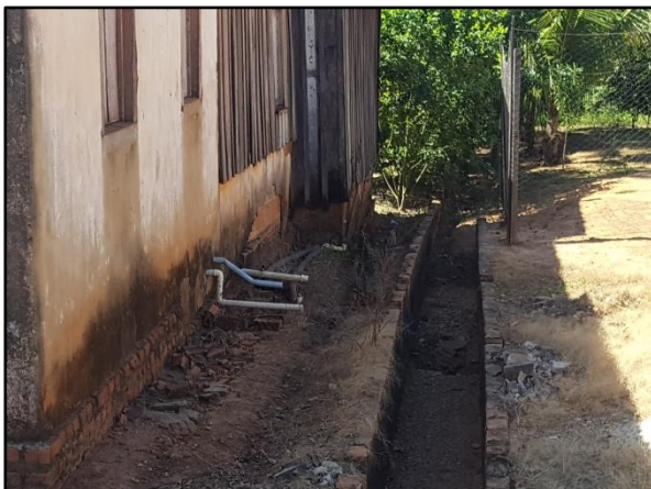
Figura 34. Lançamento de águas servidas no canal de drenagem de uma residência localizado na Av. Mato Grosso
