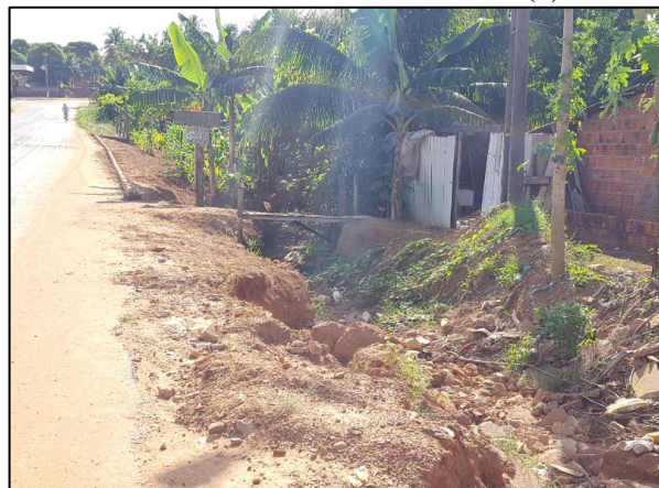
Figura 52. Processo erosivo na intersecção da Av. Curitiba com a Av. das Acácias (1)
