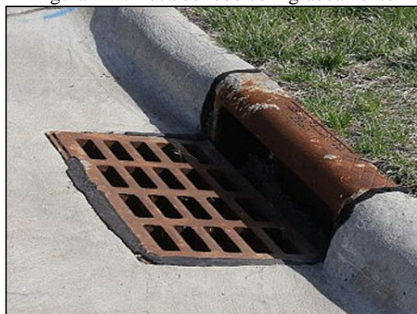
Figura 121. Boca de lobo com gradeamento
