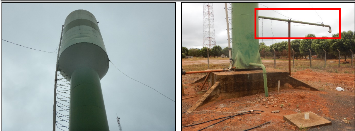
Figura 74. (A) Reservatório elevado de 45 m 3 (B) Ponto de tomada d' água
