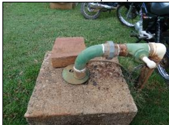
Figura 14. Detalhes do PT 04: Prefeitura, que não possui sistema de cloração
