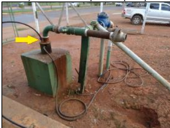
Figura 15. Dispositivo de cloração do PT 01: Hospital, composto por bomba dosadora de pastilha
