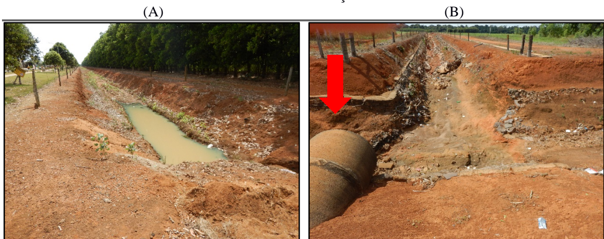
Figura 32. (A) Bacia de contenção localizada na rua Sucupira (B) Tubulação de concreto chegando na bacia de contenção
