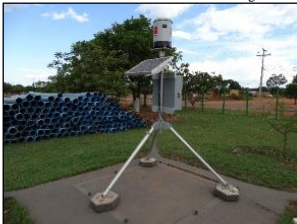
Figura 25. Estação Pluviométrica e detalhe da área de armazenagem de equipamentos ao fundo
