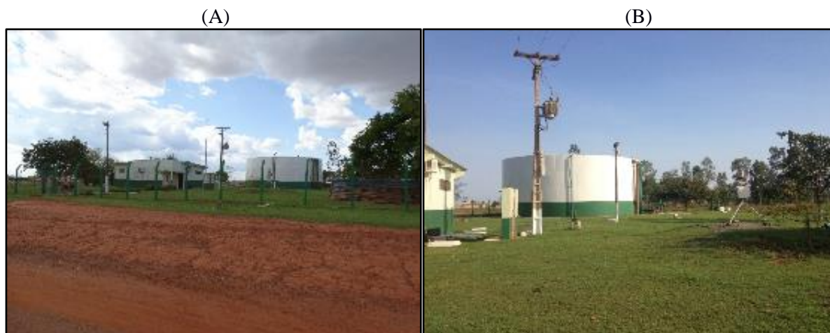
Figura 17. Vista geral da Estação de Tratamento de Água (A) Vista da parte externa (B) Vista da parte interna
