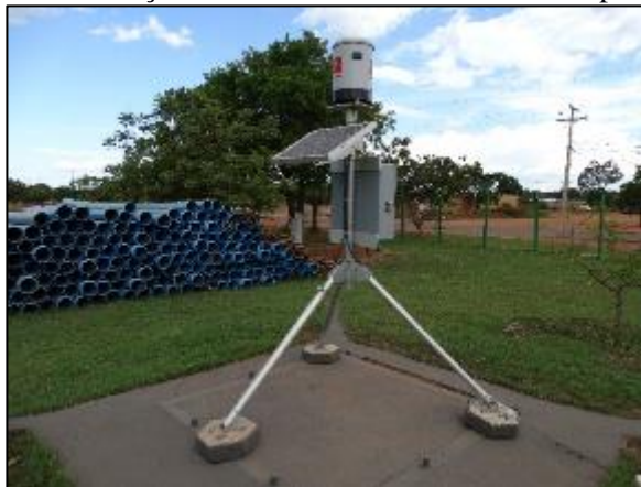
Figura 47. Estação Pluviométrica recentemente implantada
