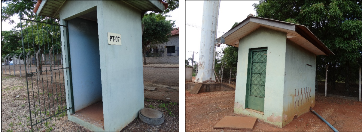
Figura 10. Abrigo do quadro de comando do (A) PT-07 (B) PT-09 (A) (B)
