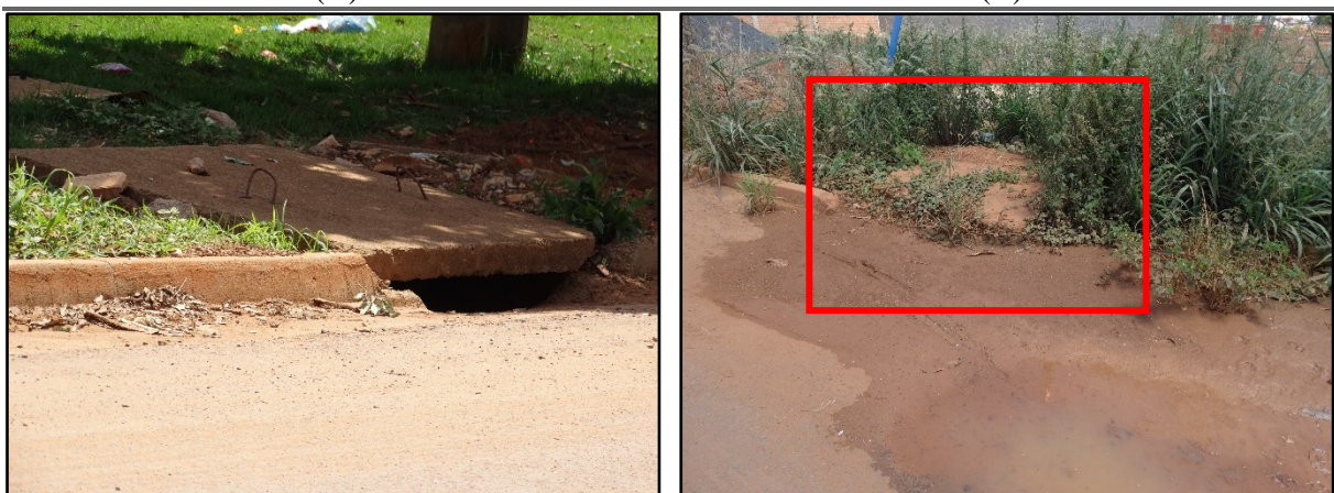
Figura 46. (A) Boca de lobo em bom estado de conversação (B) Boca de lobo obstruída
